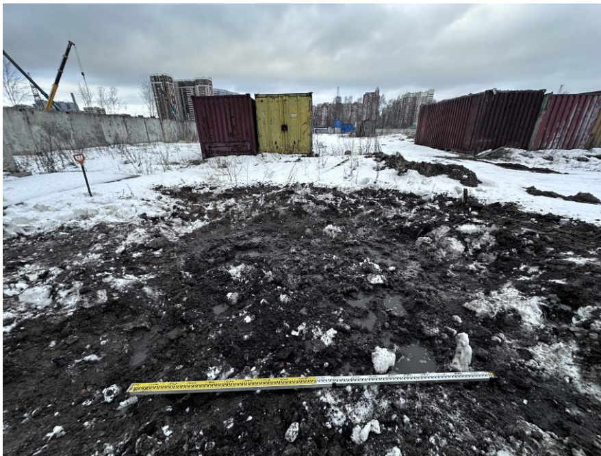
Илл. 46. Санкт-Петербург, Кондратьевский пр. Участок КН 78:10:0005171:3432. Шурф 3 после засыпки. Вид с юга.
