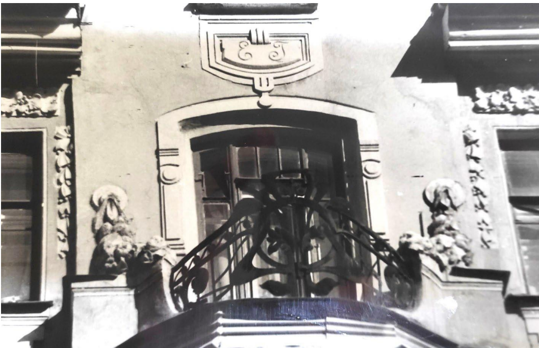
39. Декоративное оформление балкона над эркером на уровне 4-го этажа. Фотография. 1990 г. Институт «ЛенжилНИИпроект». Сектор хранения документированной информации Управления организационного обеспечения и контроля КГИОП.
