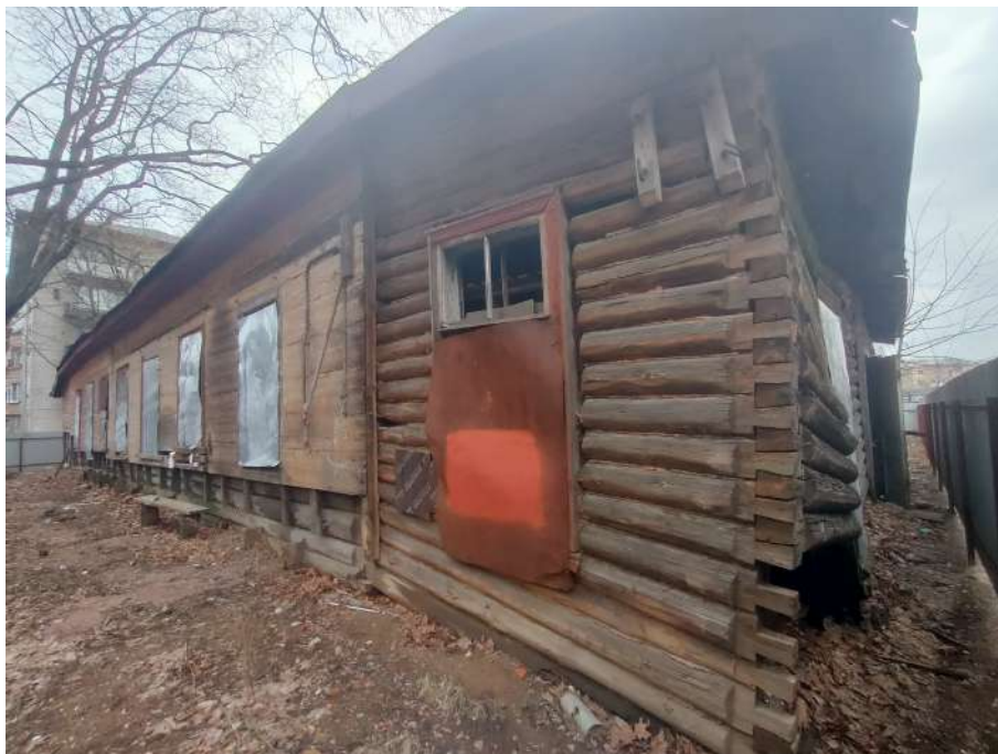
Фото №7. Фрагмент западного фасада здания, вид в направлении с юго-запада на северо-восток.
