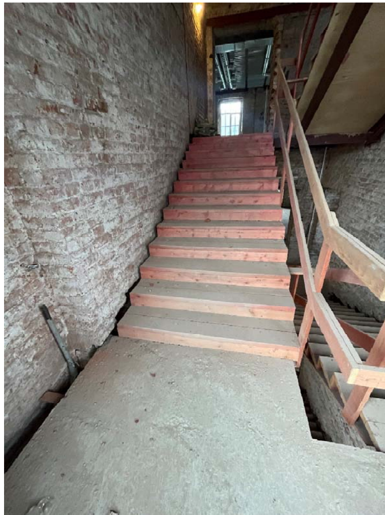
Фото №13. ЛК1, площадка между 2-ым и 3-им этажом, вид на площадку 3-го этажа.
