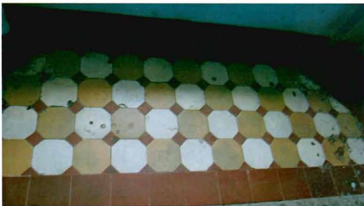
14. Внутренняя планировочная структура объекта культурного наследия. Метлахская плитка в покрытии пола лестничных площадок.
