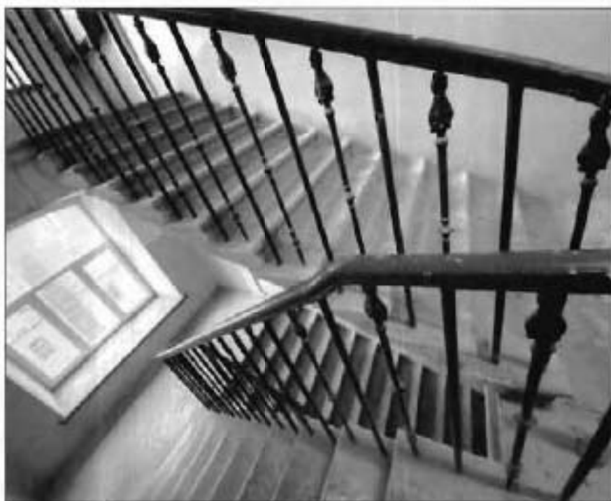
37. Двухмаршевые служебные лестницы (ИЛК). Сколы ступеней, истертости в ходовых местах, утраты металлических стоек ограждений. Фото от 16.11.2021 г.
