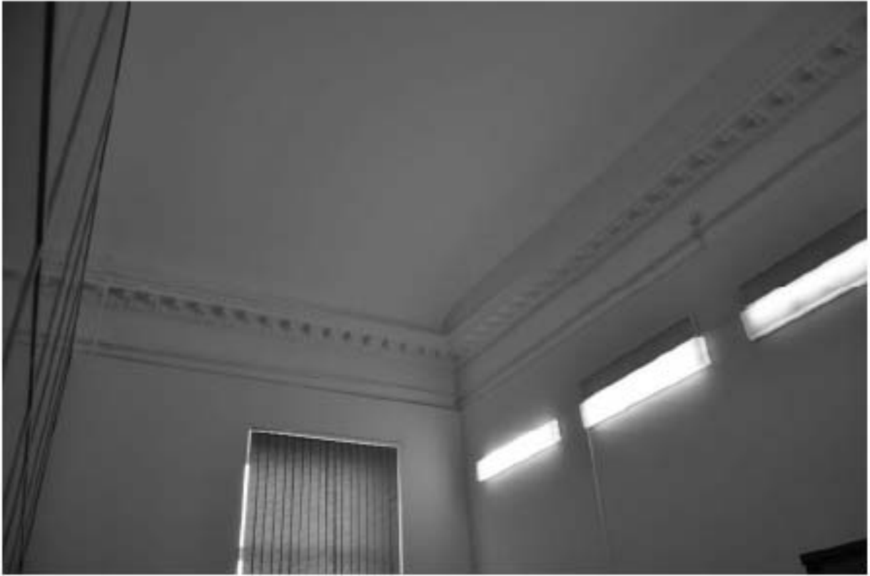
Фото 11. 3 этаж, пом. 28-Н (42), под пом. 38-Н (28).
