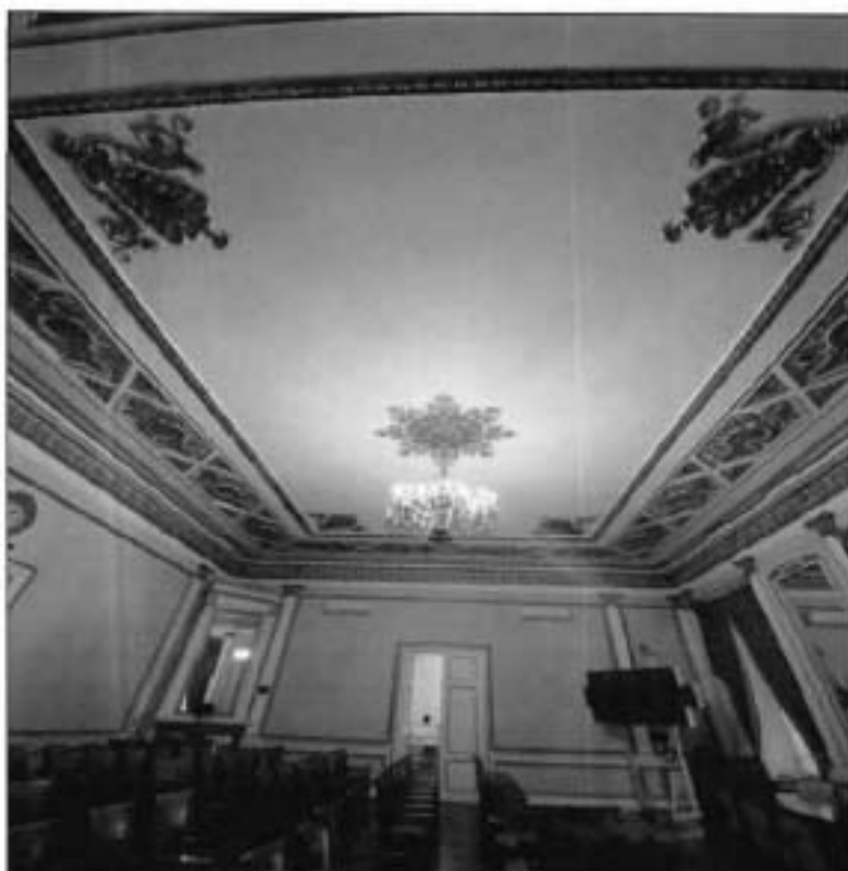
47. Декоративно художественная отделка помещений в уровне 3-го этажа (пом 27-Н (6)). Живописный плафон. Фото от 16.11.2021 г.
