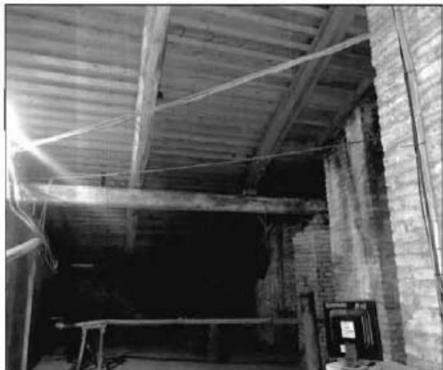
22. Стропильная система лицевого корпуса (со стороны пл. Ломоносова и ул. Зодчего Росси). Фото от 16.11.2021 г.
