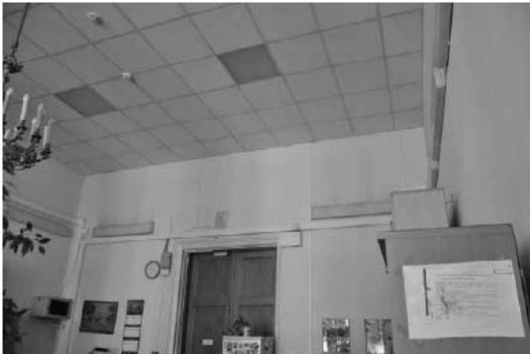
Фото 5. 3 этаж, пом. 28-Н (39), под пом. 38-Н (17).
