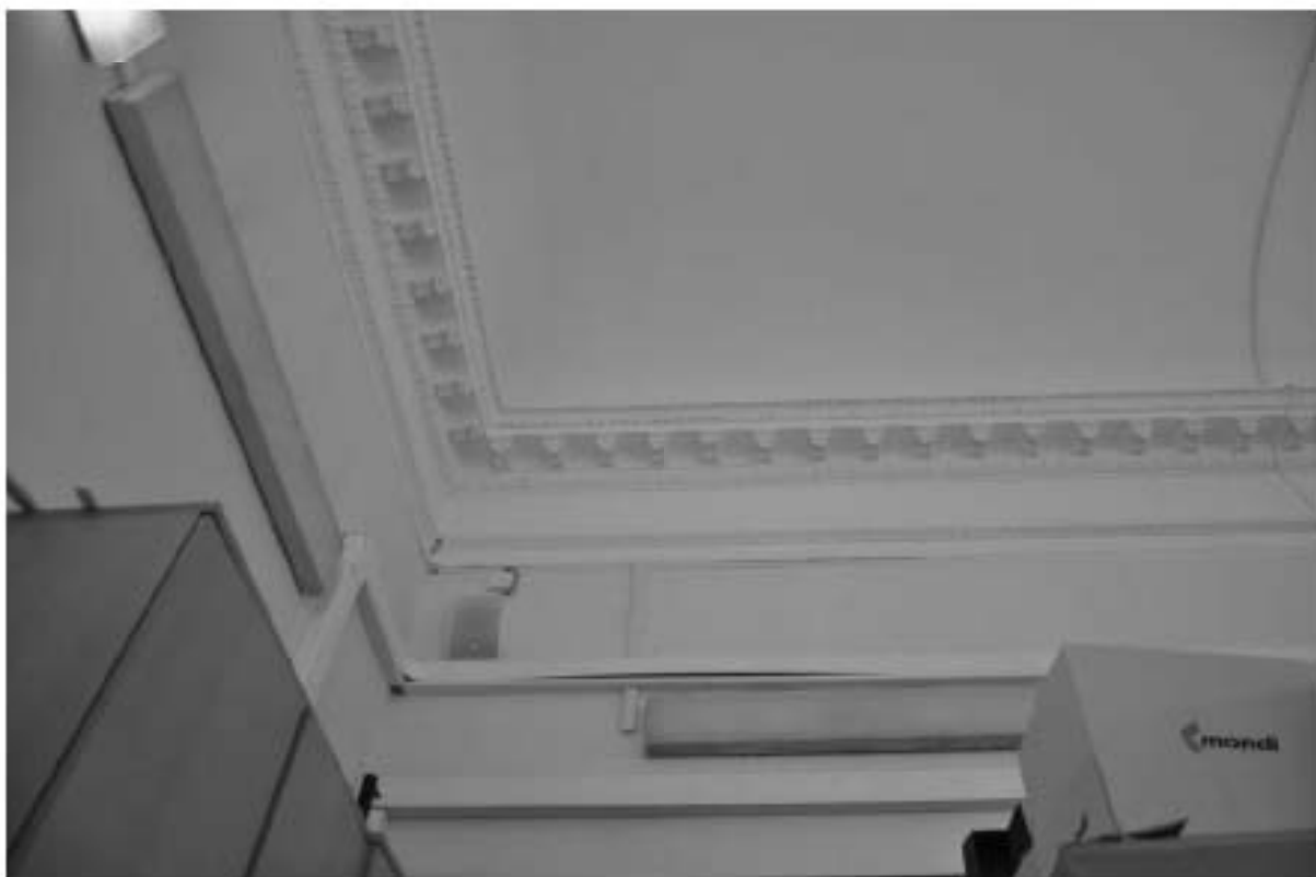
Фото 10. 3 этаж, пом. 28-Н (38), под пом. 38-Н (31).
