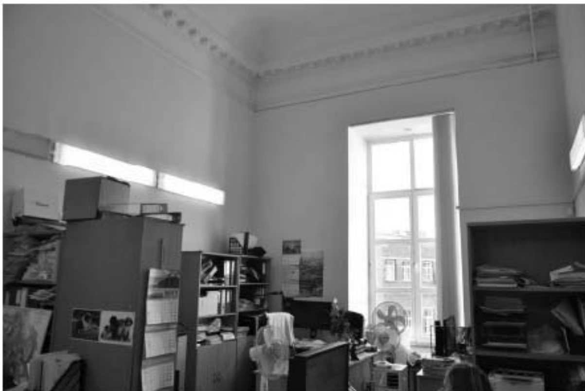
Фото 9. 3 этаж, пом. 28-Н (37), под пом. 38-Н (33).
