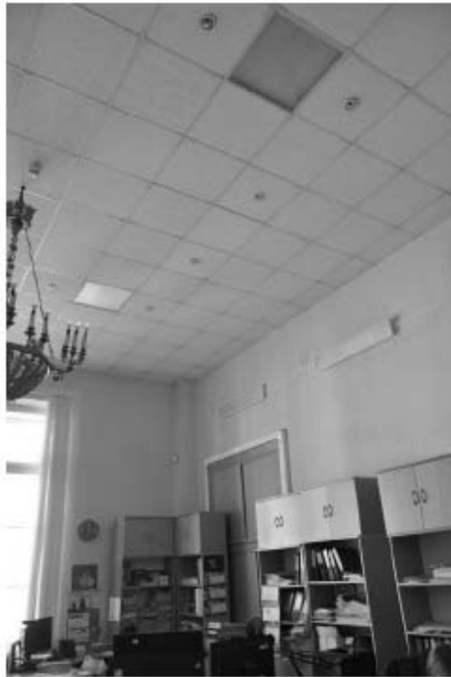
Фото 3. 3 этаж, пом. 28-Н (32), под пом. 38-Н (16).
