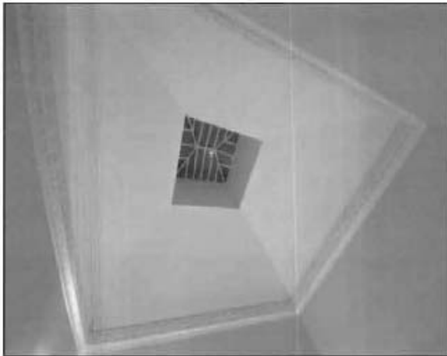
33. Прямоугольный в плане световой фонарь над четырехмаршевой железной лестницей (12ЛК) в пом. 39-Н (50). Фото от 16.11.2021 г.
