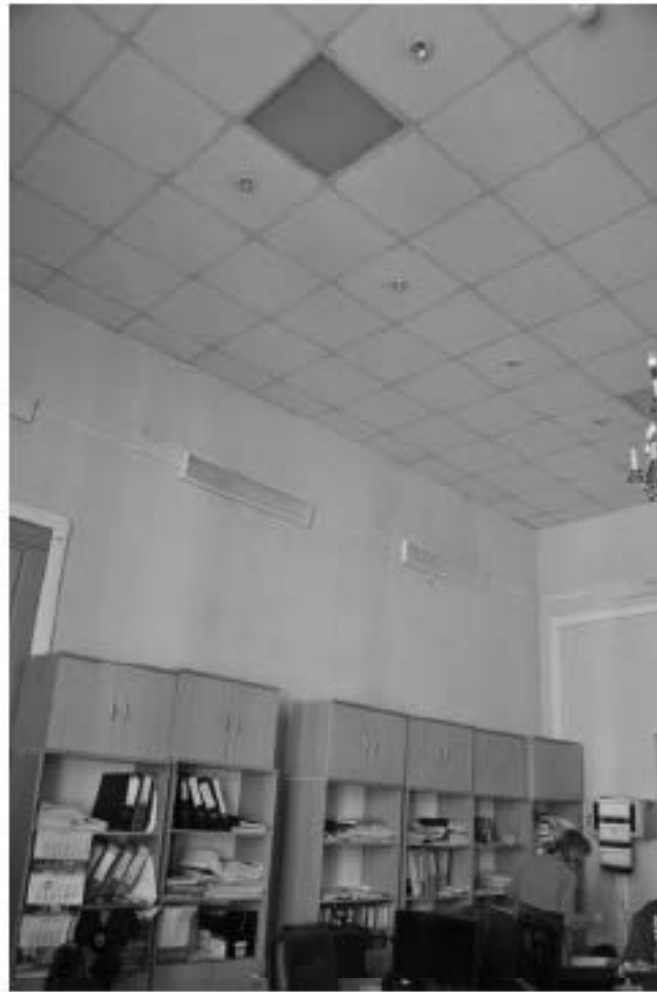
Фото 4. 3 этаж, пом. 28-Н (32), под пом. 38-Н (16).
