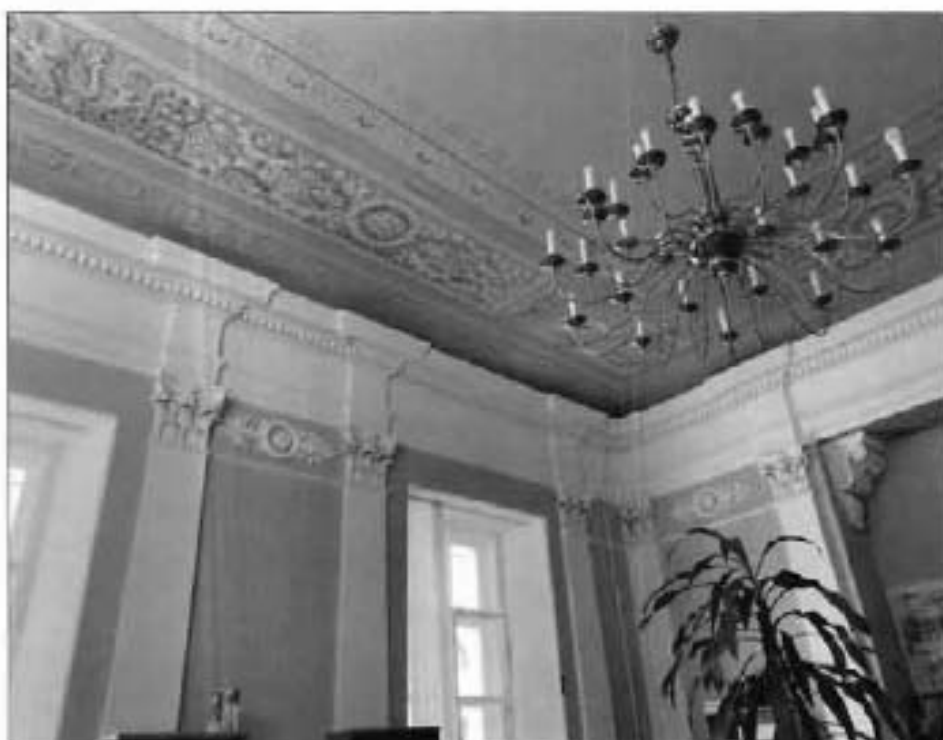
44. Декоративно художественная отделка помещений в уровне 3-го этажа (пом. 27-Н (10)). Фото от 19.11.2021 г.
