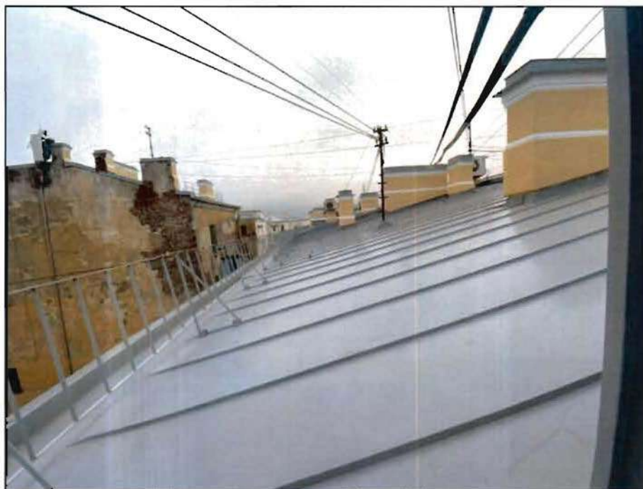
23. Металлическая кровля лицевого корпуса (со стороны пл. Ломоносова и ул. Зодчего Росси). Фото от 16.11.2021 г.
