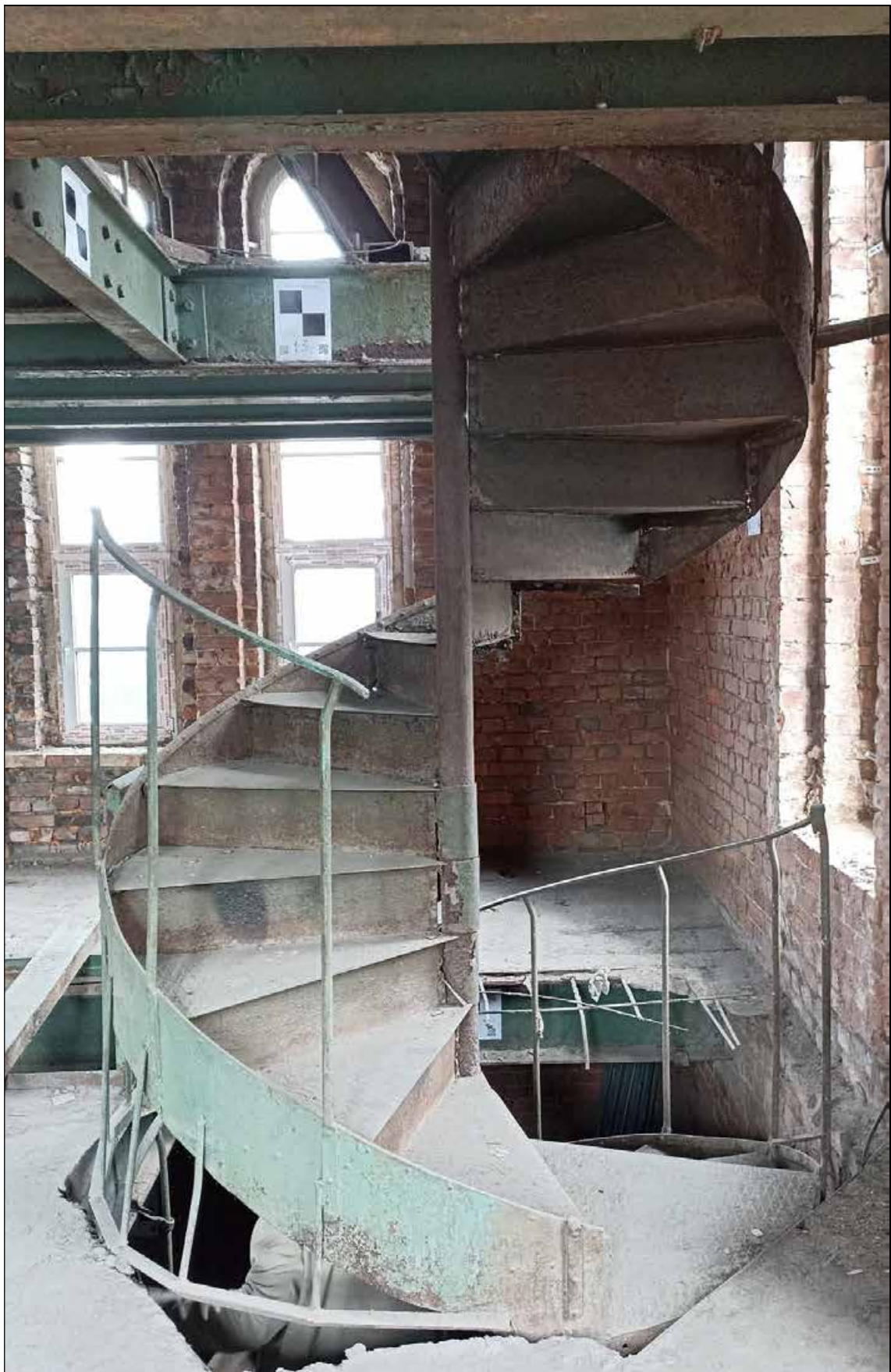
10. Выявленный объект культурного наследия «Фильтрационное отделение с ректификационной башней» в составе выявленного объекта культурного наследия «Казенный очистной винный склад № 4». Северо-восточная часть ректификационной башни в уровне чердачного помещения. Металлическая винтовая лестница. 06.10.2023 г.
