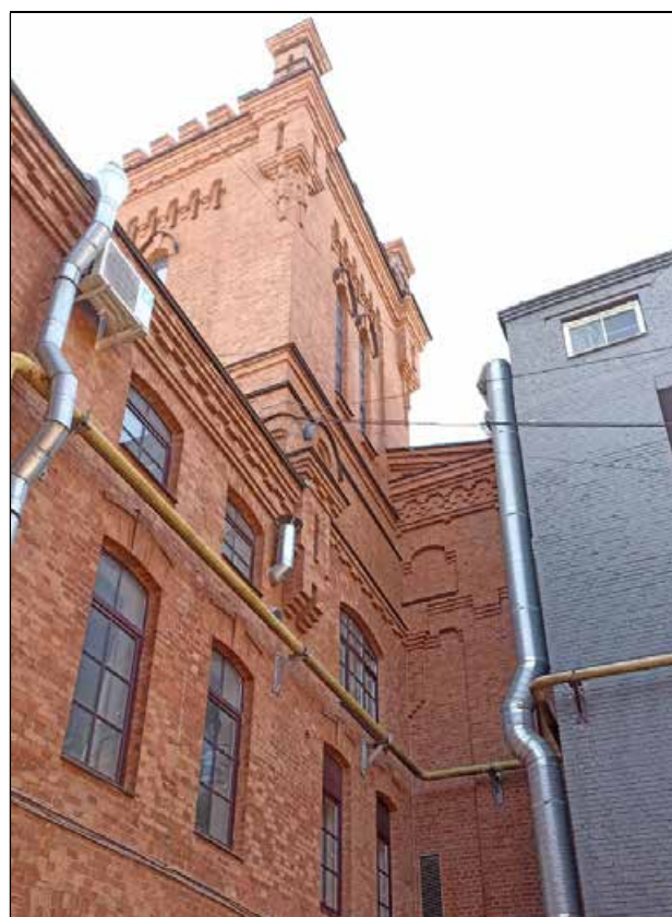
8. Выявленный объект культурного наследия «Фильтрационное отделение с ректификационной башней» в составе выявленного объекта культурного наследия «Казенный очистной винный склад № 4». Фрагмент северного фасада. 06.10.2023 г.
