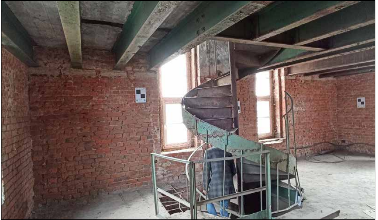
11. Выявленный объект культурного наследия «Фильтрационное отделение с ректификационной башней» в составе выявленного объекта культурного наследия «Казенный очистной винный склад № 4». Восточная часть ректификационной башни в уровне чердачного помещения. 06.10.2023 г.
