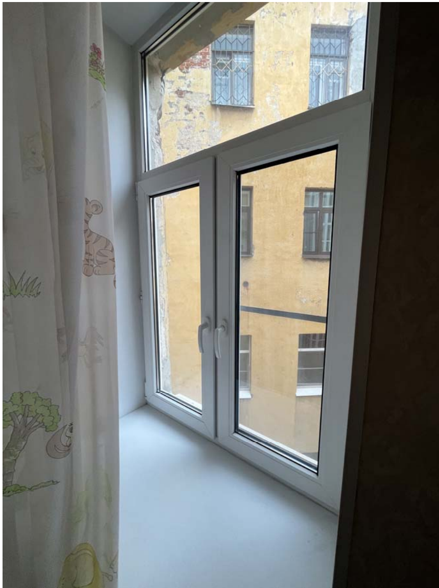
Фото №5. Квартира №30, помещение №5, оконное заполнение.
