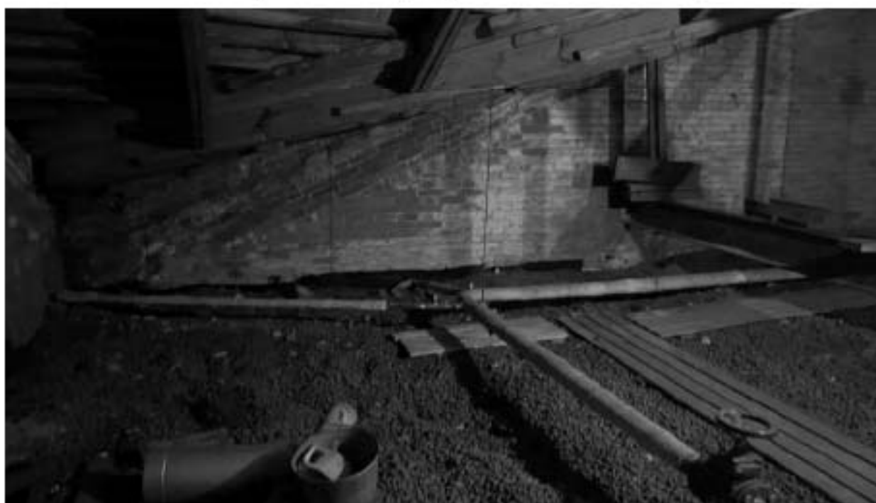
2. Фрагмент интерьера технического этажа;
