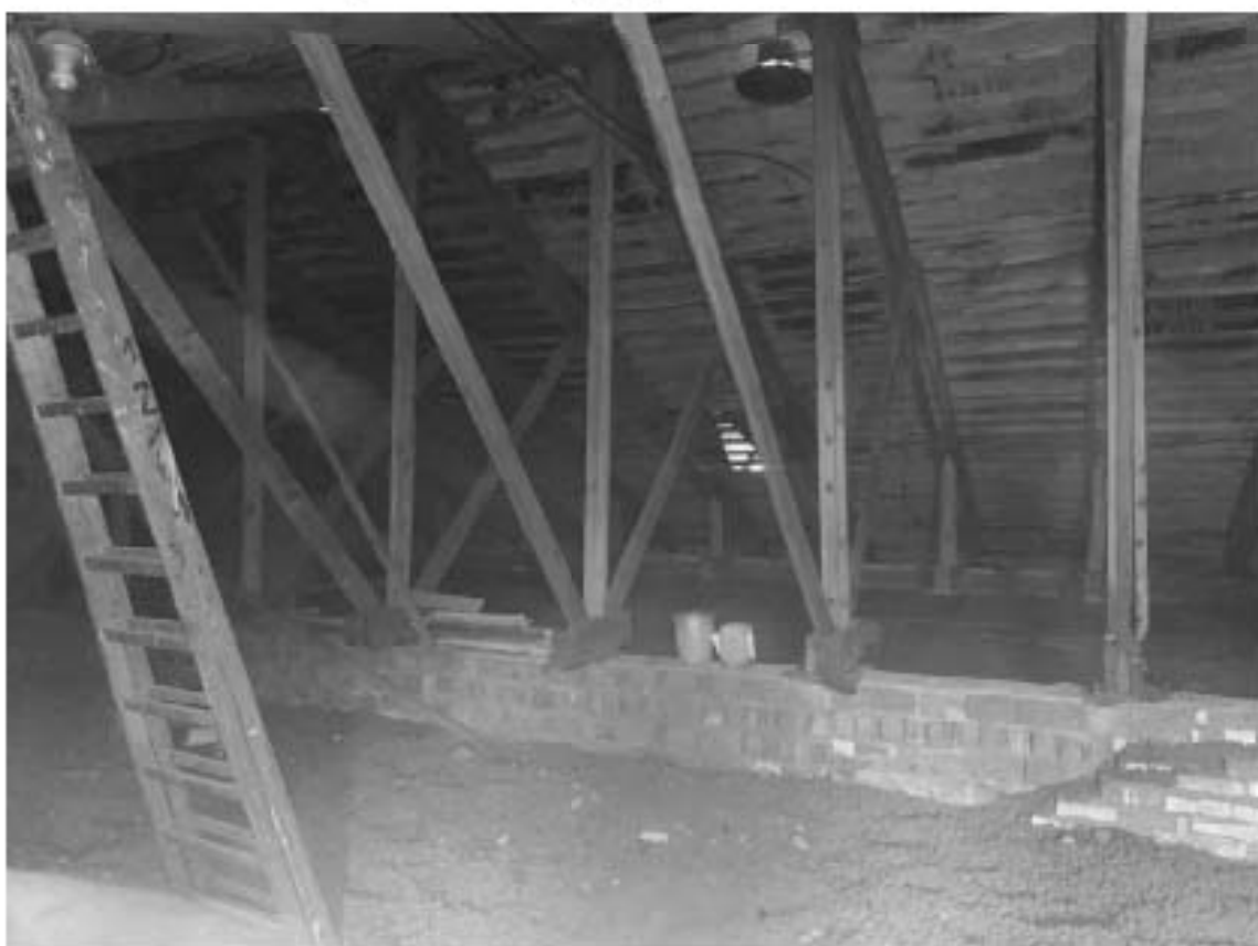
4. Фрагмент интерьера технического этажа;
