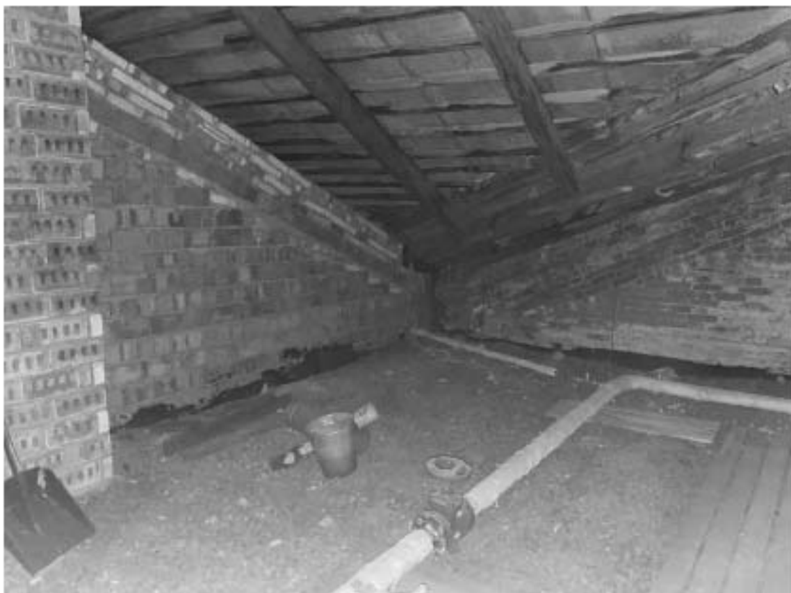
3. Фрагмент интерьера технического этажа;
