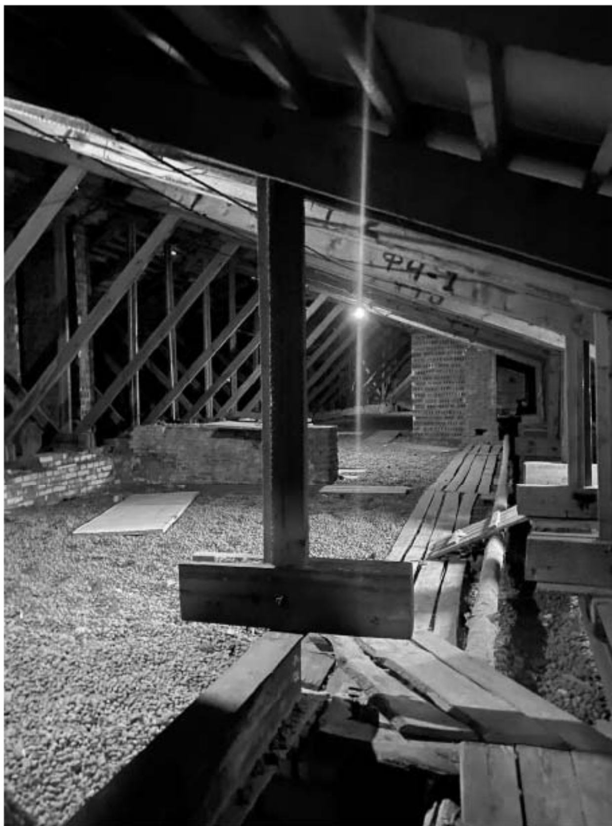
7. Фрагмент интерьера технического этажа;
