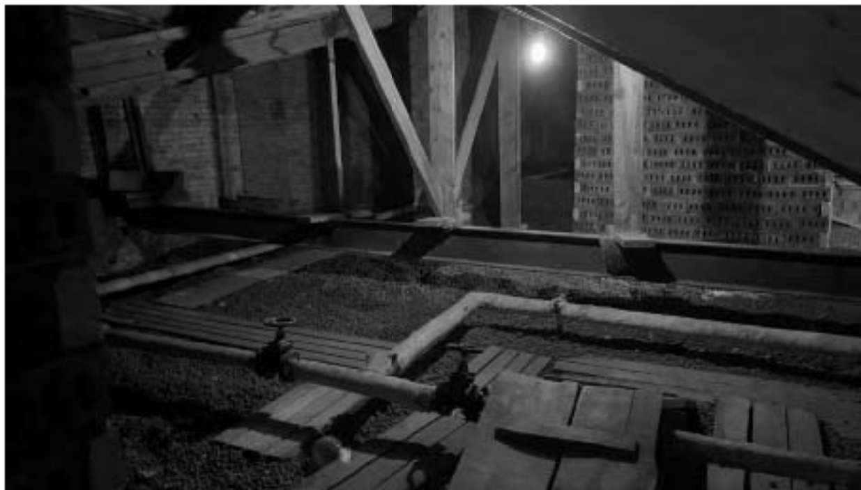
1. Фрагмент интерьера технического этажа;
