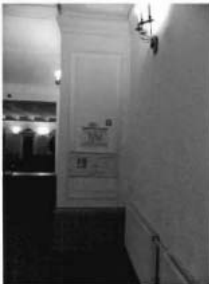
6. Штукатурные зеркала в лепных рамах с прорезкой растительного орнамента на пилонах парадной лестницы.
