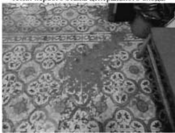
11. Деструкция глазурованного покрытия метлахской плитки в вестибюле парадного входа
