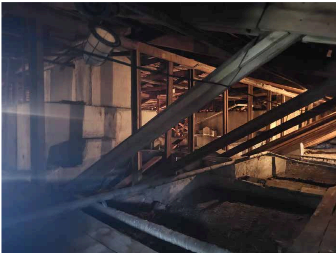
Фото 8.Объект культурного наследия регионального значения «Солдатская казарма» (г. Санкт-Петербург, Загородный пр., д. 48 лит. А), входящий в состав объекта культурного наследия регионального значения «Комплекс казарм Семеновского и Егерского полков». Чердак.
