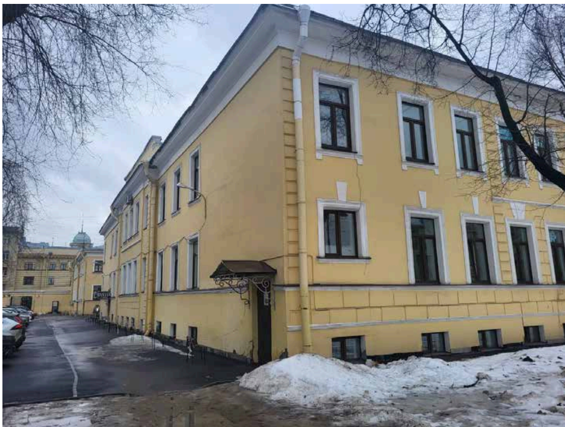
Фото 5. Объект культурного наследия регионального значения «Солдатская казарма» (г. Санкт-Петербург, Загородный пр., д. 48 лит. А), входящий в состав объекта культурного наследия регионального значения «Комплекс казарм Семеновского и Егерского полков». Боковой и дворовый фасады.
