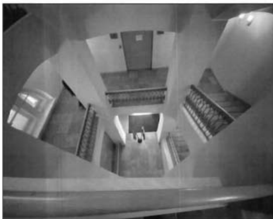
29. Парадная лестница (3ЛК) со стороны пл. Ломоносова, многомаршевая, на пилонах по ползучим с распалубками и крестовым сводам на подпружных арках. Фото от 16.11.2021 г.
