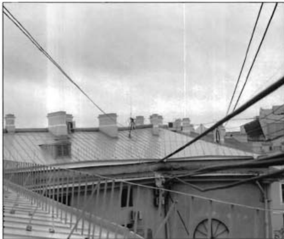
24. Металлическая кровля лицевого корпуса (со стороны пл. Ломоносова и ул. Зодчего Росси). Фото от 16.11.2021 г.
