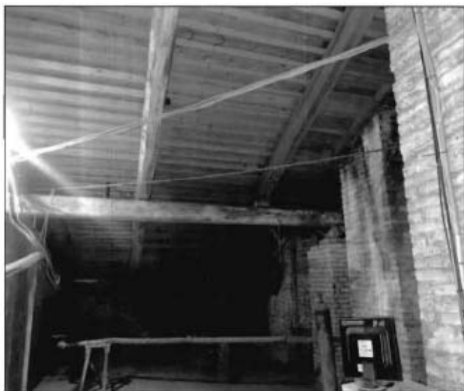
22. Стропильная система лицевого корпуса (со стороны пл. Ломоносова и ул. Зодчего Росси). Фото от 16.11.2021 г.
