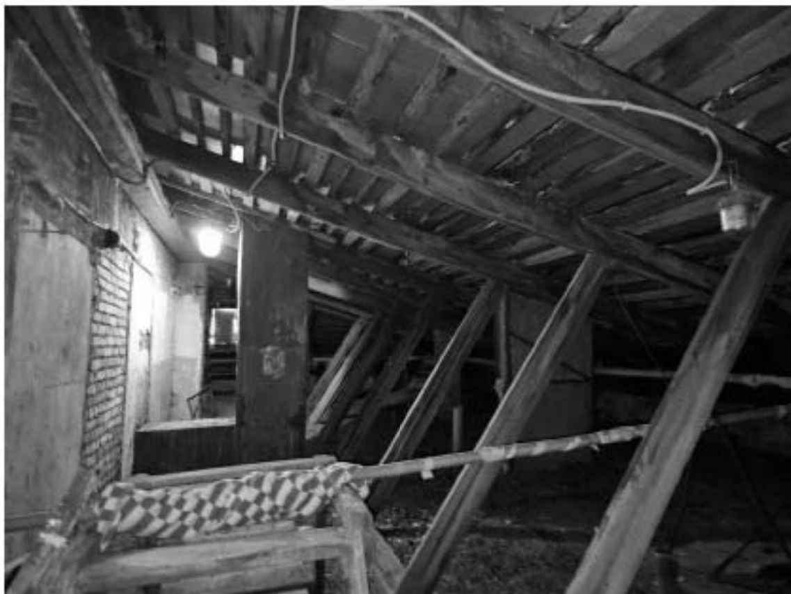
56. Выявленный объект культурного наследия «Особняк», в составе выявленного объекта культурного наследия «Особняк В.Ф. Друри (со службами, садом, кирпичной оградой)», по адресу: г. Санкт-Петербург, ул. Степана Разина, д. 86/231, лит. А. Общий вид стропильной системы крыши.
