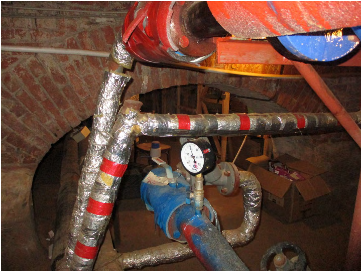
19. Объект культурного наследия регионального значения «Дом В.П. Осетрова» по адресу: г. Санкт-Петербург, ул. Вакуленчука, дом 4, литера А. Проход теплосети в подвале.
