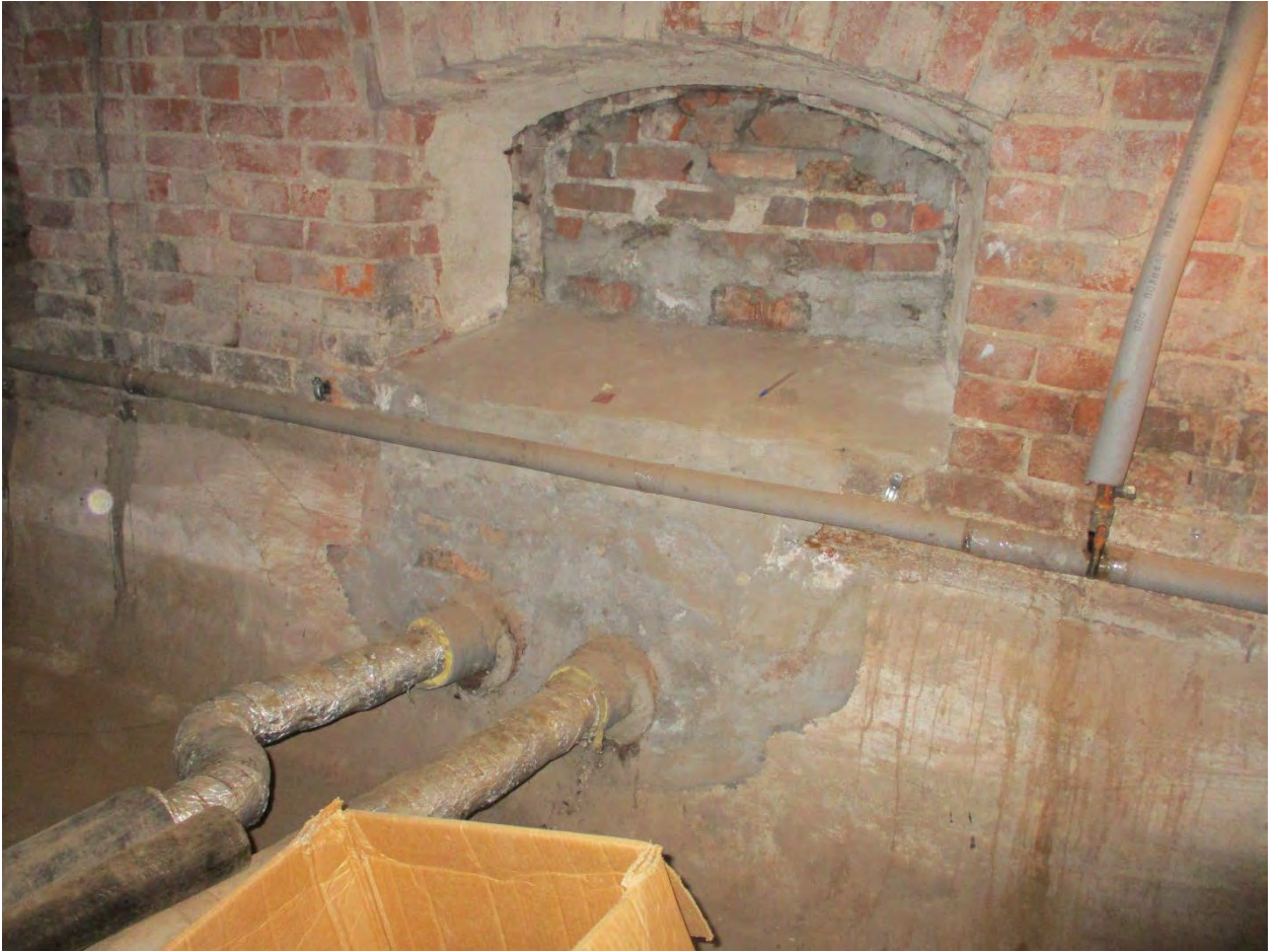
12. Объект культурного наследия регионального значения «Дом В.П. Осетрова» по адресу: г. Санкт-Петербург, ул. Вакуленчука, дом 4, литера А. Ввод теплосети в здание.
