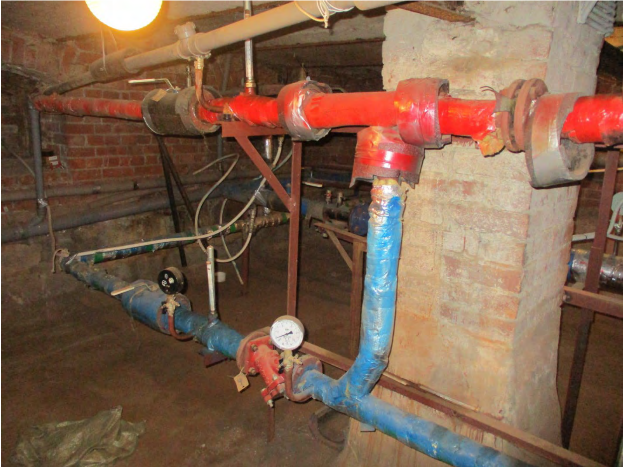
13. Объект культурного наследия регионального значения «Дом В.П. Осетрова» по адресу: г. Санкт-Петербург, ул. Вакуленчука, дом 4, литера А. Проход теплосети в подвале.
