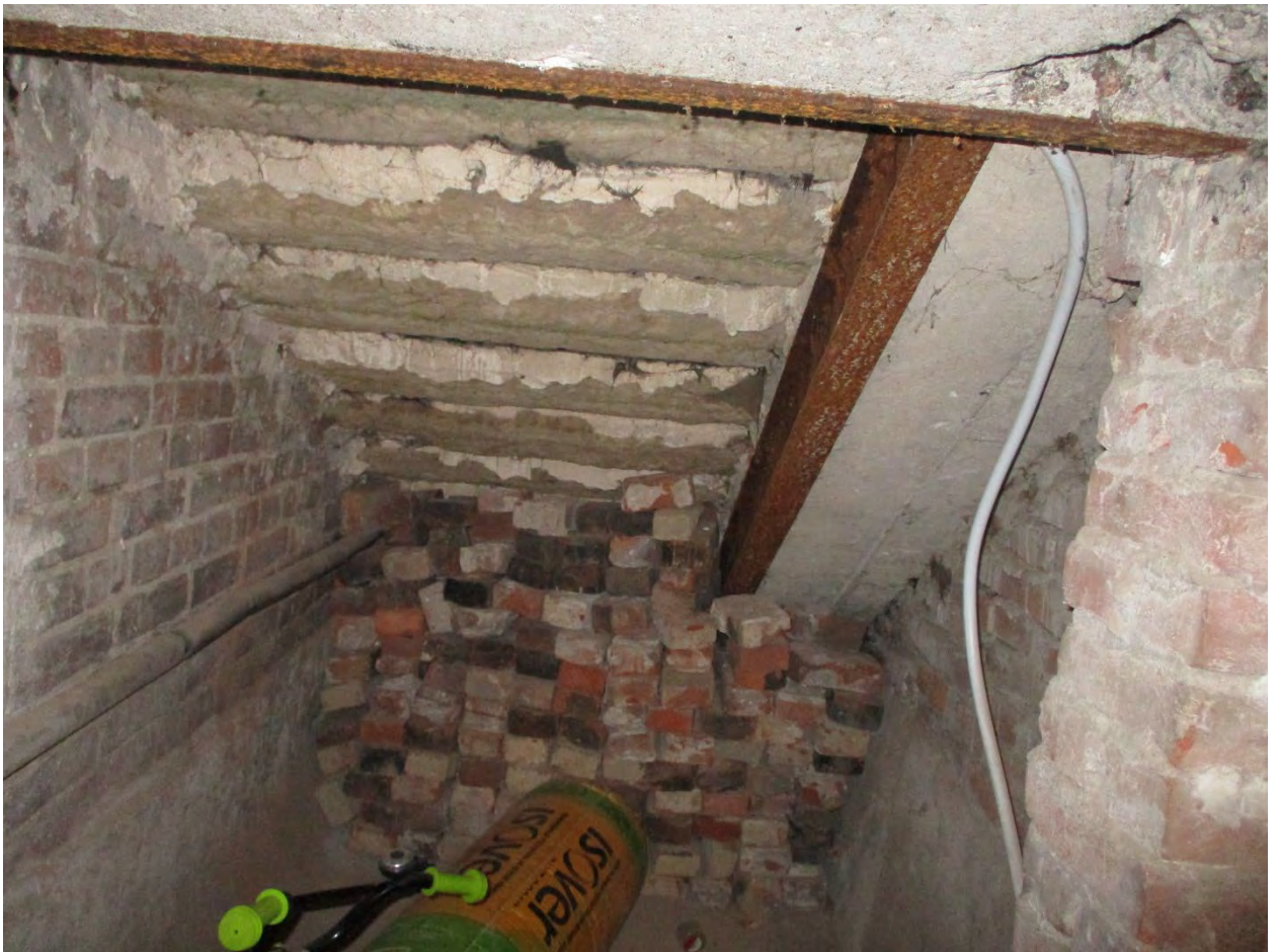
15. Объект культурного наследия регионального значения «Дом В.П. Осетрова» по адресу: г. Санкт-Петербург, ул. Вакуленчука, дом 4, литера А. Подлестничное пространство в подвале.
