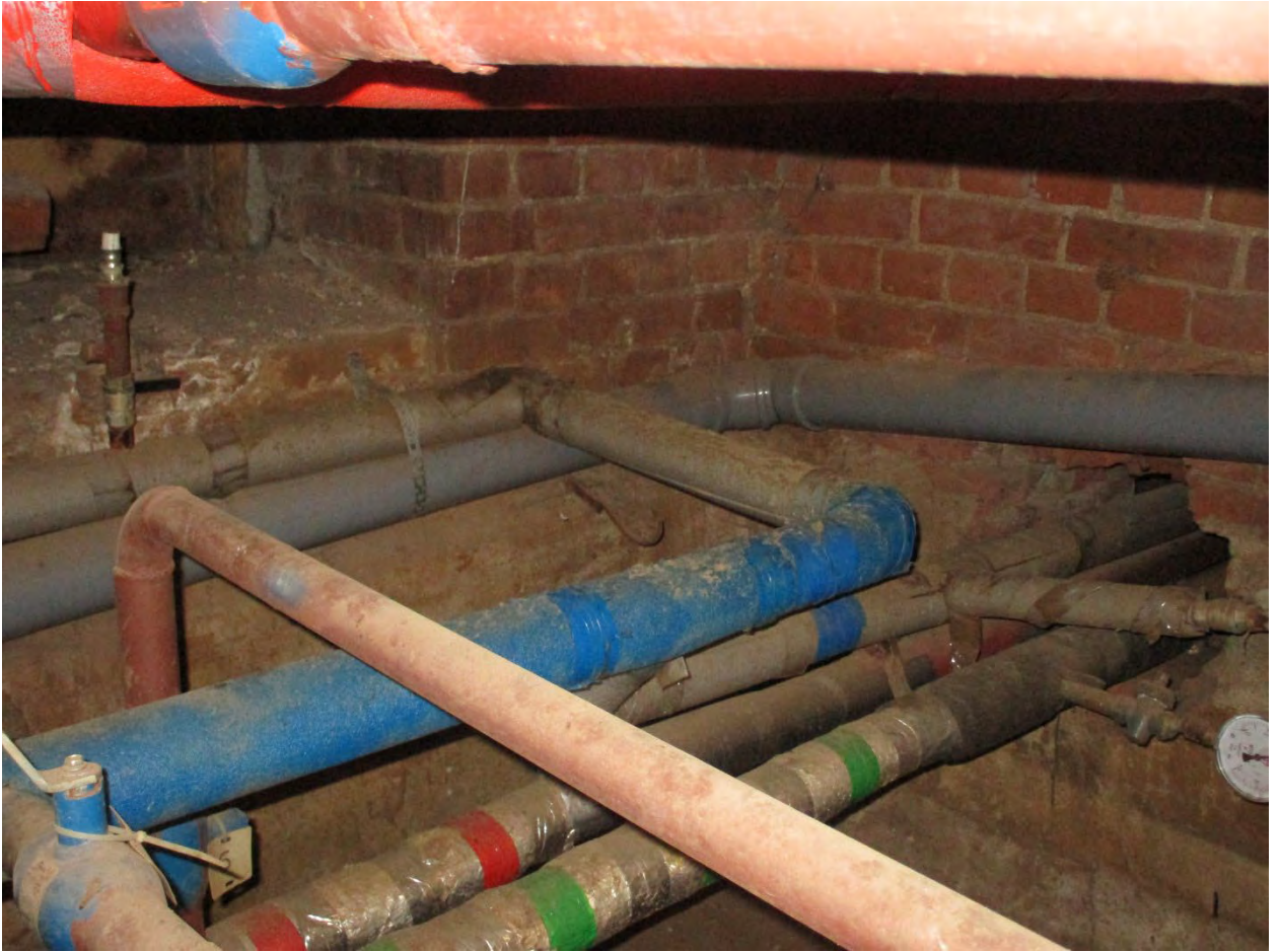
18. Объект культурного наследия регионального значения «Дом В.П. Осетрова» по адресу: г. Санкт-Петербург, ул. Вакуленчука, дом 4, литера А. Проход теплосети в подвале.
