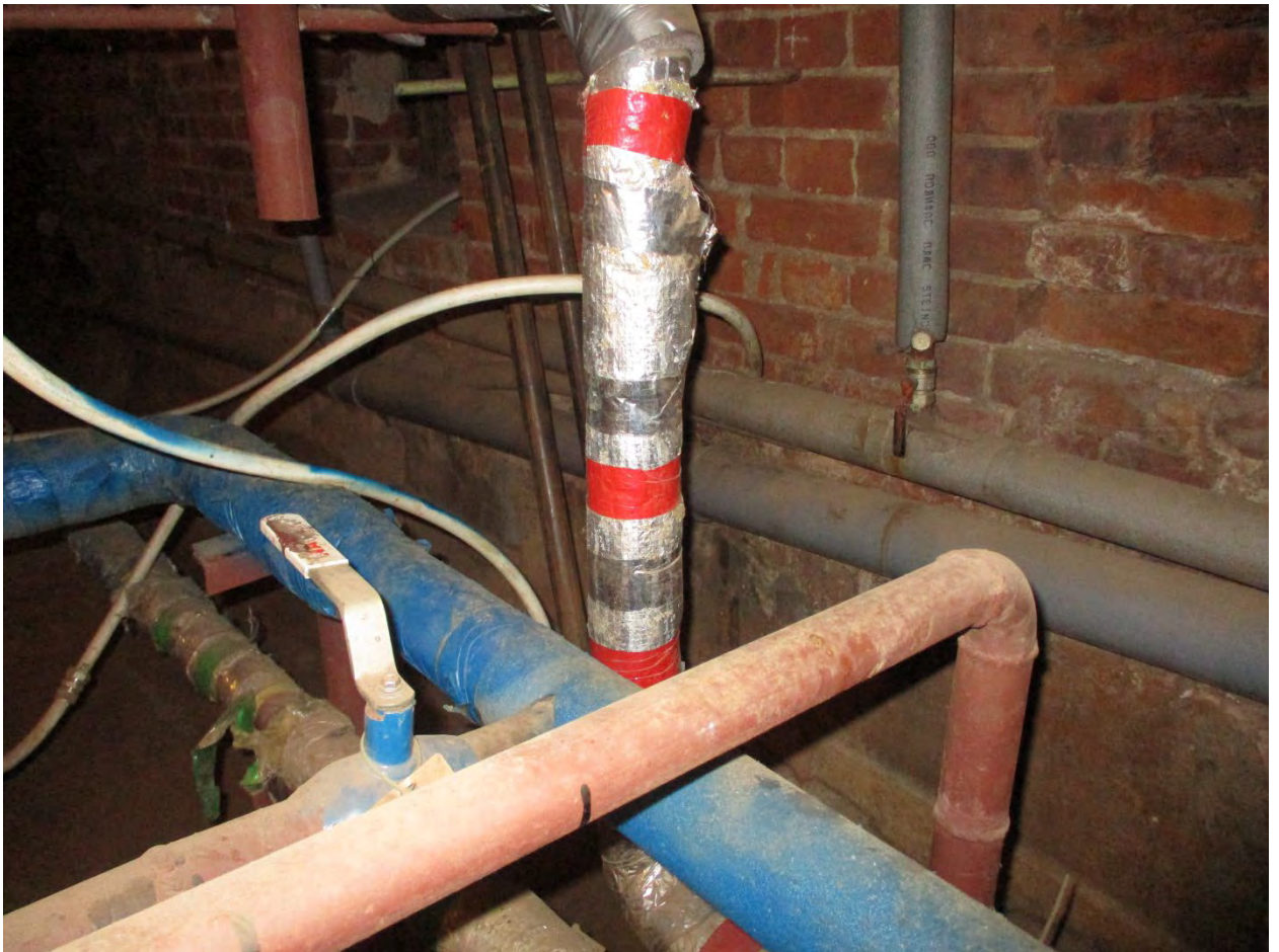
16. Объект культурного наследия регионального значения «Дом В.П. Осетрова» по адресу: г. Санкт-Петербург, ул. Вакуленчука, дом 4, литера А. Проход теплосети в подвале.
