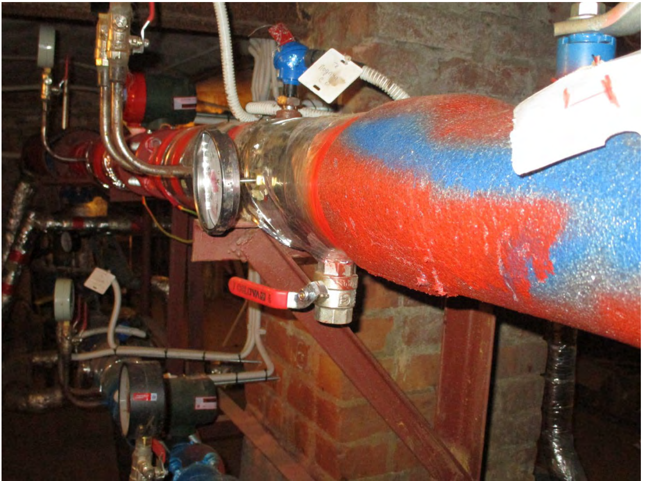
17. Объект культурного наследия регионального значения «Дом В.П. Осетрова» по адресу: г. Санкт-Петербург, ул. Вакуленчука, дом 4, литера А. Проход теплосети в подвале.
