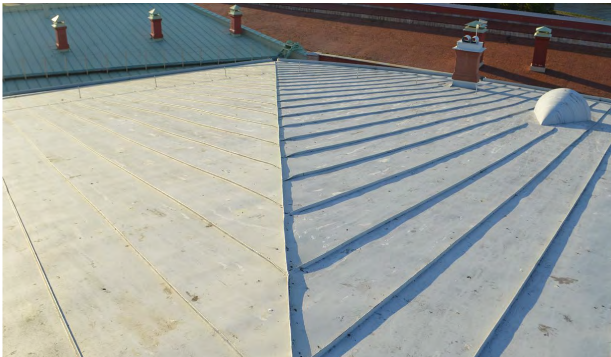
Фото 06. ОКН федерального значения «Кавальер Анны Иоанновны». Крыша. Фрагмент. Съёмка 24.07.2023 г.
