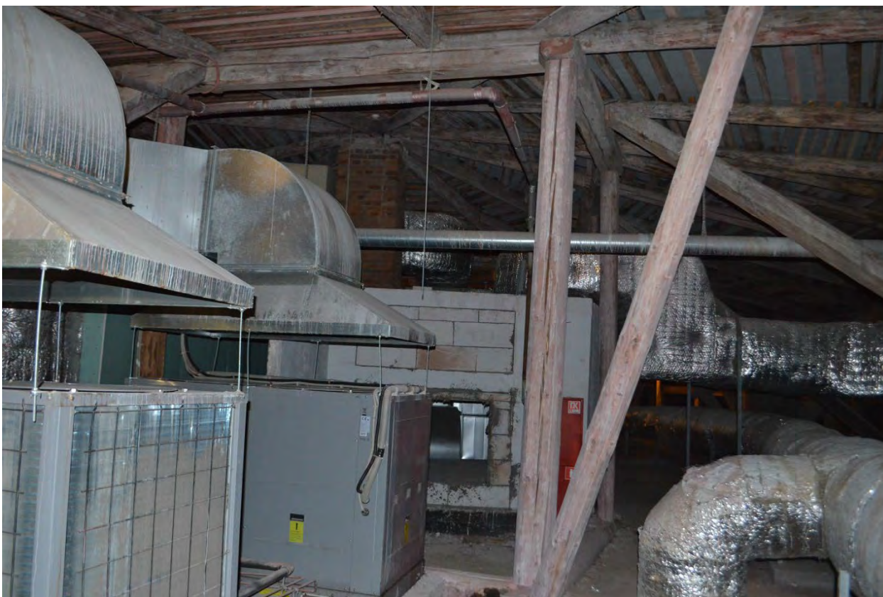
Фото 18. ОКН федерального значения «Кавальер Анны Иоанновны». Чердак. Стропильная система. Фрагмент. Съёмка 24.07.2023 г.
