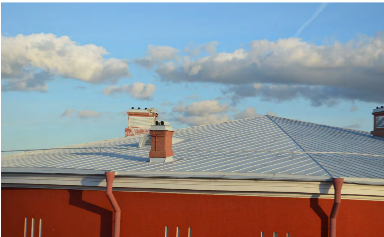
Фото 03. ОКН федерального значения «Кавальер Анны Иоанновны». Крыша. Фрагмент. Съёмка 24.07.2023 г.
