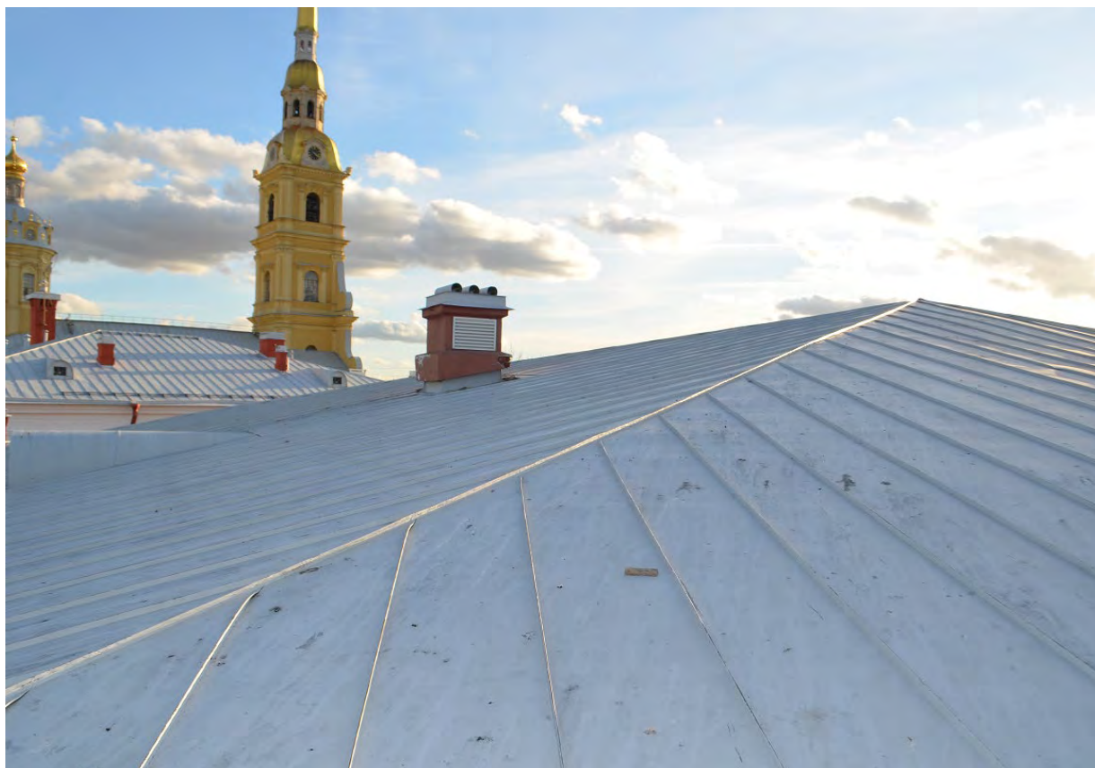
Фото 05. ОКН федерального значения «Кавальер Анны Иоанновны». Крыша. Фрагмент. Дымовые трубы. Съёмка 24.07.2023 г.
