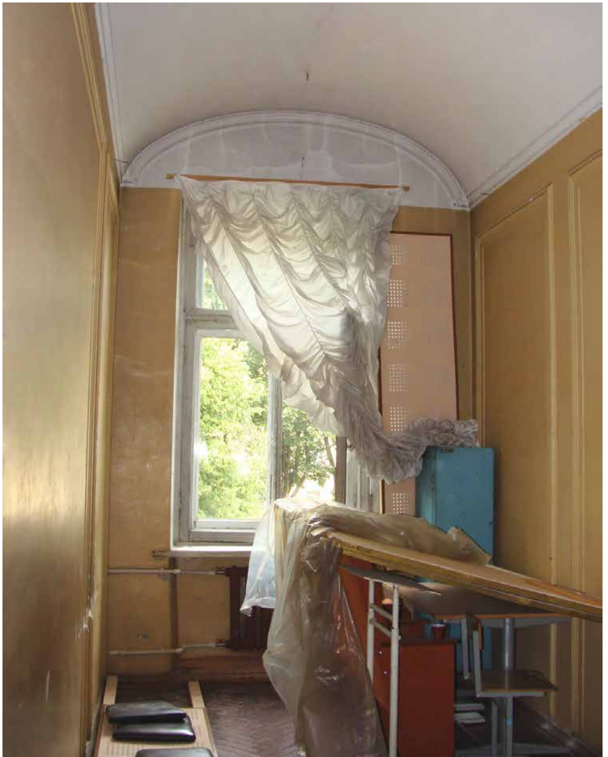
Ил. 248. Здание С.-Петербургской Консерватории им. Н. А. Римского-Корсакова. Класс в помещении П-26. /По проекту В. Николая здесь была устроена лестница/. Фото 2012 года.
