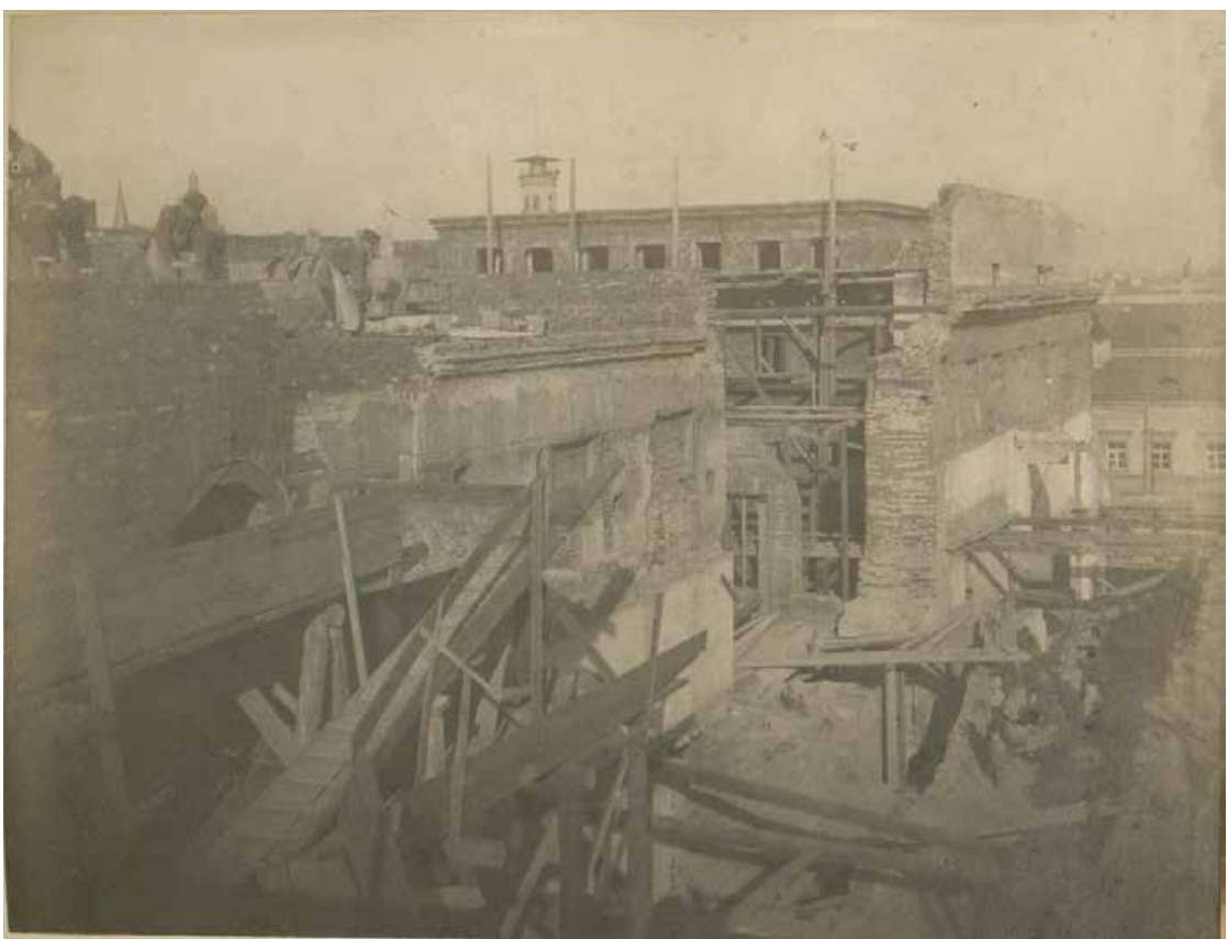
Ил. 110. Перестройка здания Большого театра под Консерваторию. Фото. 1891-1893 гг. РГИА. Ф.1293. Оп.167. Д.142. Л. 11. (Фото 20).
