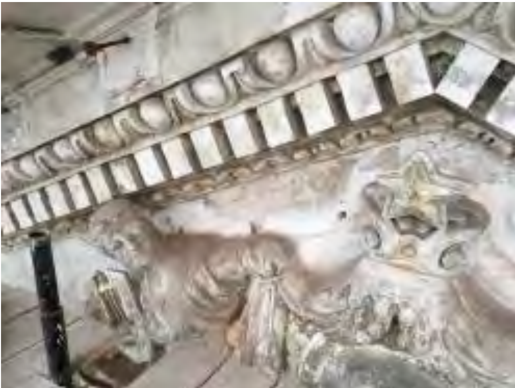
267. Фрагмент тимпана фронтона южного фасада. Фото 2019 г.
