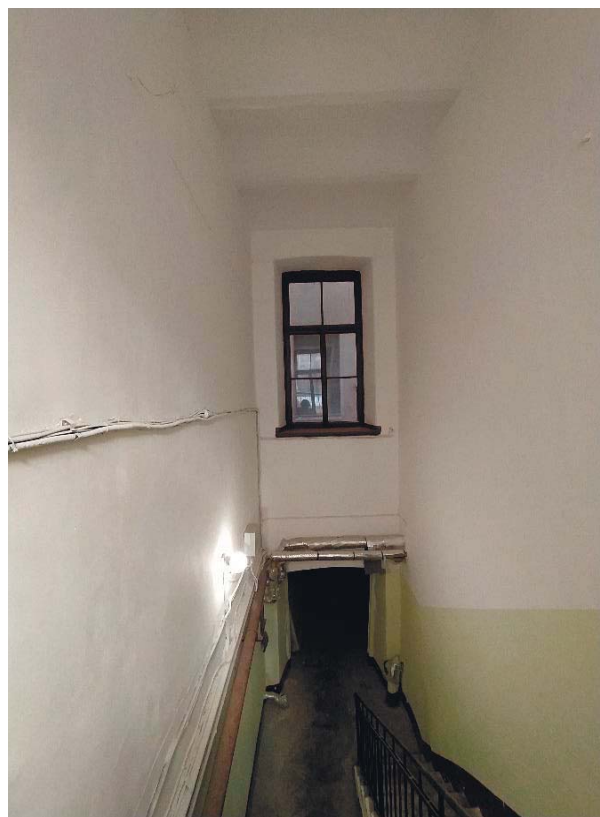
Фото 17. Лестничная клетка ЛК5 в уровне цокольного этажа. Перекрытия в виде сводов. Вид с северо-запада
