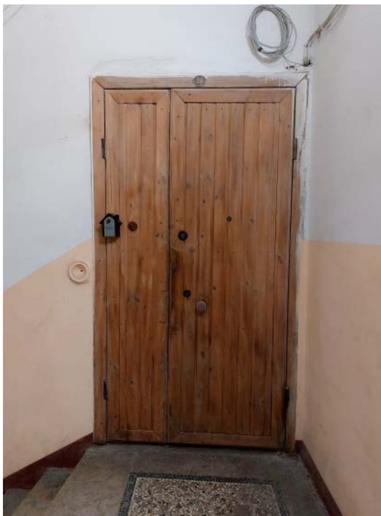
4. Входная дверь кв. №24 в уровне 2-го этажа объекта культурного наследия федерального значения «Дом, где жили: в 1877-1916 гг. - композитор Направник Э.Ф., в 1882-1908 гг. - композитор Стравинский И.Ф., в 1946-1982 гг. - геолог Наливкин Д.В.», расположенного по адресу: г. Санкт-Петербург, улица Глинки 3-5-7, литера А. 10.07.2022
