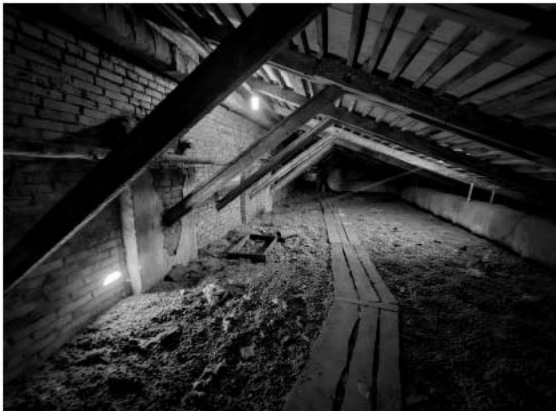
119. Выявленный объект культурного наследия «Особняк Е.А. Брюн», по адресу: г. Санкт-Петербург, Почтамтская ул., д. 19-21, лит. А. Фрагмент стропильной системы односкатной крыши северо-восточного дворового корпуса.
