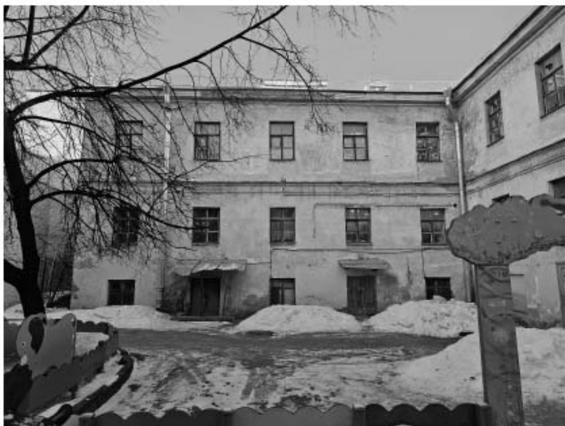
13. Общий вид юго-восточного дворового фасада северо-западного дворового корпуса выявленного объекта культурного наследия «Особняк Е.А. Брюн», по адресу: г. Санкт-Петербург, Почтамтская ул., д. 19-21, лит. А.
