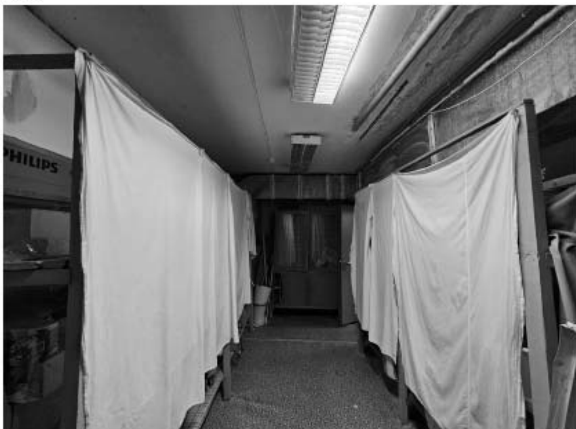
19. Выявленный объект культурного наследия «Особняк Е.А. Брюн», по адресу: г. Санкт-Петербург, Почтамтская ул., д. 19-21, лит. А. Общий вид пом. 2-Н (1) в уровне цокольного этажа.
