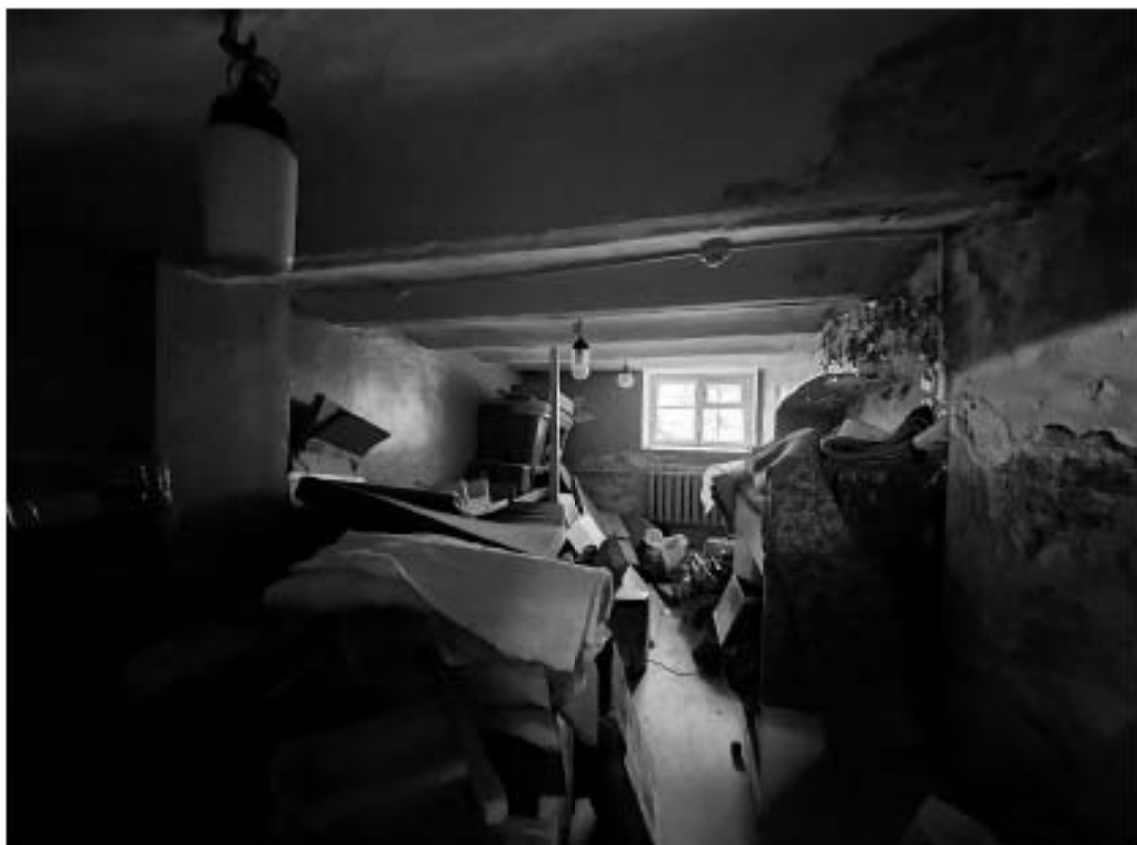
26. Выявленный объект культурного наследия «Особняк Е.А. Брюн», по адресу: г. Санкт-Петербург, Почтамтская ул., д. 19-21, лит. А. Общий вид пом. 1-Н (7) в уровне цокольного этажа.
