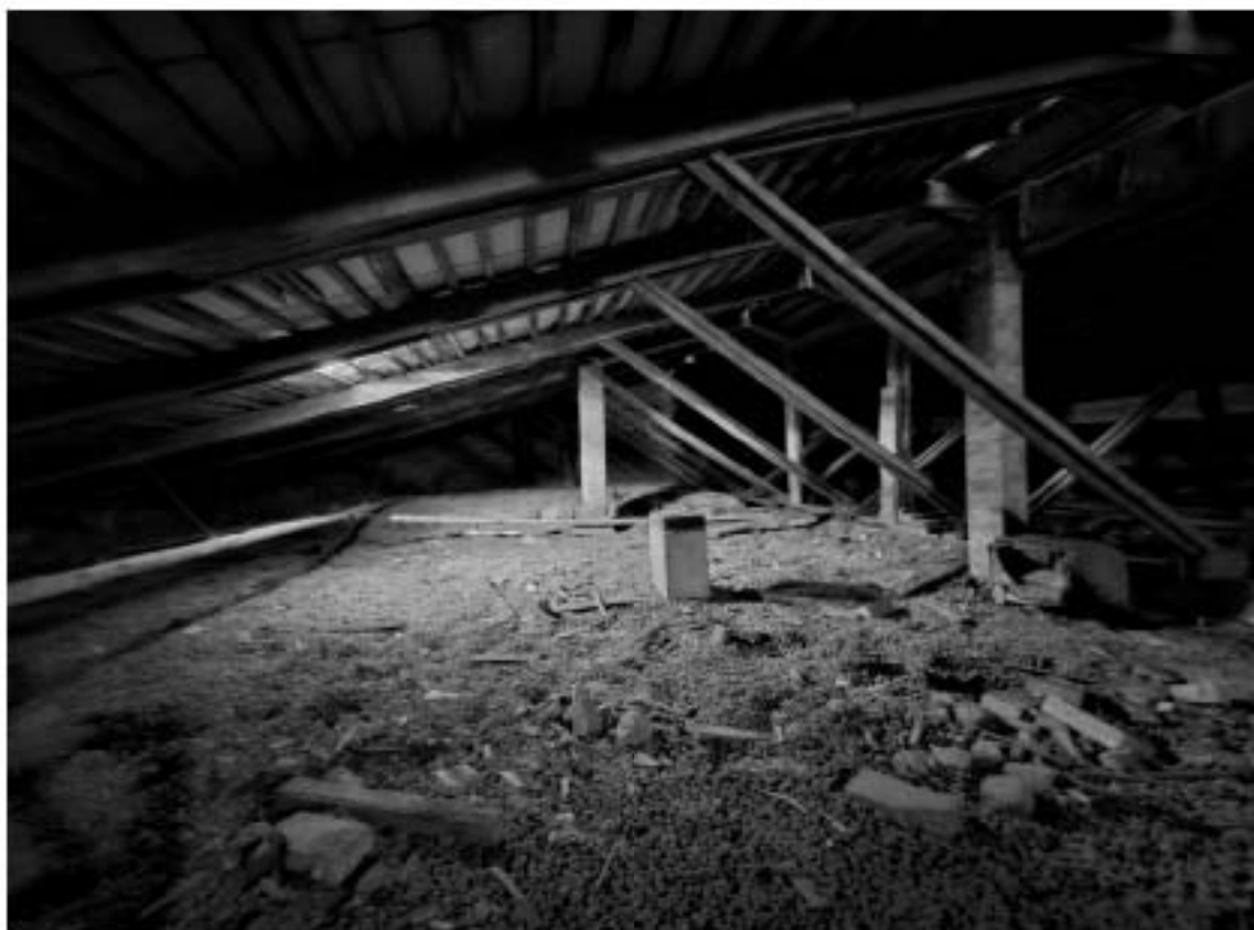
122. Выявленный объект культурного наследия «Особняк Е.А. Брюн», по адресу: г. Санкт-Петербург, Почтамтская ул., д. 19-21, лит. А. Фрагмент стропильной системы двускатной крыши лицевого корпуса.
