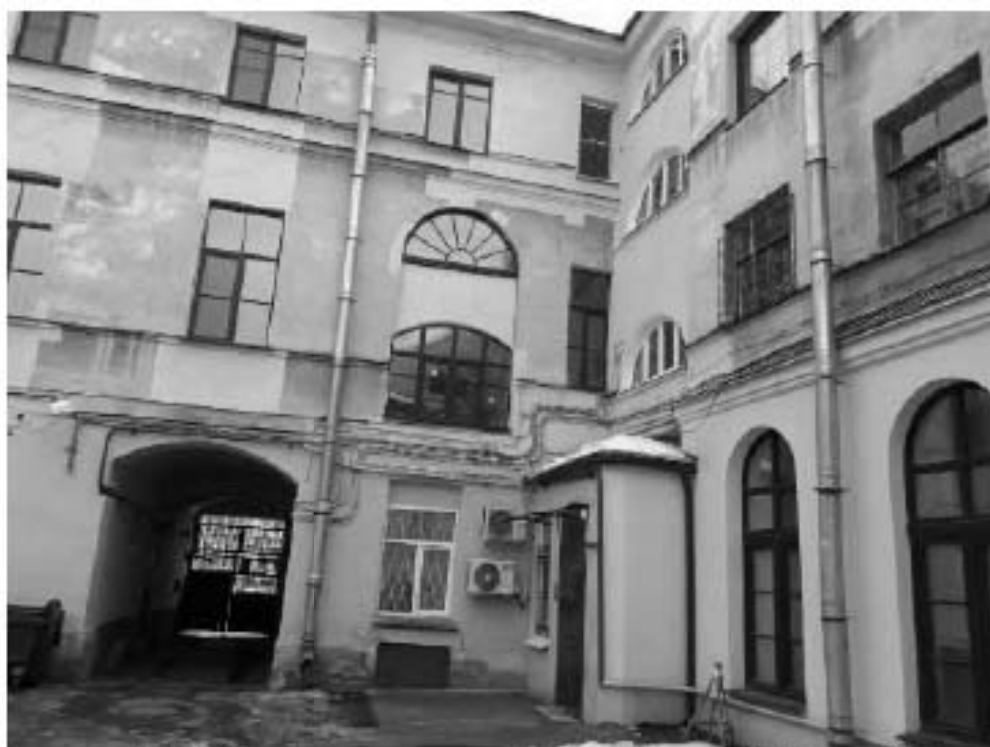
24. Дома Полторацкой С.М. (три). Фонтанки реки наб., д. 97, лит. А. Дворовый фасад. Фото мест установки оборудования и кабельных трасс. Штиглиц М.С. 06.03.2022.
