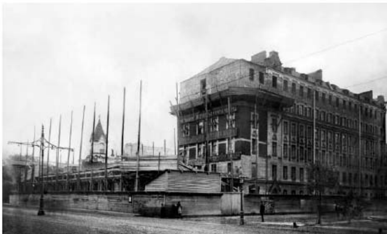
45. Доходный дом (в составе «Здания при Латышской лютеранской церкви Христа Спасителя»). Участок строительства дома. Загородный пр., д. 64, лит. А. Фото 1910 г. (24).
