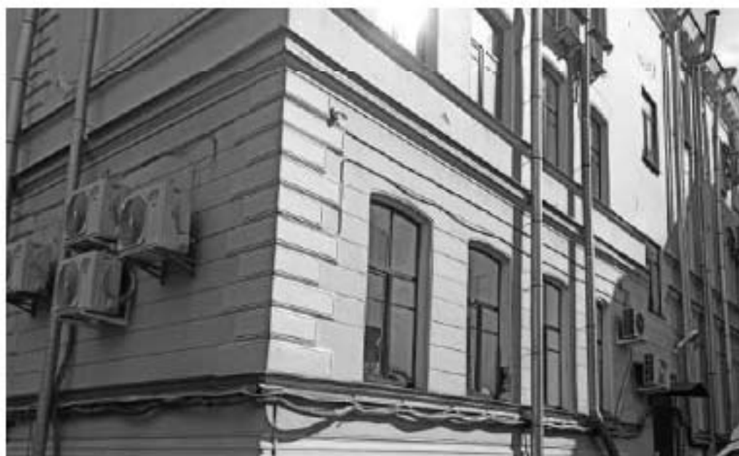
19. Главное здание по наб. р. Фонтанки (в составе «Крестовоздвиженская община сестер милосердия»). Фонтанки реки наб., д. 154, лит. Г. Дворовый фасад. Фото мест установки оборудования и кабельных трасс. Штиглиц М.С. 06.03.2022.
