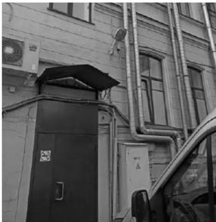
20. Главное здание по наб. р. Фонтанки (в составе «Крестовоздвиженская община сестер милосердия»). Фонтанки реки наб., д. 154, лит. Г. Дворовый фасад. Фото мест установки оборудования и кабельных трасс. Штиглиц М.С. 06.03.2022.
