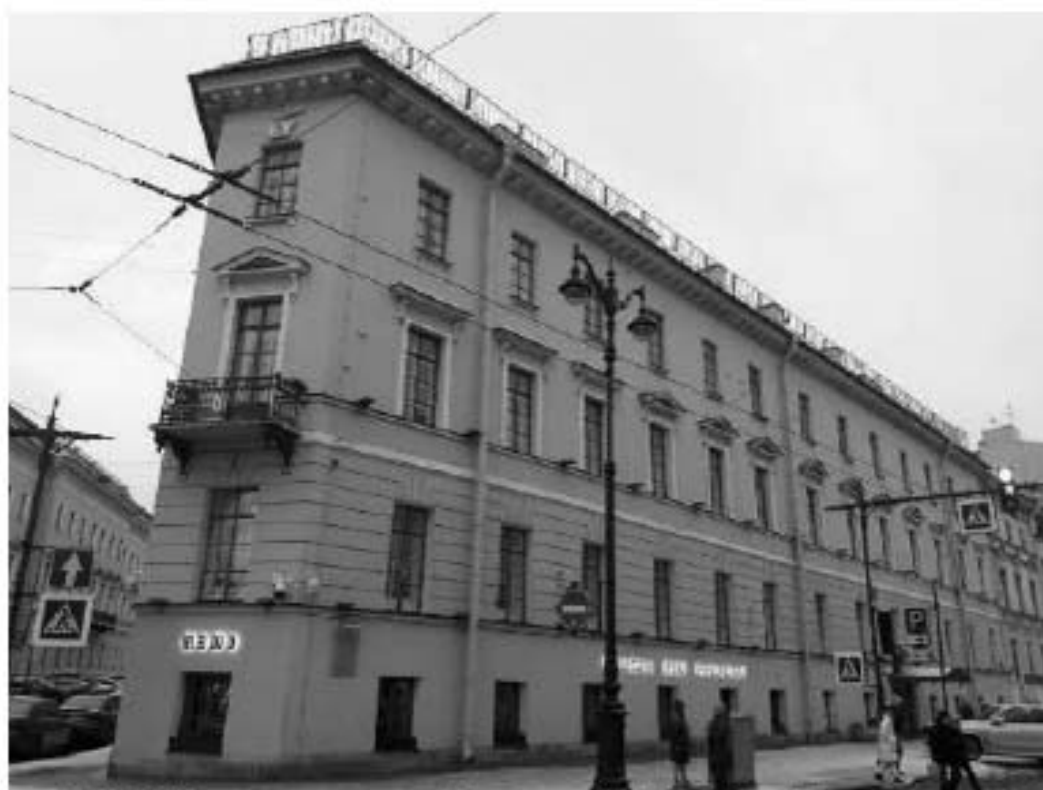
8. Дом, где в 1847-1849 гг. жил писатель Достоевский Ф.М. Малая Морская ул., д. 23, лит. А. Лицевой фасад. Фото мест установки оборудования и кабельных трасс. Штиглиц М.С. 06.03.2022.
