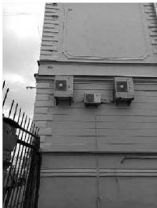
18. Главное здание по наб. р. Фонтанки (в составе «Крестовоздвиженская община сестер милосердия»). Фонтанки реки наб., д. 154, лит. Г. Боковой фасад. Фото мест установки оборудования и кабельных трасс. Штиглиц М.С. 06.03.2022.
