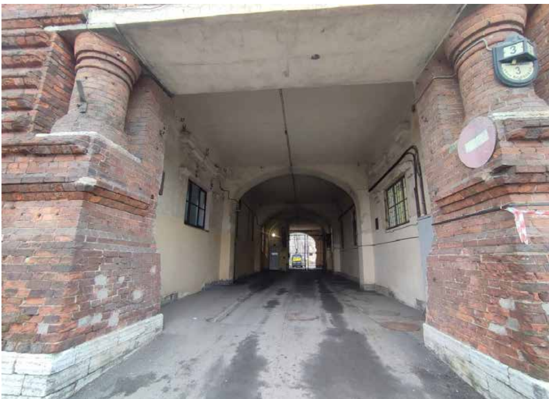
5. Объект культурного наследия регионального значения «Главный корпус Волковской богадельни», расположенный по адресу: г. Санкт-Петербург, набережная реки Волковки, дом 3, литера А. Общий вид воротного проезда со стороны набережной.
