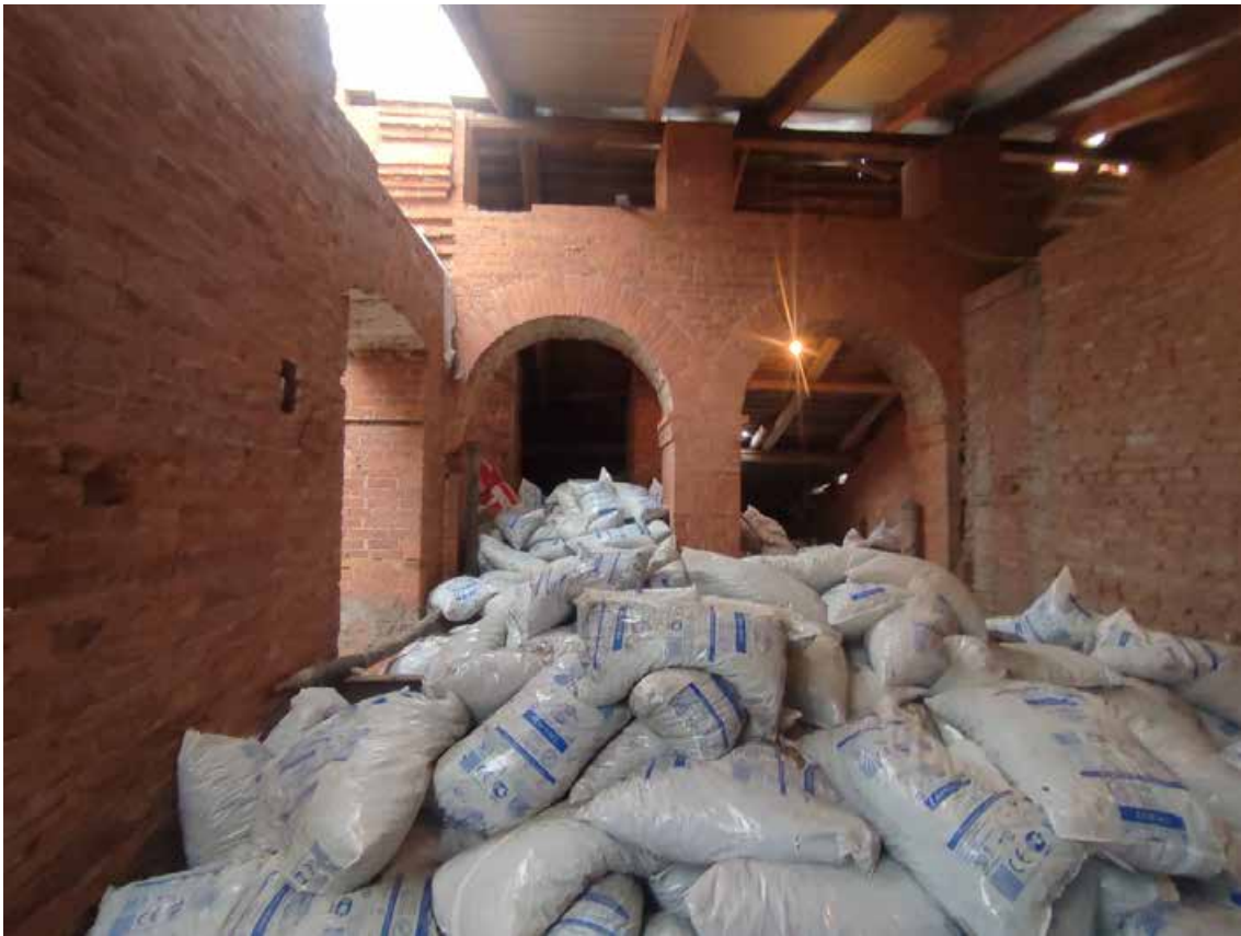
45. Объект культурного наследия регионального значения «Главный корпус Волковской богадельни», расположенный по адресу: г. Санкт-Петербург, набережная реки Волковки, дом 3, литера А. Фрагмент аркады в уровне чердака.
