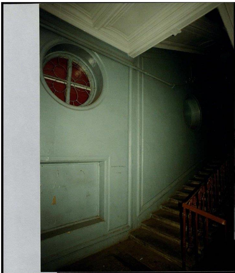
Санкт-Петербург, Центральный район ул. Моховая, дд. 27-29 Доходный дом Страхового общества "Россия" 1838 г., 1882 г., 1897 г. арх. Л. Бенуа. Северный корпус (№1). Северная парадная лестница. Площадка между 1 и 2 этажами. Вид с юга Сентябрь 1999 г., фото В. П. Орлова Фото № 25
