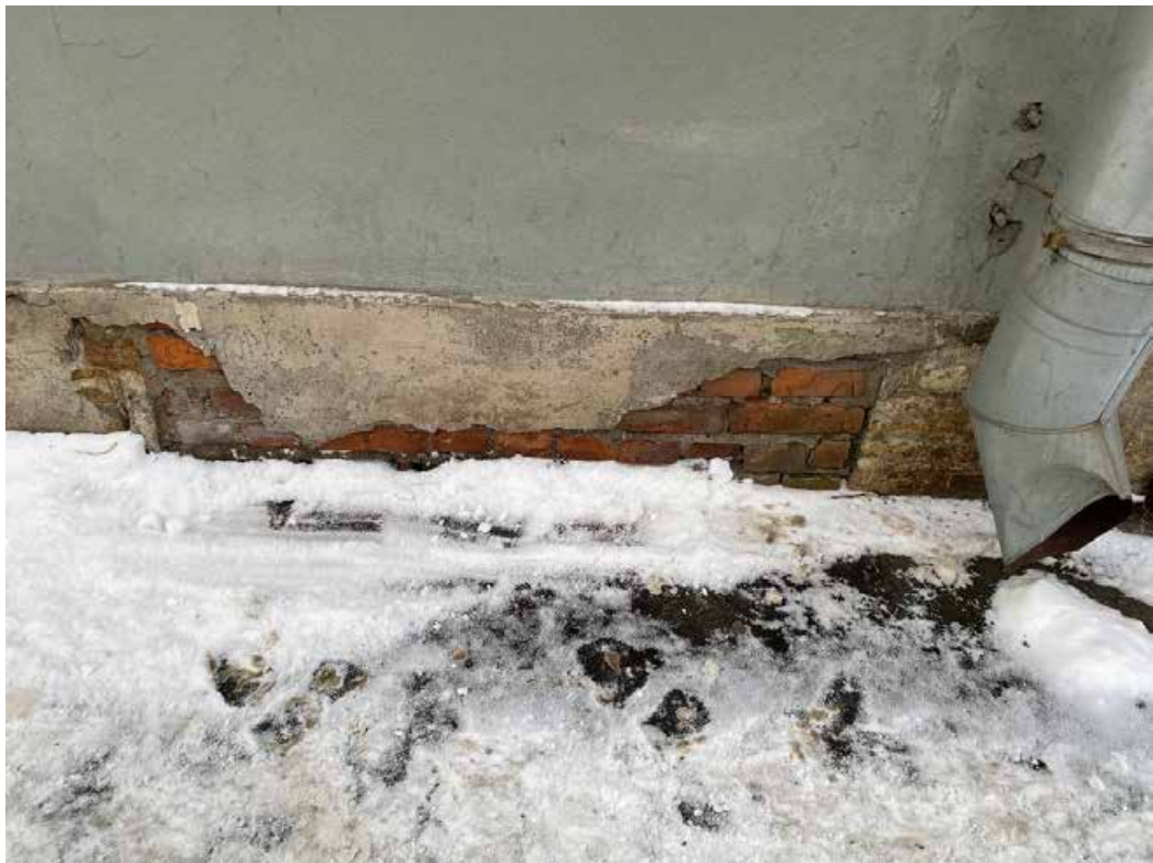
Фото 6. Лицевой фасад в осях «4-3» по Масляному каналу. Фрагмент с цоколем и закладкой на месте бывшего дверного проема.
