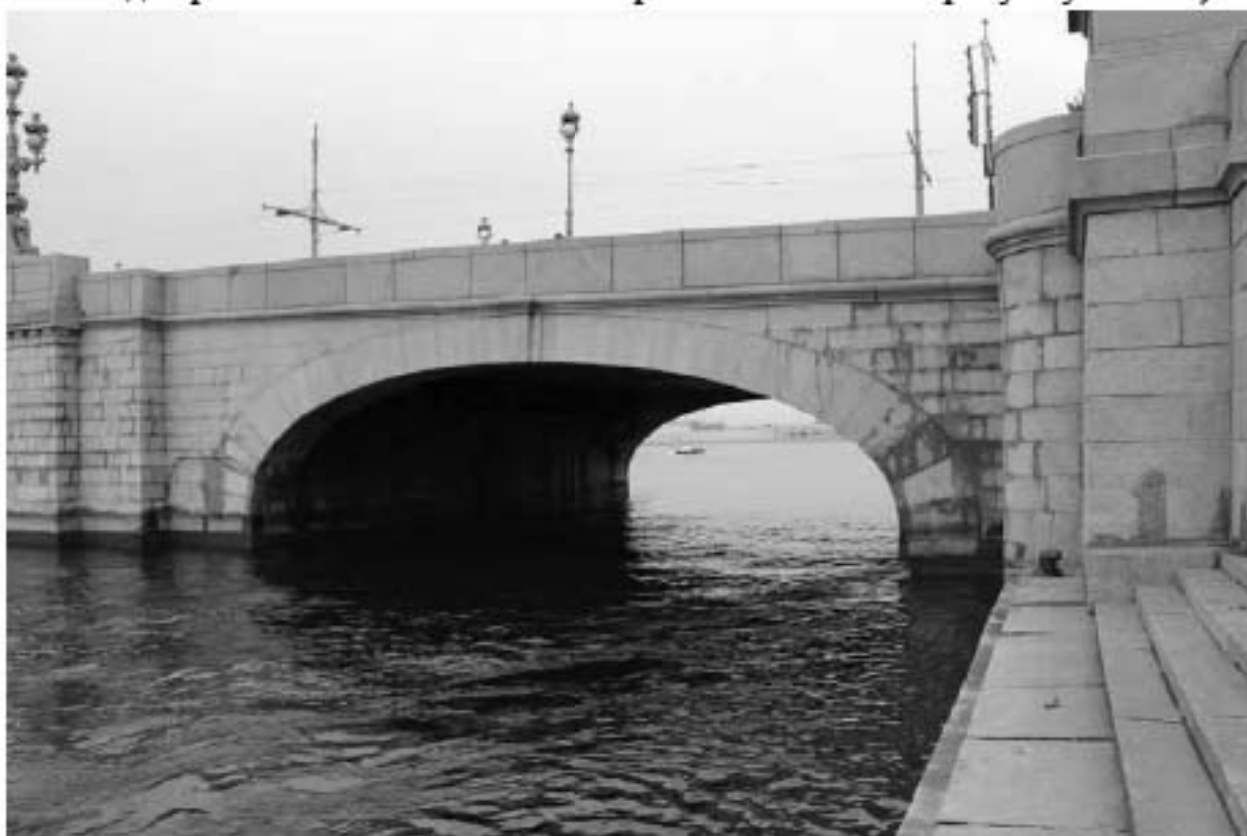
Фото 60. Вид от западного спуска на южном берегу объекта культурного наследия регионального значения «Кировский мост».
