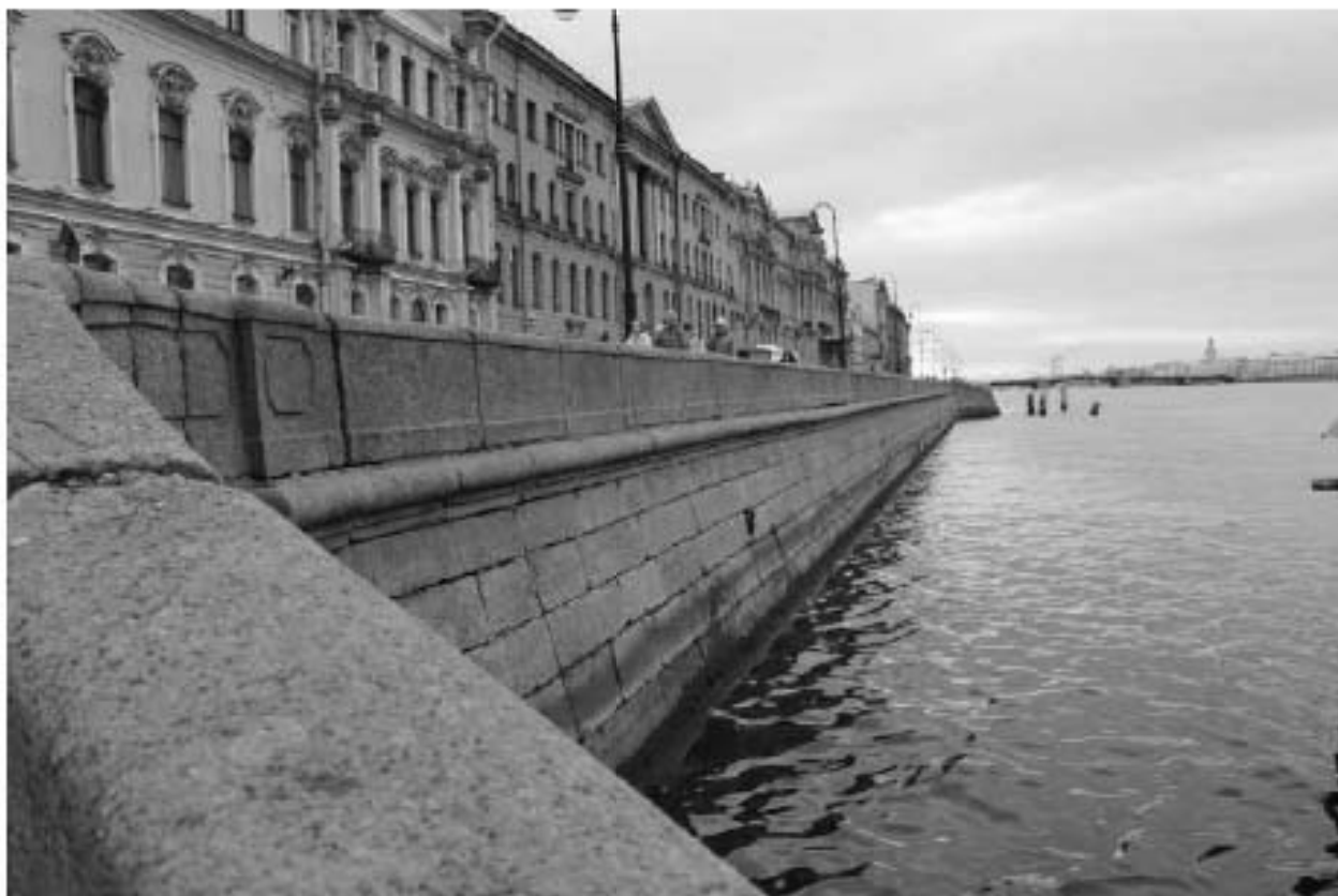
Фото 43. Вид на объект культурного наследия федерального значения «Набережная» на участке набережной реки Невы «Троицкий мост – Эрмитажный мост», литера Б (подпорная стенка от спуска № 4 в сторону спуска № 3).
