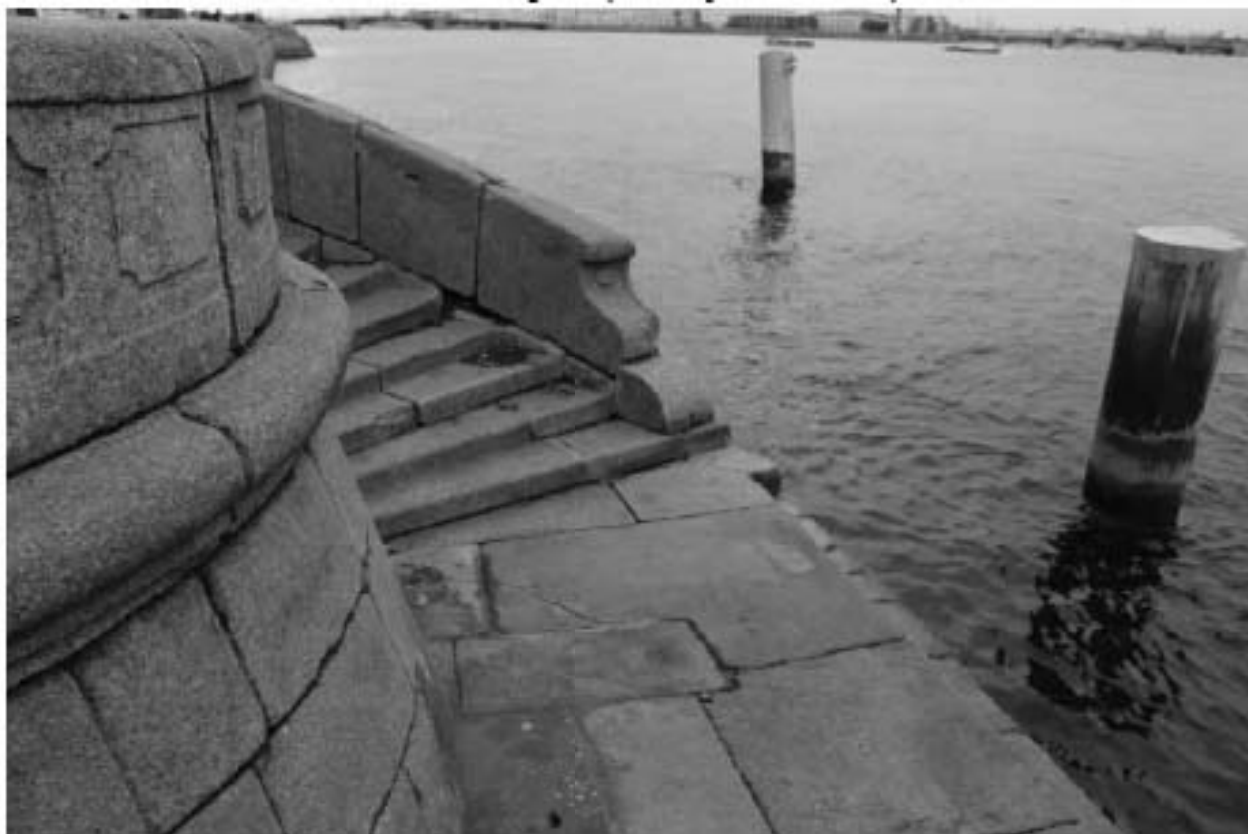
Фото 30. Вид на объект культурного наследия федерального значения «Спуски лестничные» на участке набережной реки Невы «Троицкий мост – Эрмитажный мост», литера Б (3-й спуск с запада).
