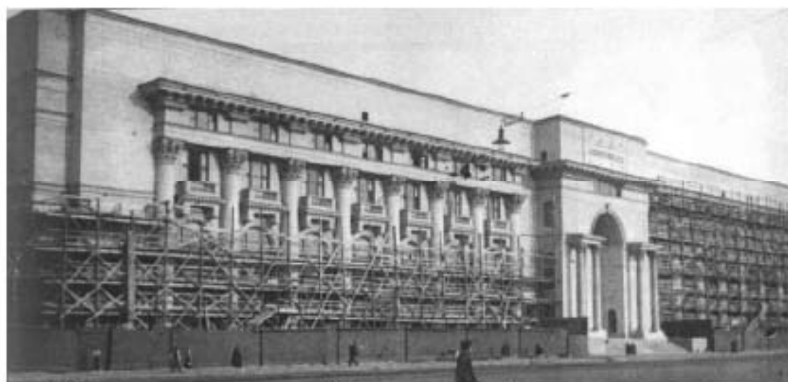
49. Окончание строительства Дворца пушкины. Демонтаж строителных лесов с главных фасадов. 1938г. ЦГАКФФД СПб. Вр 49698.
