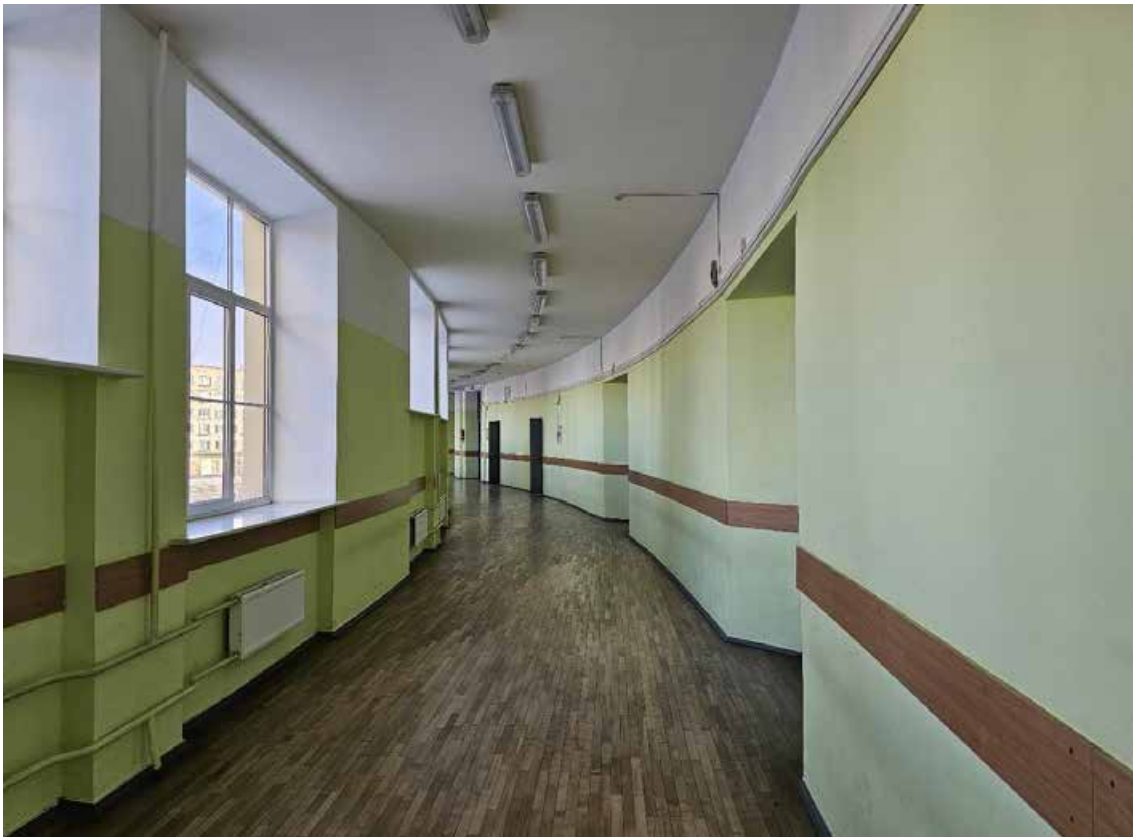
73. Объект культурного наследия федерального значения «Школа имени 10-летия Октября», по адресу: г. Санкт-Петербург, проспект Стачек, дом 5, литера А. Фрагмент пом. 1-Н (107) в уровне 2-го этажа.
