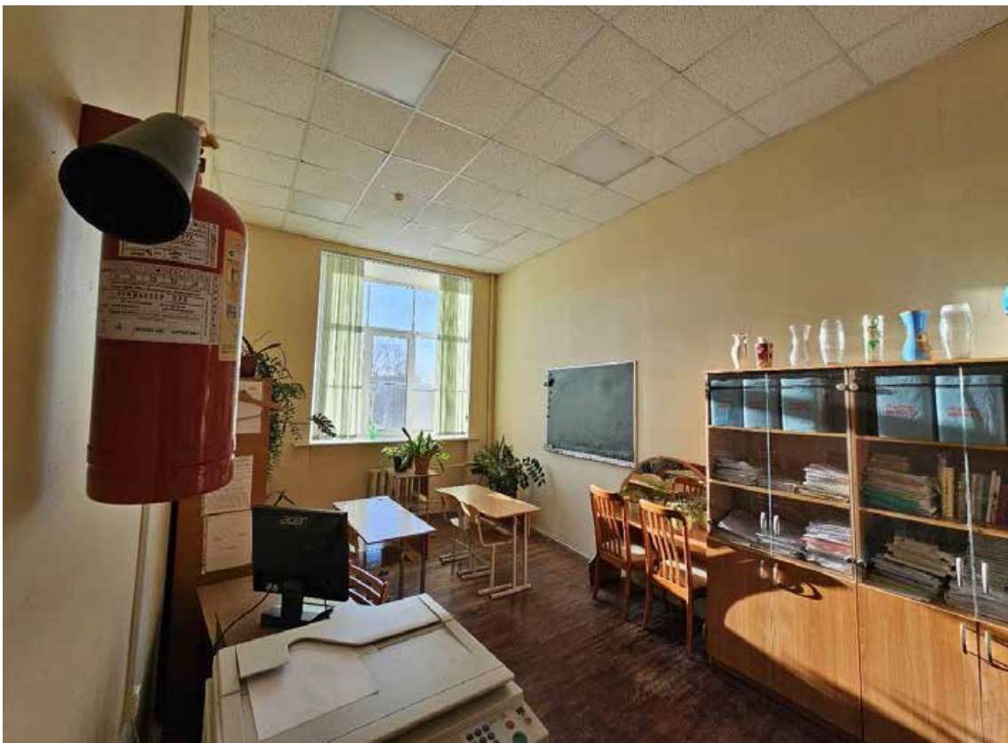
99. Объект культурного наследия федерального значения «Школа имени 10-летия Октября», по адресу: г. Санкт-Петербург, проспект Стачек, дом 5, литера А. Общий вид пом. 1-Н (184) в уровне 3-го этажа.
