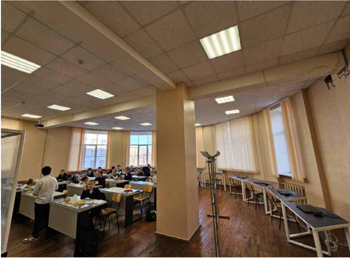
88. Объект культурного наследия федерального значения «Школа имени 10-летия Октября», по адресу: г. Санкт-Петербург, проспект Стачек, дом 5, литера А. Общий вид пом. 1-Н (157) в уровне 3-го этажа.
