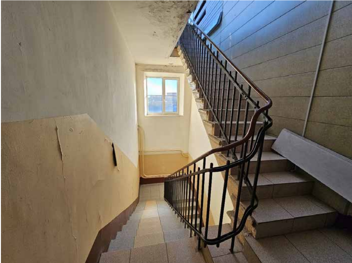
129. Объект культурного наследия федерального значения «Школа имени 10-летия Октября», по адресу: г. Санкт-Петербург, проспект Стачек, дом 5, литера А. Общий вид пом. 1-Н (222) в уровне 6-го этажа.
