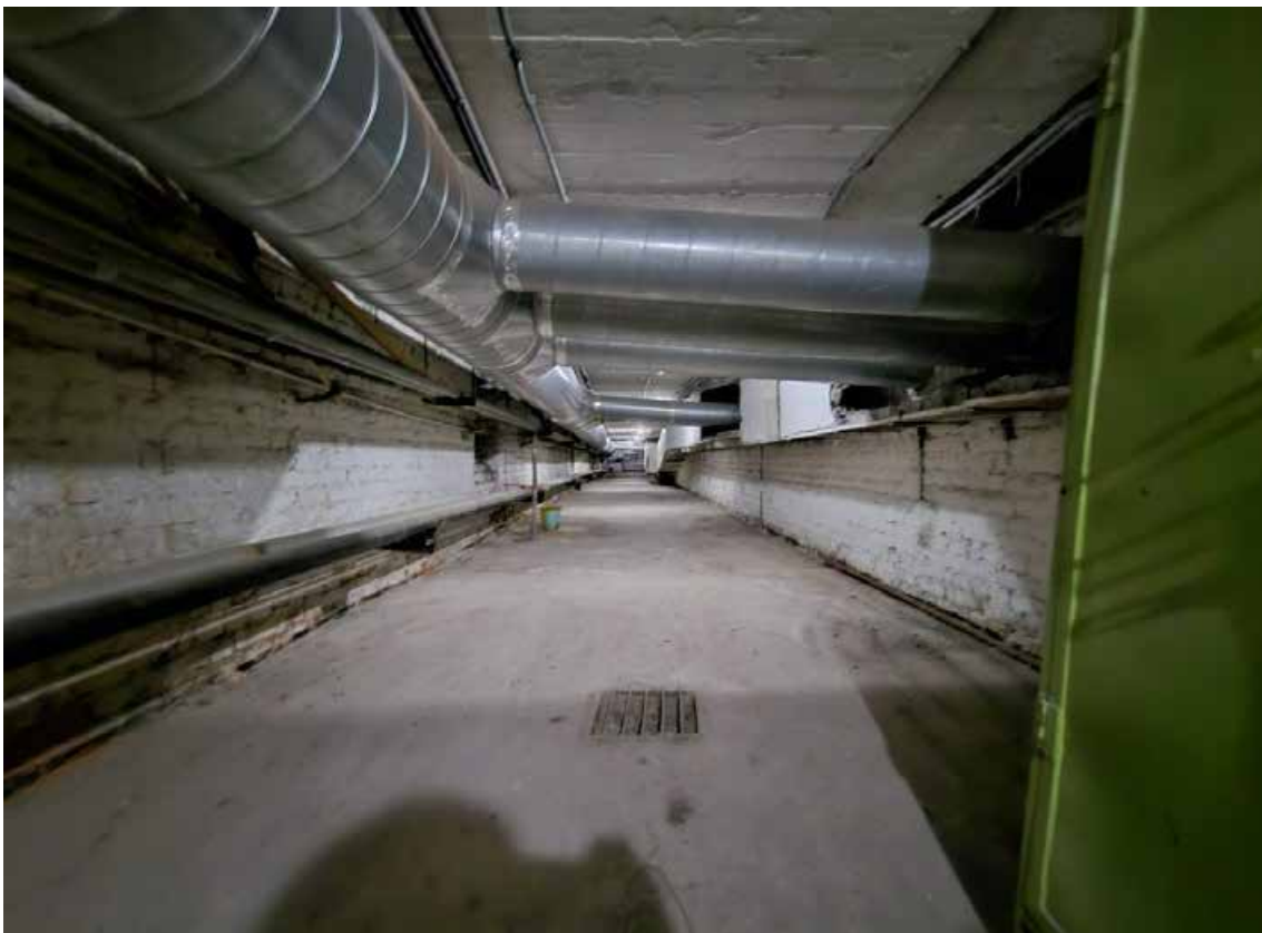
16. Объект культурного наследия федерального значения «Школа имени 10-летия Октября», по адресу: г. Санкт-Петербург, проспект Стачек, дом 5, литера А. Общий вид пом. 1-Н (2) в уровне подвала.
