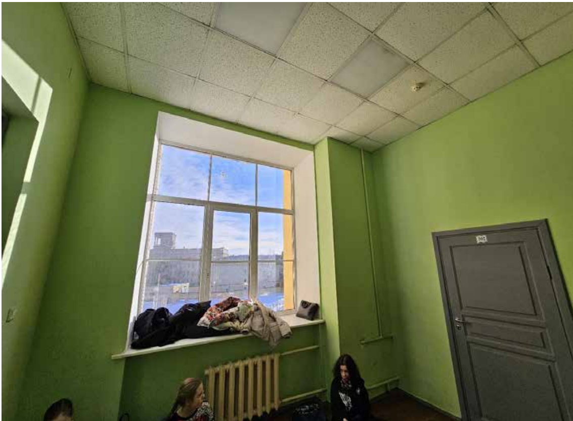
84. Объект культурного наследия федерального значения «Школа имени 10-летия Октября», по адресу: г. Санкт-Петербург, проспект Стачек, дом 5, литера А. Общий вид пом. 1-Н (149) в уровне 3-го этажа.
