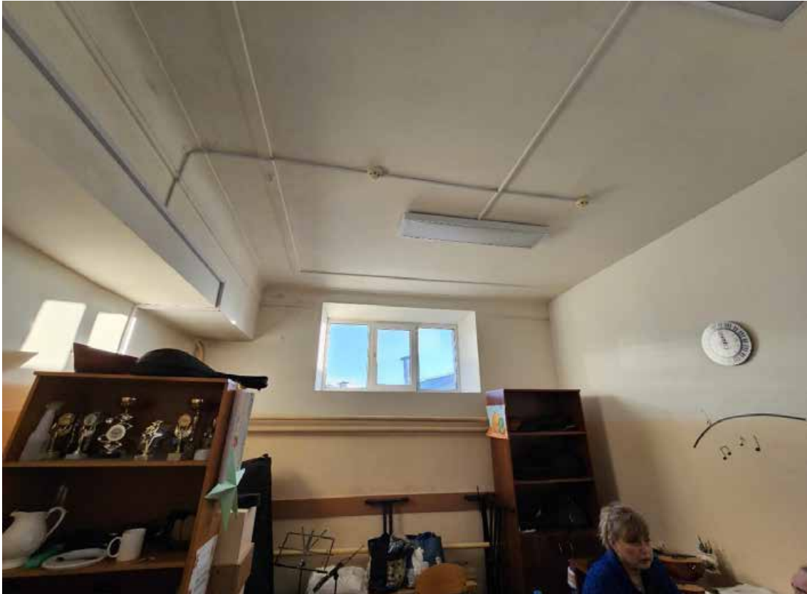
126. Объект культурного наследия федерального значения «Школа имени 10-летия Октября», по адресу: г. Санкт-Петербург, проспект Стачек, дом 5, литера А. Общий вид пом. 1-Н (215) в уровне 5-го этажа.
