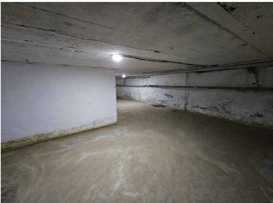
23. Объект культурного наследия федерального значения «Школа имени 10-летия Октября», по адресу: г. Санкт-Петербург, проспект Стачек, дом 5, литера А. Фрагмент пом. 1-Н (17) в уровне подвала.
