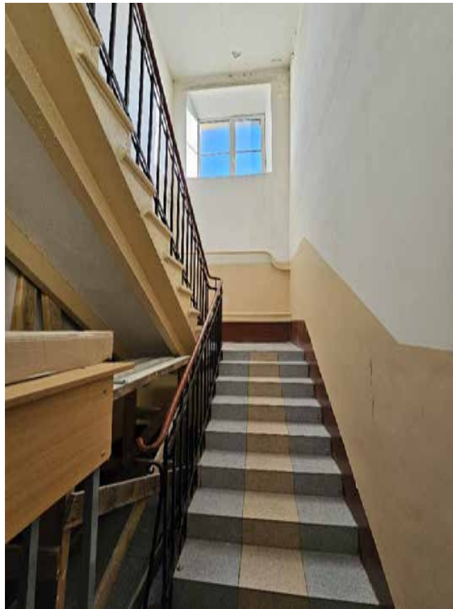
128. Объект культурного наследия федерального значения «Школа имени 10-летия Октября», по адресу: г. Санкт-Петербург, проспект Стачек, дом 5, литера А. Общий вид пом. 1-Н (217) в уровне 5-го этажа.
