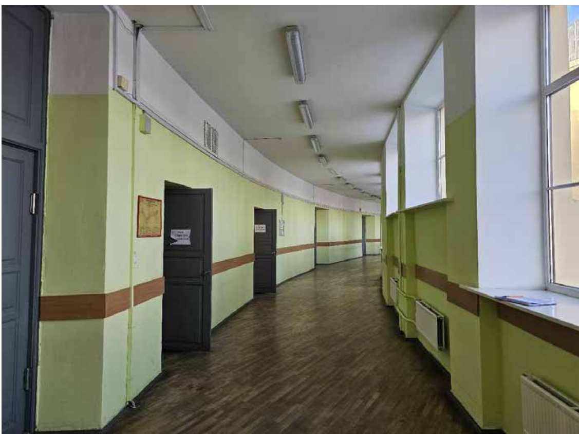
70. Объект культурного наследия федерального значения «Школа имени 10-летия Октября», по адресу: г. Санкт-Петербург, проспект Стачек, дом 5, литера А. Фрагмент пом. 1-Н (107) в уровне 2-го этажа.
