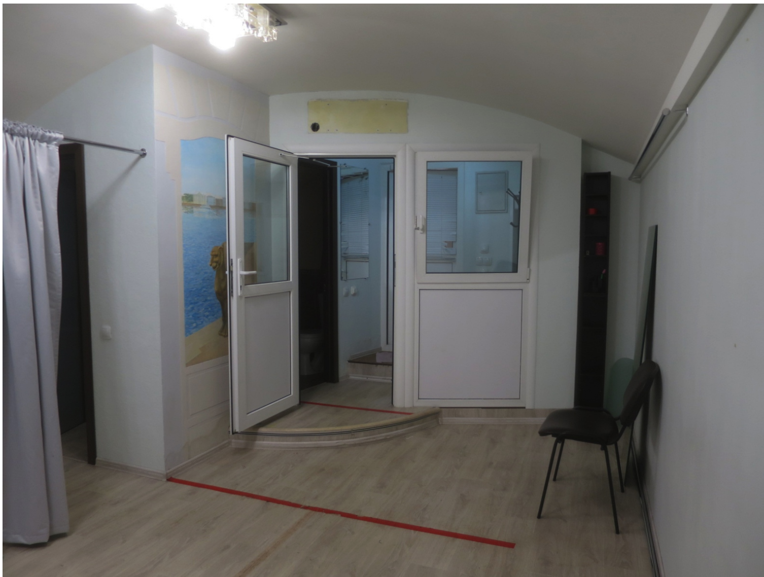
7. «Дом Г.Г.Елисеева». Санкт-Петербург, ул. Ломоносова, д.14, литера А. Фрагмент пом. 4-Н. Фото: 26.01.2024.
