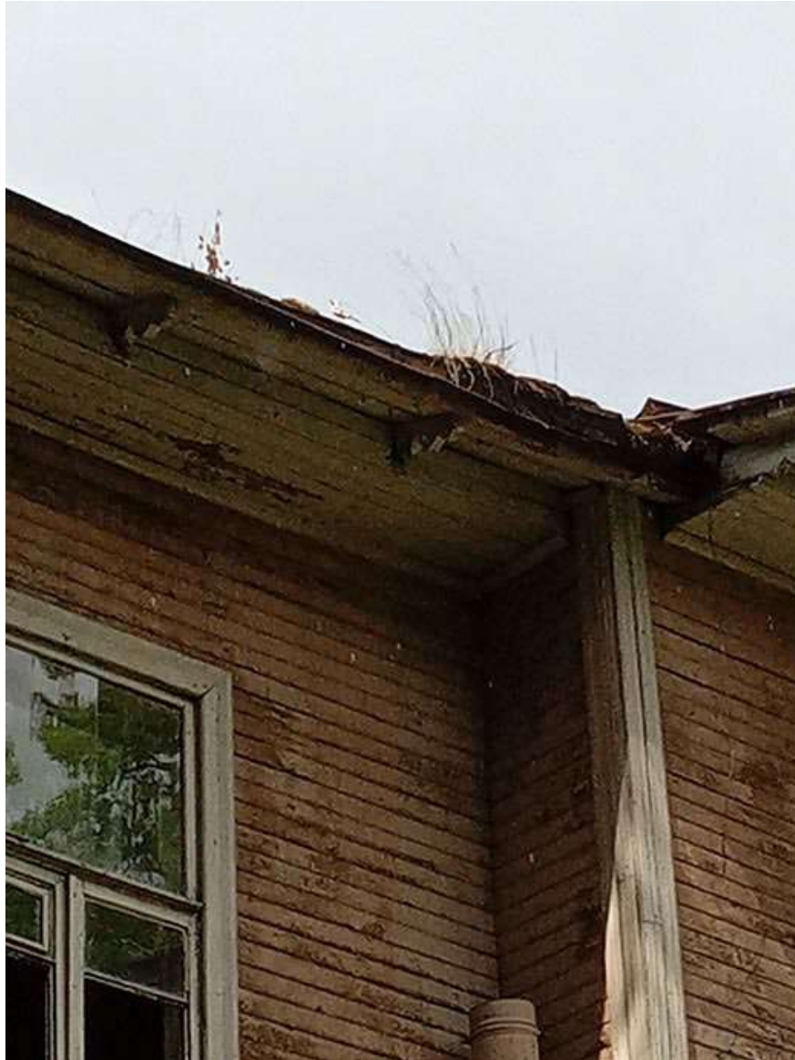
Фото 24. Выявленный объект культурного наследия «Дом купца Елисеева (ресторан) (деревянный)» по адресу: Санкт-Петербург, г. Зеленогорск Приморское шоссе, дом 520, литера Ц.
