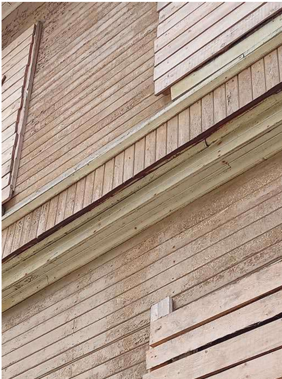
Фото 9. Выявленный объект культурного наследия «Дом купца Елисеева (ресторан) (деревянный)» по адресу: Санкт-Петербург, г. Зеленогорск Приморское шоссе, дом 520, литера Ц.
