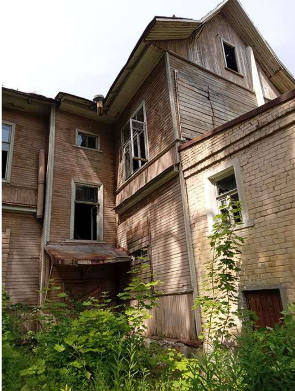
Фото 22. Выявленный объект культурного наследия «Дом купца Елисеева (ресторан) (деревянный)» по адресу: Санкт-Петербург, г. Зеленогорск Приморское шоссе, дом 520, литера Ц.
