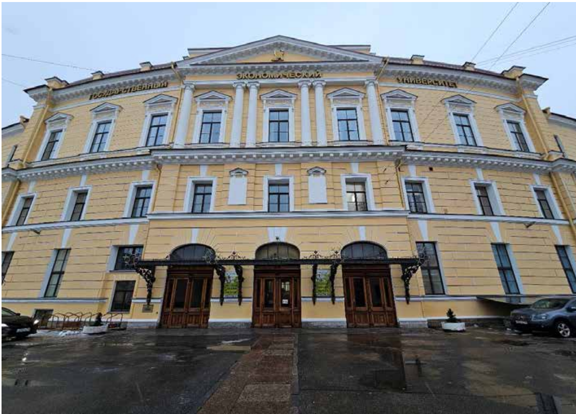
5. Объект культурного наследия федерального значения «Банк», расположенный по адресу: г. Санкт-Петербург, наб. кан. Грибоедова, д. 30-32, лит. А, входящий в состав объекта культурного наследия федерального значения «Банк Ассигнационный». Фрагмент центральной части северо-западного лицевого фасада по наб. канала Грибоедова.
