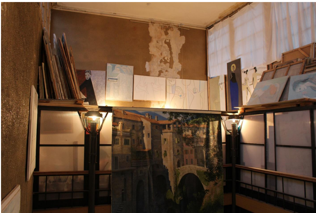
Фото 101. Внутренние помещения дворового флигеля выявленного объекта культурного наследия «Дом Зверкова (И.С. Никитина)». Нежилое помещение 34-Н. Чердачный этаж.
