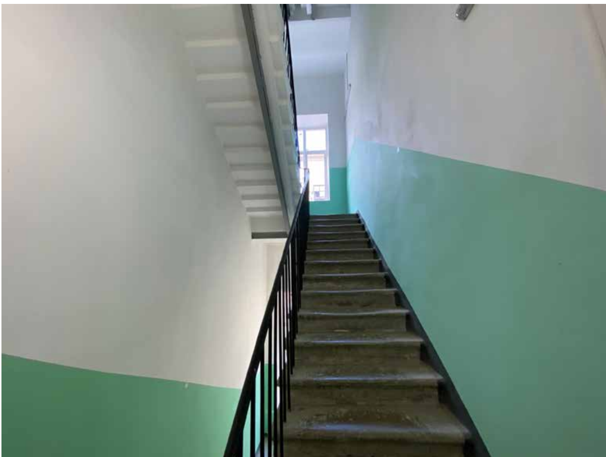
Фото 300. ОКН РЗ «Дом, где в 1888-1889 гг. жил художник Серов Валентин Александрович» (Итальянская ул., д. 11). Помещение Л-2.
