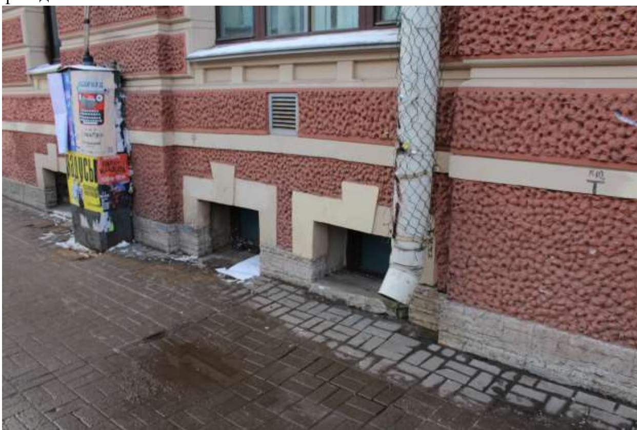
44. Выявленный объект культурного наследия «Городской дом 1-го Василеостровского начального народного училища». Вид на ввод теплосети со стороны 7-й линии В.О.
