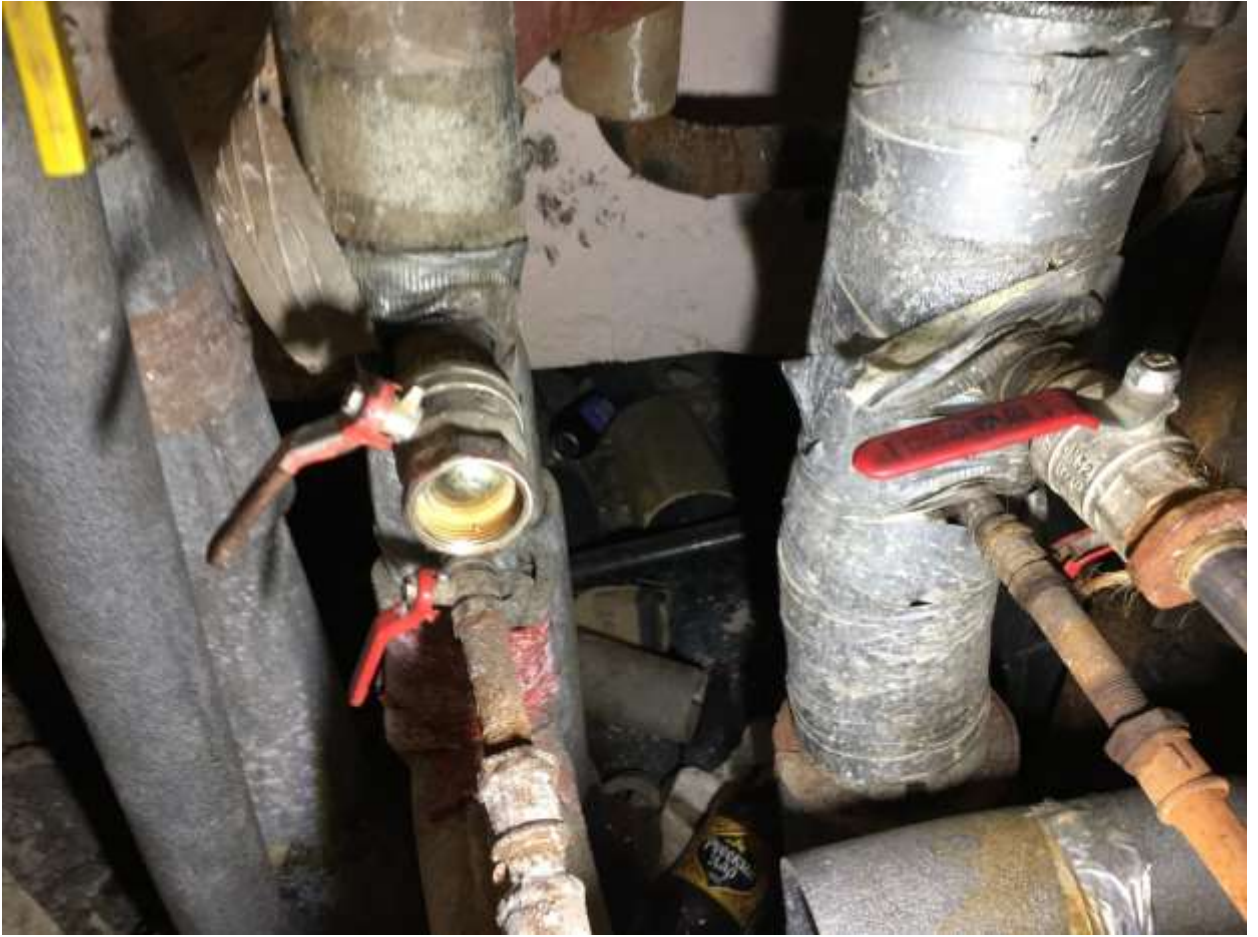
9. Помещение Выявленный объект культурного наследия «Дом В.И. Миллера». Помещение теплоцентра, вид на ввод теплосети.
