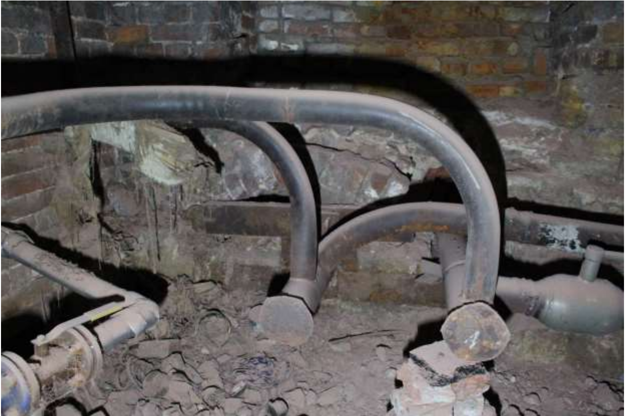
69. Выявленный объект культурного наследия «Дом Г.А. Хаймовича (при фабрике жестяных изделий)». Вид на ввод теплосети в подвале четырехэтажного с мансардой корпуса.
