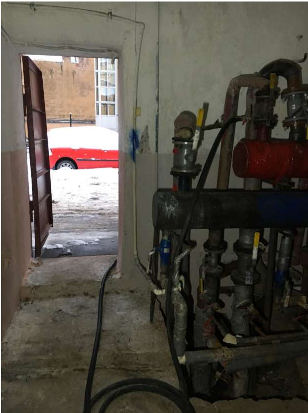
7. Выявленный объект культурного наследия «Дом В.И. Миллера». Помещение теплоцентра.
