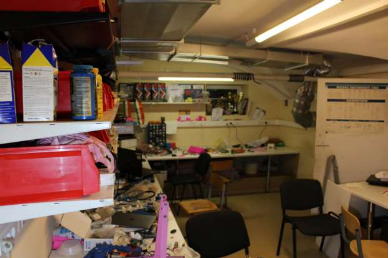
52. Выявленный объект культурного наследия «Городской дом 1-го Василеостровского начального народного училища». Вид на зашитые трубы теплосети в подвальном помещении.
