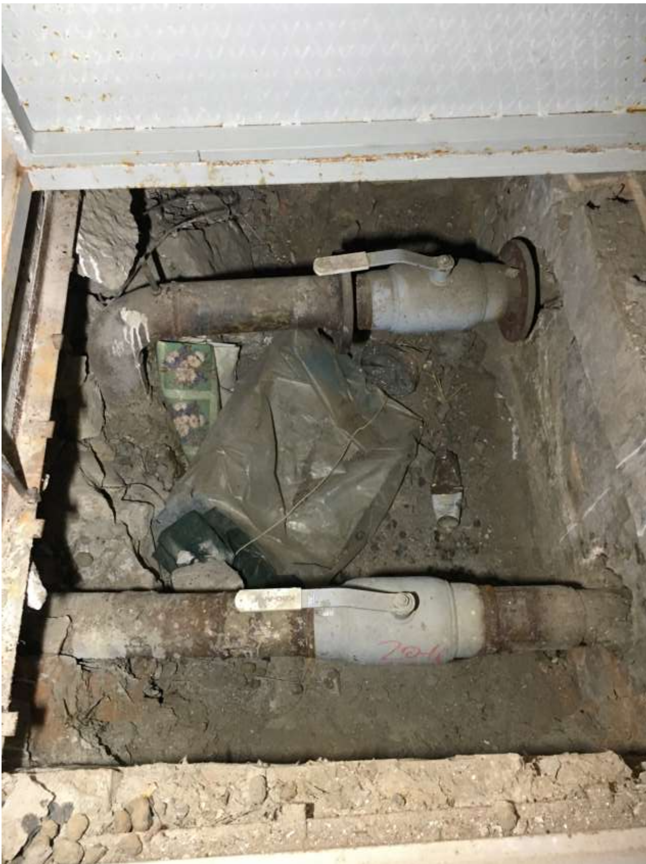
39. Выявленный объект культурного наследия «Дом В.А. Квасникова». Вид на трубы теплосети в подпольном канале отдельно стоящего дворового корпуса.
