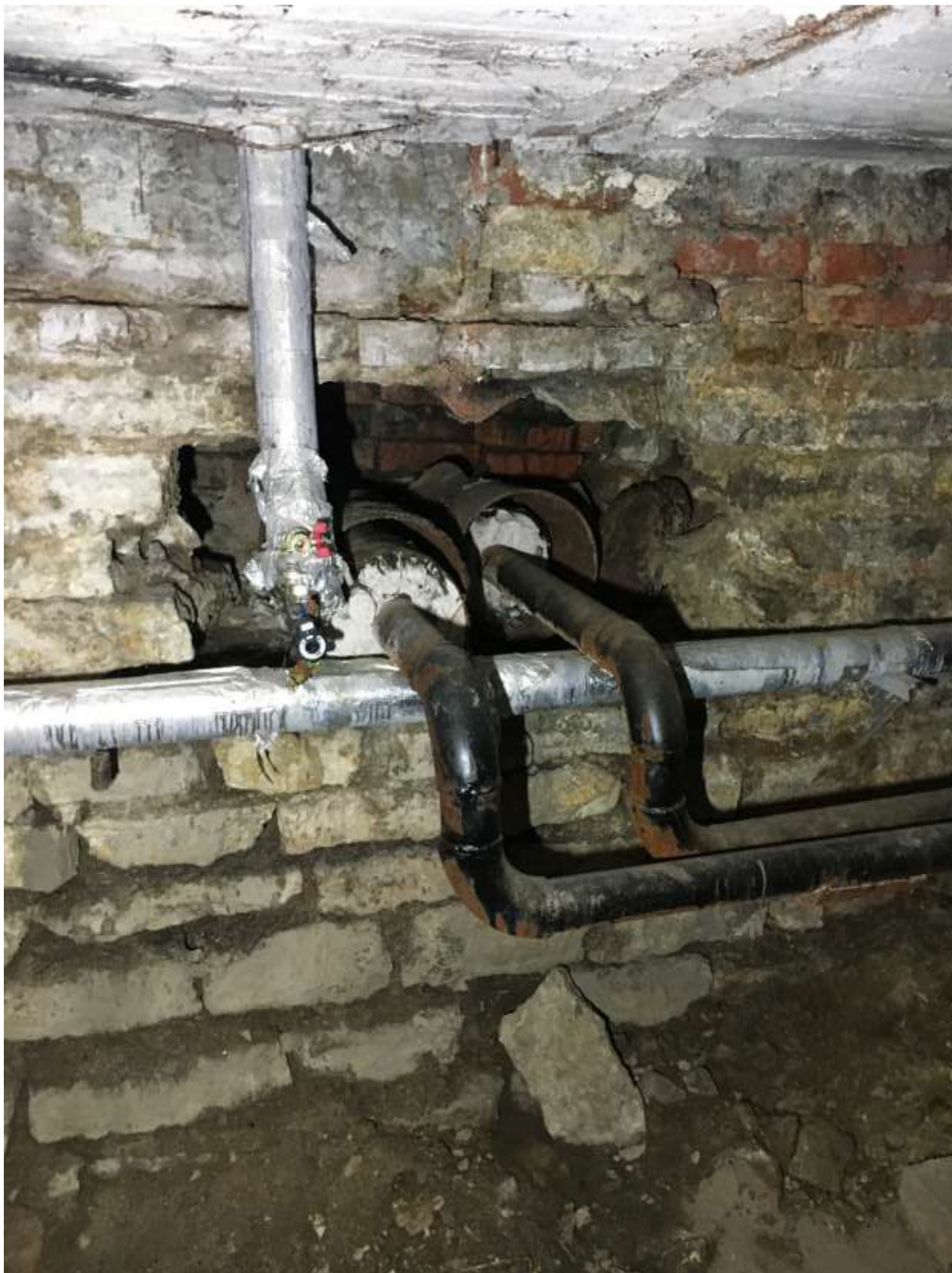
78. Выявленный объект культурного наследия «Богадельня для женщин». Вид на ввод теплосети в подвальном помещении.
