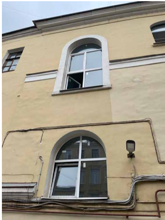
34. Дворовый фасад лицевого корпуса в световой оси 11 в уровне 2, 3 этажей. Выявленный объект культурного наследия «Дом Ю. Н. Адельсон», расположенный по адресу: г. Санкт-Петербург, Гороховая ул, дом 33, литера А
