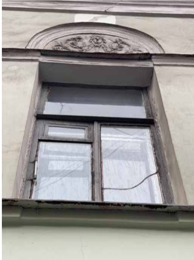
13. Деревянное заполнение оконного проема по световой оси 14 в уровне 2 этажа. Выявленный объект культурного наследия «Дом Ю. Н. Адельсон», расположенный по адресу: г. Санкт-Петербург, Гороховая ул, дом 33, литера А
