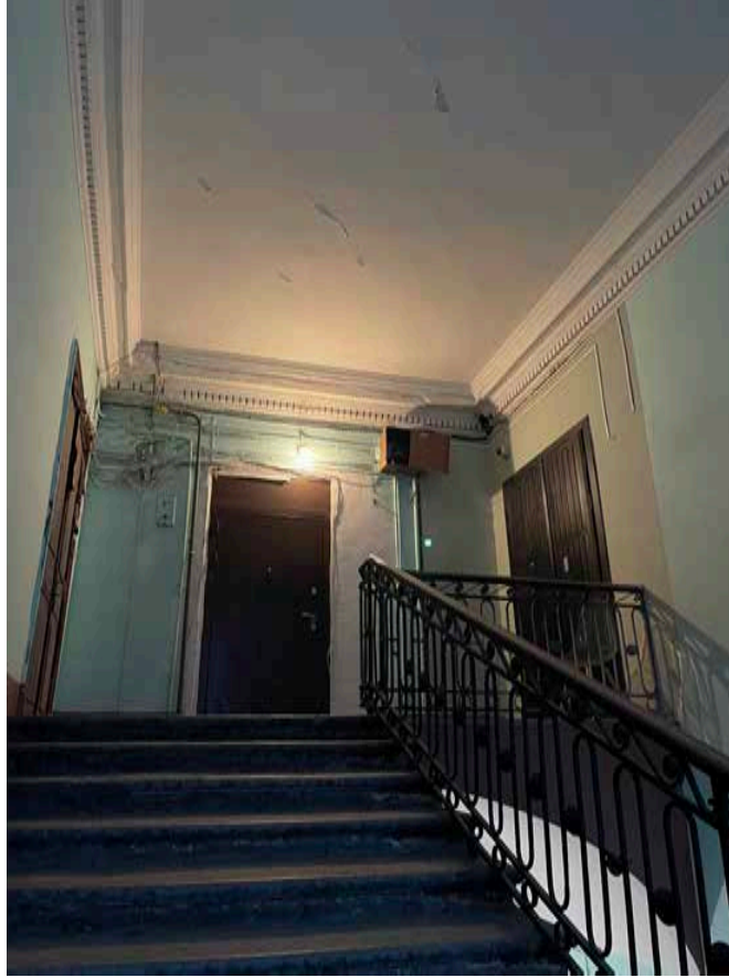
41. Перекрытие лестничной клетки и профилированный карниз с дентикулами. Выявленный объект культурного наследия «Дом Ю. Н. Адельсон», расположенный по адресу: г. Санкт-Петербург, Гороховая ул, дом 33, литера А
