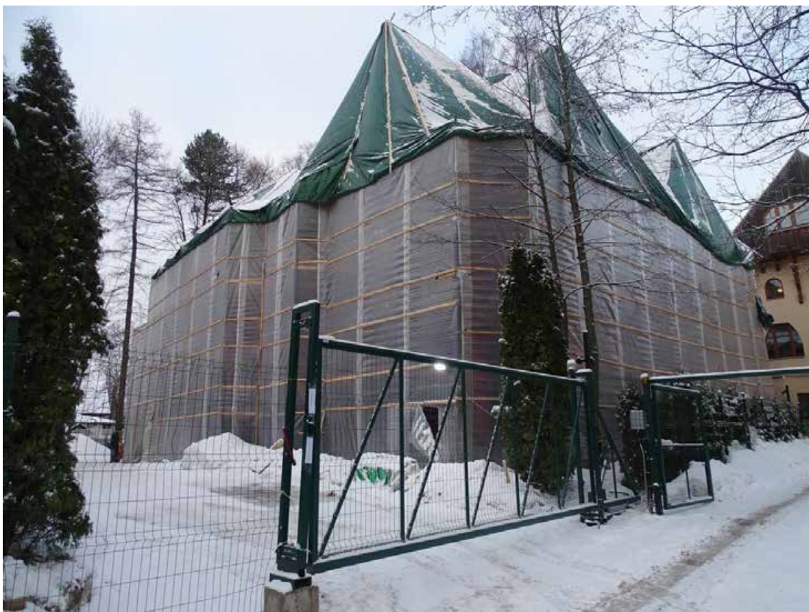
Илл. 5. «Дом Гоце с участком парка». Вид на Дом Гоце Г.И. с Боковой аллеи. Съемка 26.12.2023 г. Трушковский В.Э.
