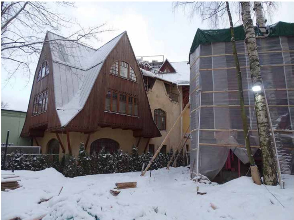
Илл. 8. Дом Гоze Г.И. Западный фасад. Фрагмент. Противоаварийные работы. Служебный флигель. Фрагмент. Съемка 26.12.2023 г. Трушковский В.Э.
