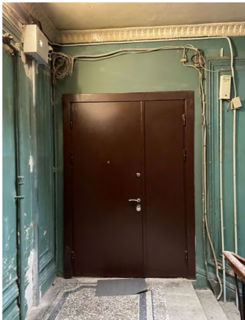
3. Входные дверные заполнения квартиры №25 в уровне 5-го этажа выявленного объекта культурного наследия «Дом С.Д. Шереметева», расположенного по адресу: г. Санкт-Петербург, Литейный проспект, дом 51, литера А. 14.12.2023.
