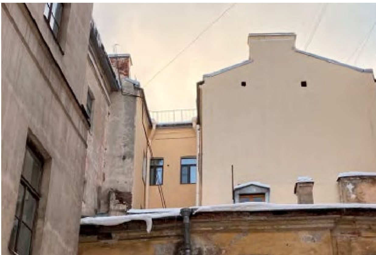
2. Оконные заполнения квартиры №25 в уровне 5-го этажа выявленного объекта культурного наследия «Дом С.Д. Шереметева», расположенного по адресу: г. Санкт-Петербург, Литейный проспект, дом 51, литера А. 14.12.2023.
