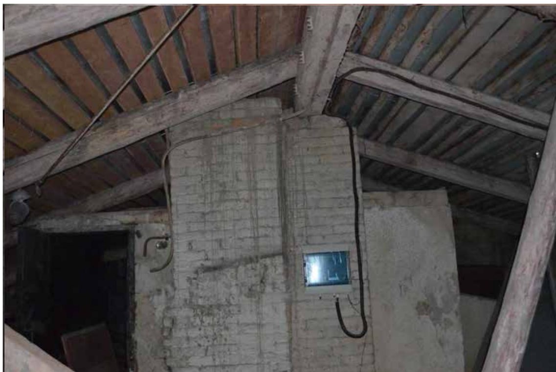
Фото 3. Объект культурного наследия федерального значения «Казармы с конюшнями», входящего в состав «Казармы лейб-гвардии конного полка» (г. Санкт-Петербург, Большая Морская ул., 67; Труда ул., 8-10; Якубовича ул., 26; Конногвардейский пер., 3-5). Чердачное пространство. Дата съемки:01.03.2024
