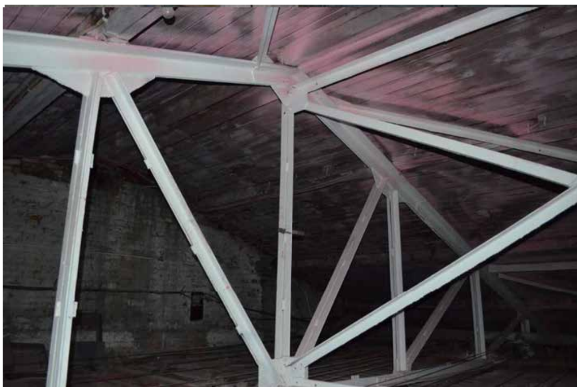
Фото 4. Объект культурного наследия федерального значения «Казармы с конюшнями», входящего в состав «Казармы лейб-гвардии конного полка» (г. Санкт-Петербург, Большая Морская ул., 67; Труда ул., 8-10; Якубовича ул., 26; Конногвардейский пер., 3-5). Чердачное пространство. Дата съемки:01.03.2024
