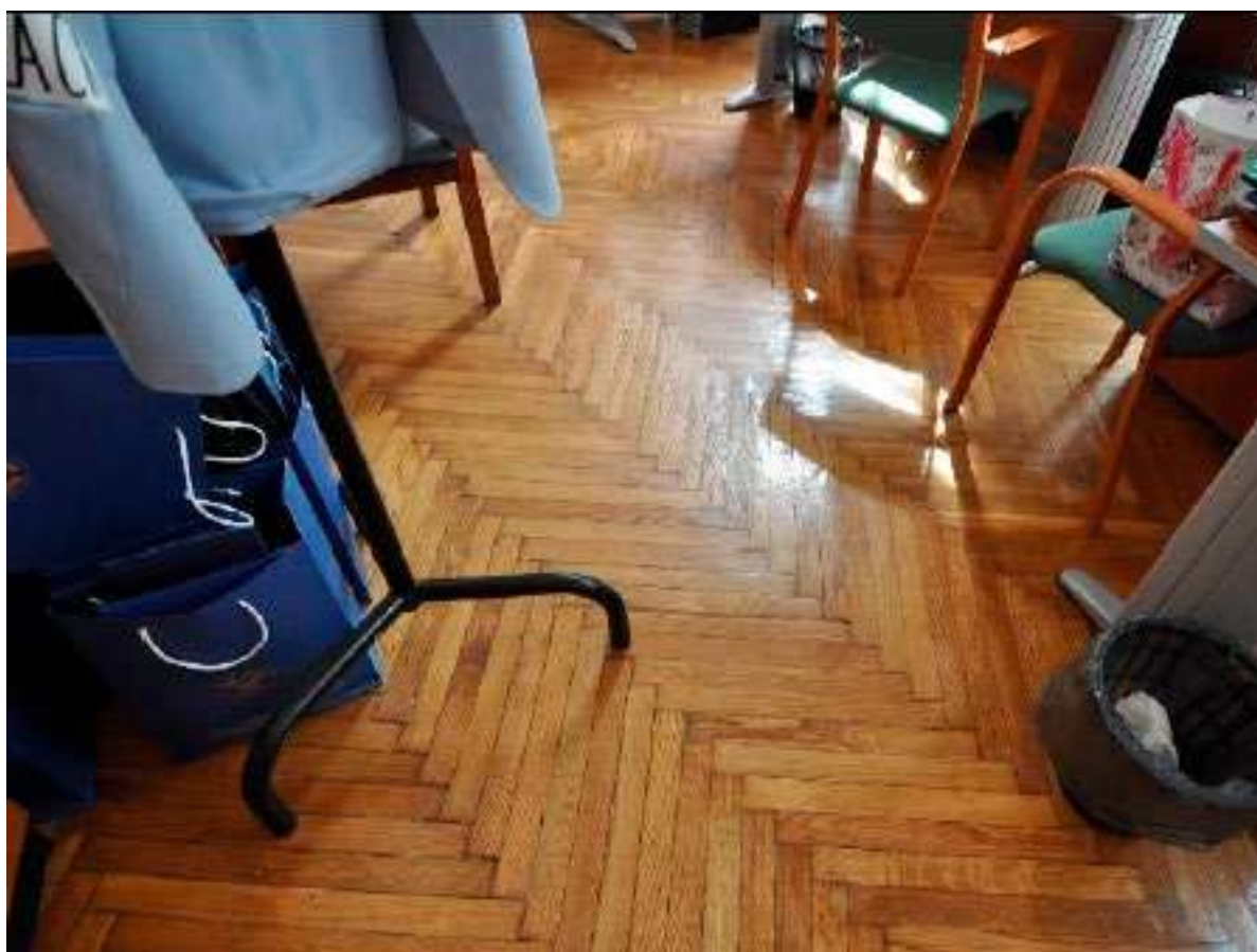
22. Помещение № 541 в уровне 2-го этажа объекта культурного наследия федерального значения «Дворец Таврический. Дворец», расположенного по адресу: г. Санкт-Петербург, ул. Шпалерная, д. 47, лит. А. 01.11.2023
