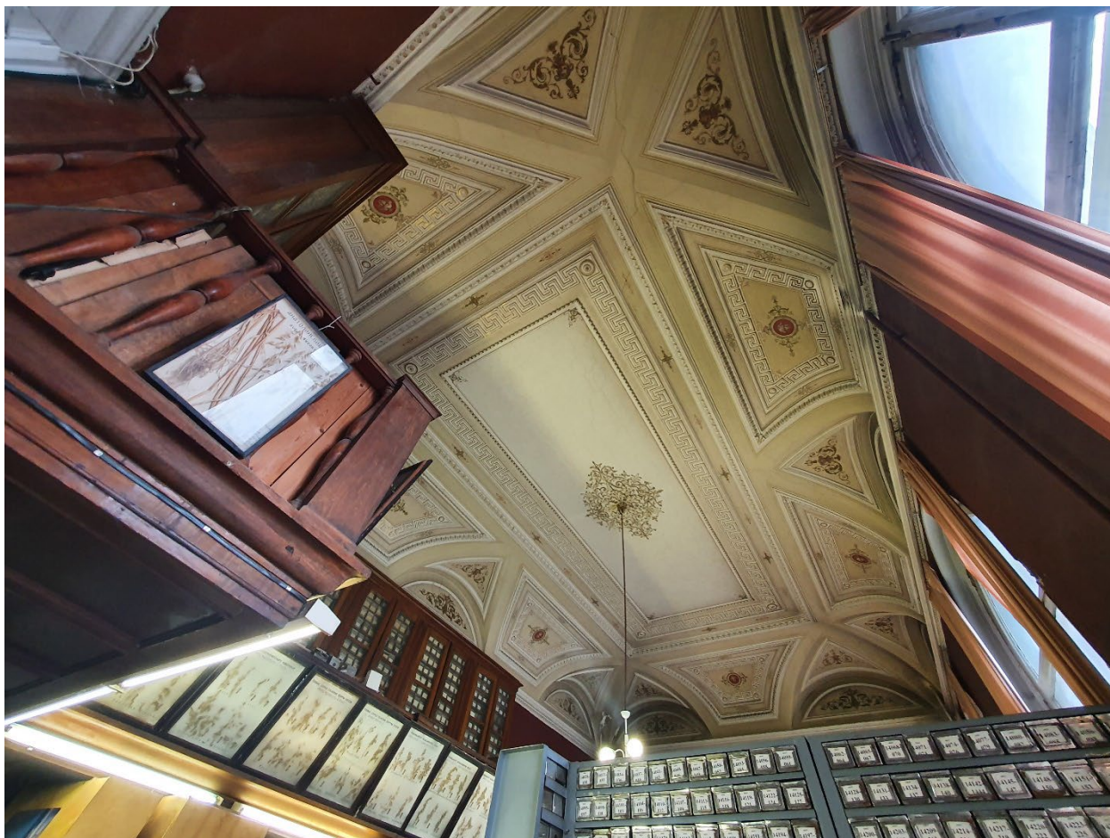
21. Помещение №19 (27Н) объекта культурного наследия федерального значения «Дом министра государственных имуществ», расположенного по адресу: г. Санкт-Петербург, Большая Морская ул., д. 44, литера А. 26.10.2021
