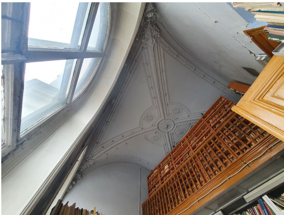
10. Помещение №14 (5Н) в уровне 1-го этажа объекта культурного наследия федерального значения «Дом министра государственных имуществ», расположенного по адресу: г. Санкт-Петербург, Большая Морская ул., д. 44, литера А. 26.10.2021
