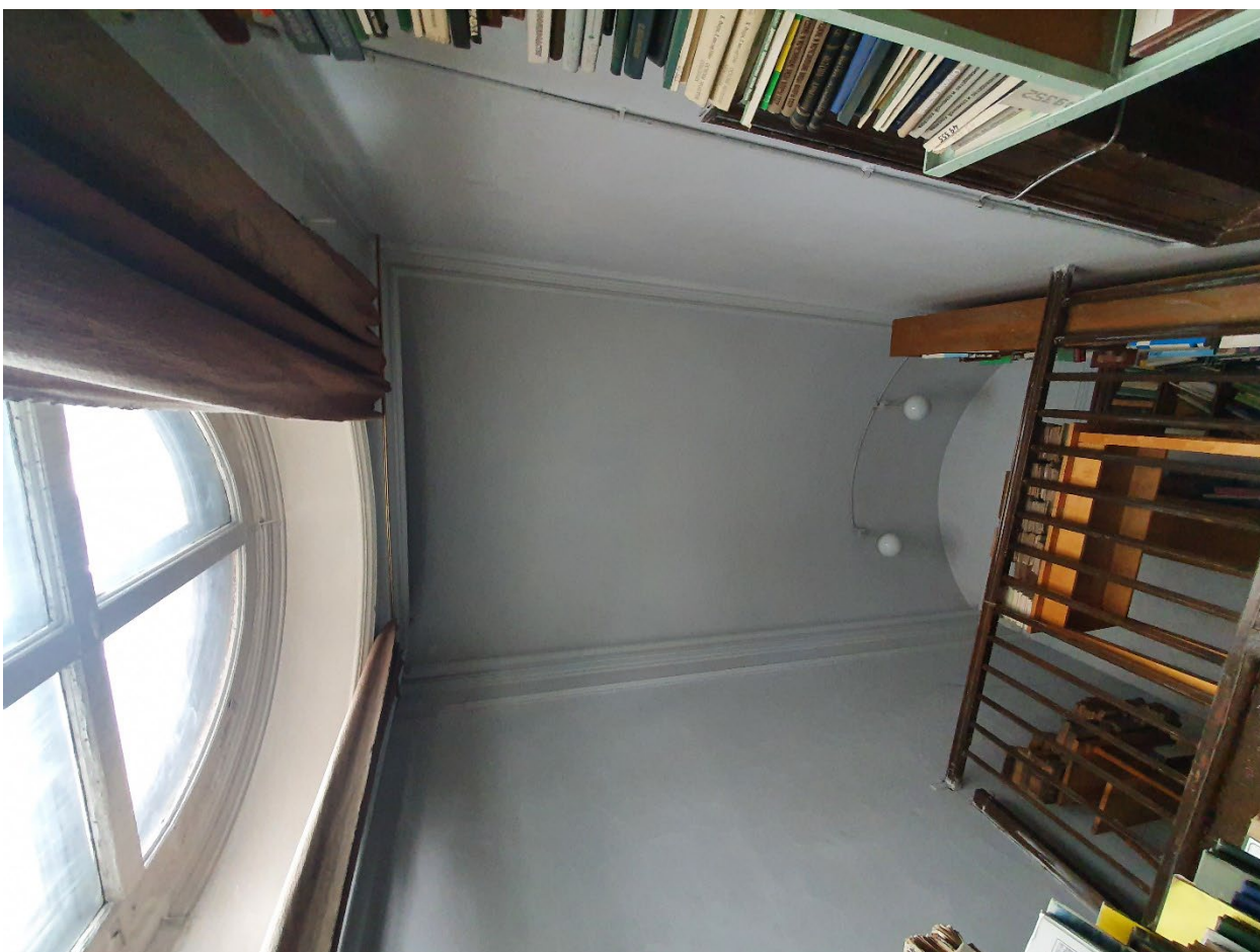
9. Помещение №13 (5Н) в уровне 1-го этажа объекта культурного наследия федерального значения «Дом министра государственных имуществ», расположенного по адресу: г. Санкт-Петербург, Большая Морская ул., д. 44, литера А. 26.10.2021
