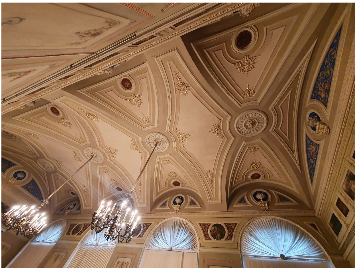
22. Помещение №20 (27Н) объекта культурного наследия федерального значения «Дом министра государственных имуществ», расположенного по адресу: г. Санкт-Петербург, Большая Морская ул., д. 44, литера А. 26.10.2021
