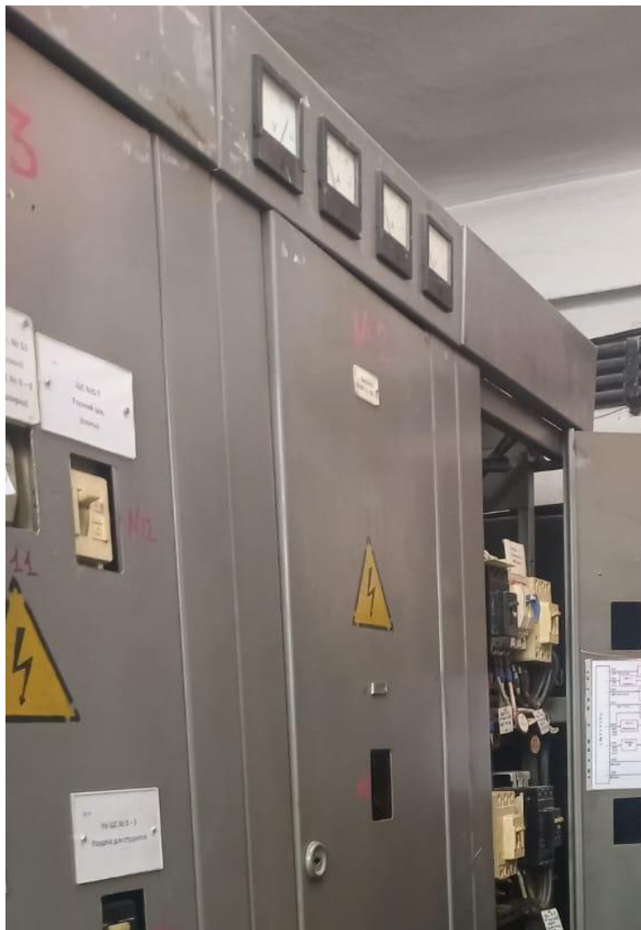
34. Объект культурного наследия «Здание школы» по адресу: Санкт-Петербург, Балтийская ул., д. 35, лит. А (Балтийская ул., 35). Столовая. Помещение электрощитовой (помещение №38). Фрагмент интерьера.
