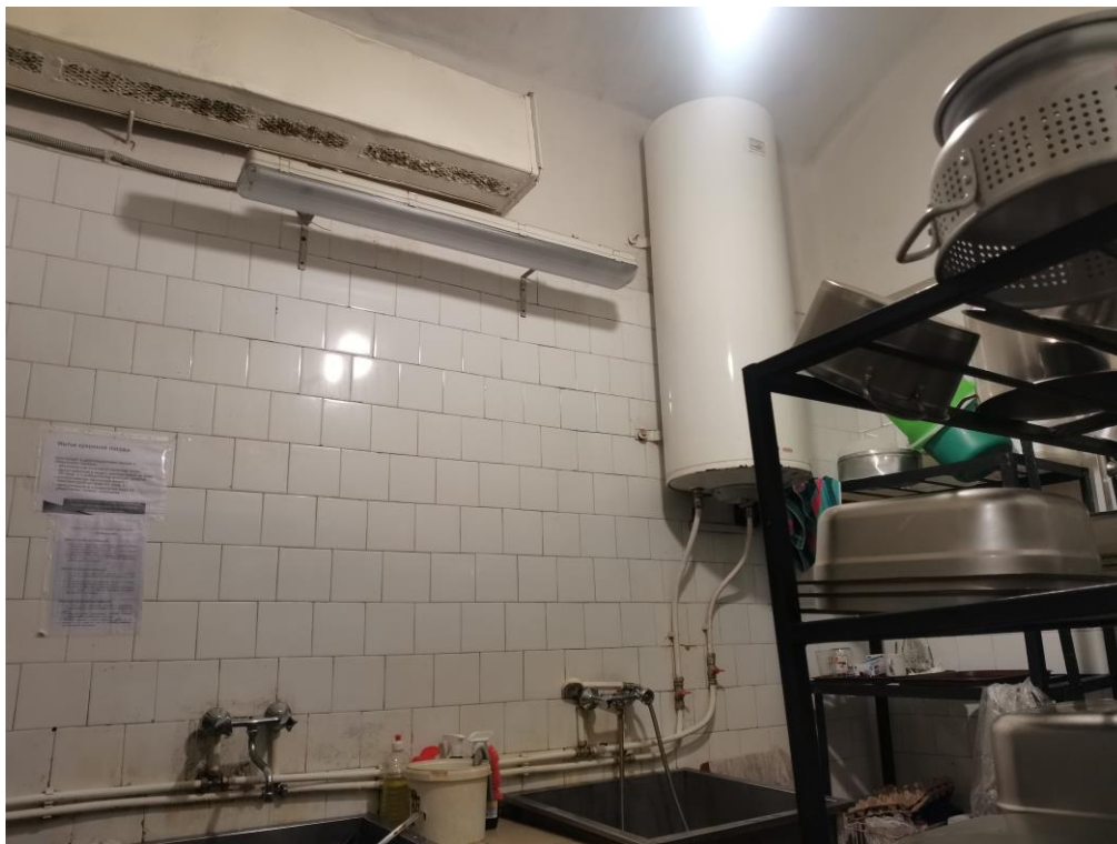
20. Объект культурного наследия «Здание школы» по адресу: Санкт-Петербург, Балтийская ул., д. 35, лит. А (Балтийская ул., 35). Столовая. Моечная (помещение №37).
