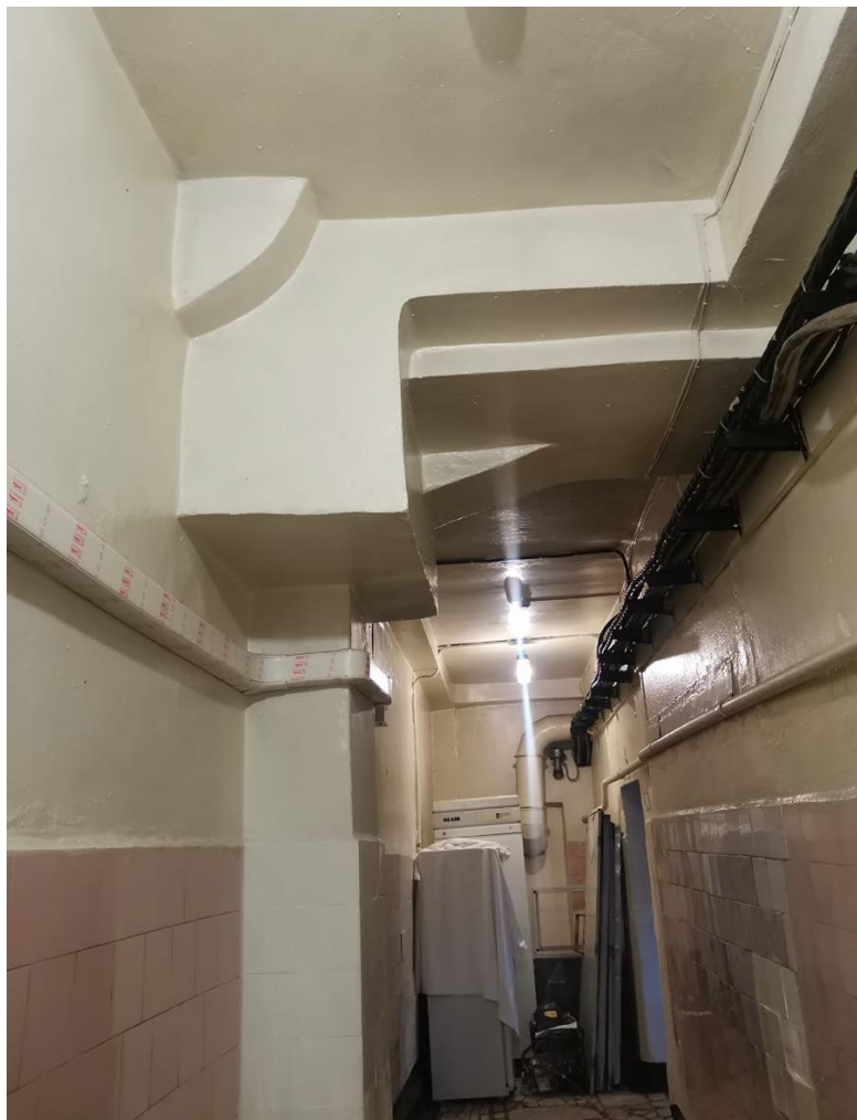
19. Объект культурного наследия «Здание школы» по адресу: Санкт-Петербург, Балтийская ул., д. 35, лит. А (Балтийская ул., 35). Столовая. Фрагмент помещения с аркой с опорой на пилоны. Коридор (помещение №33).
