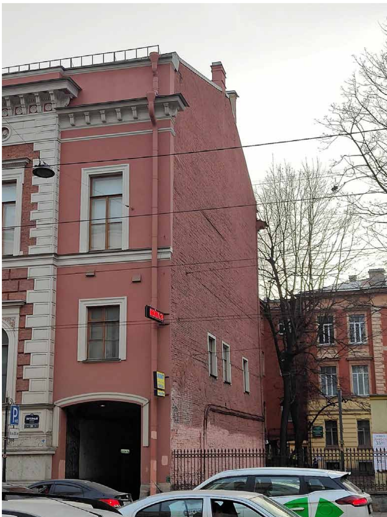
Фото 3 Брандмаурная стена (северная часть здания) объекта культурного наследия федерального значения «Главное здание», входящего в состав объекта культурного наследия федерального значения «Дом Пашкова И.В. (дом Департамента уделов)»
