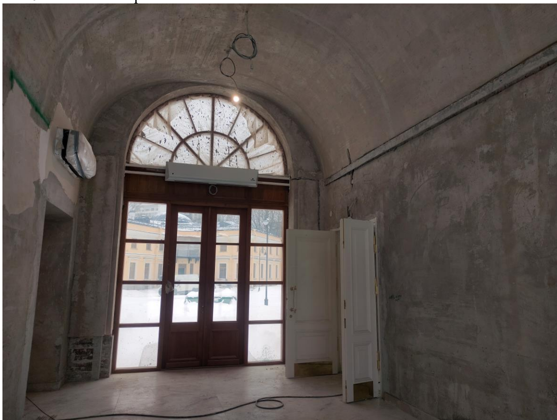
Фото 24. Объект культурного наследия федерального значения «Корпус служебный», расположенный по адресу: Санкт-Петербург, Уткин проспект, дом 2, литера Б. Фрагмент пом. № 1.01 в отметке первого этажа.
