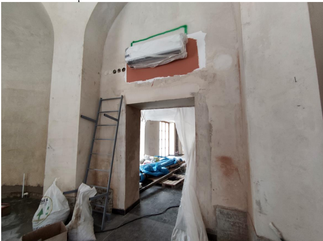
Фото 16. Объект культурного наследия федерального значения «Корпус служебный», расположенный по адресу: Санкт-Петербург, Уткин проспект, дом 2, литера Б. Общий вид пом. № 1.12 в отметке первого этажа.
