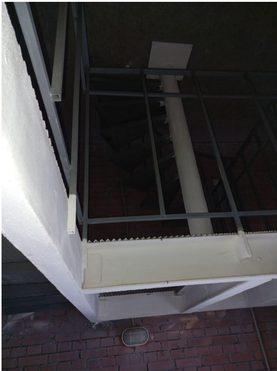
Фото 46. Объект культурного наследия федерального значения «Корпус служебный», расположенный по адресу: Санкт-Петербург, Уткин проспект, дом 2, литера Б. Фрагмент пом. № 3.01 (флагшточная башня) с отметки +8.560.
