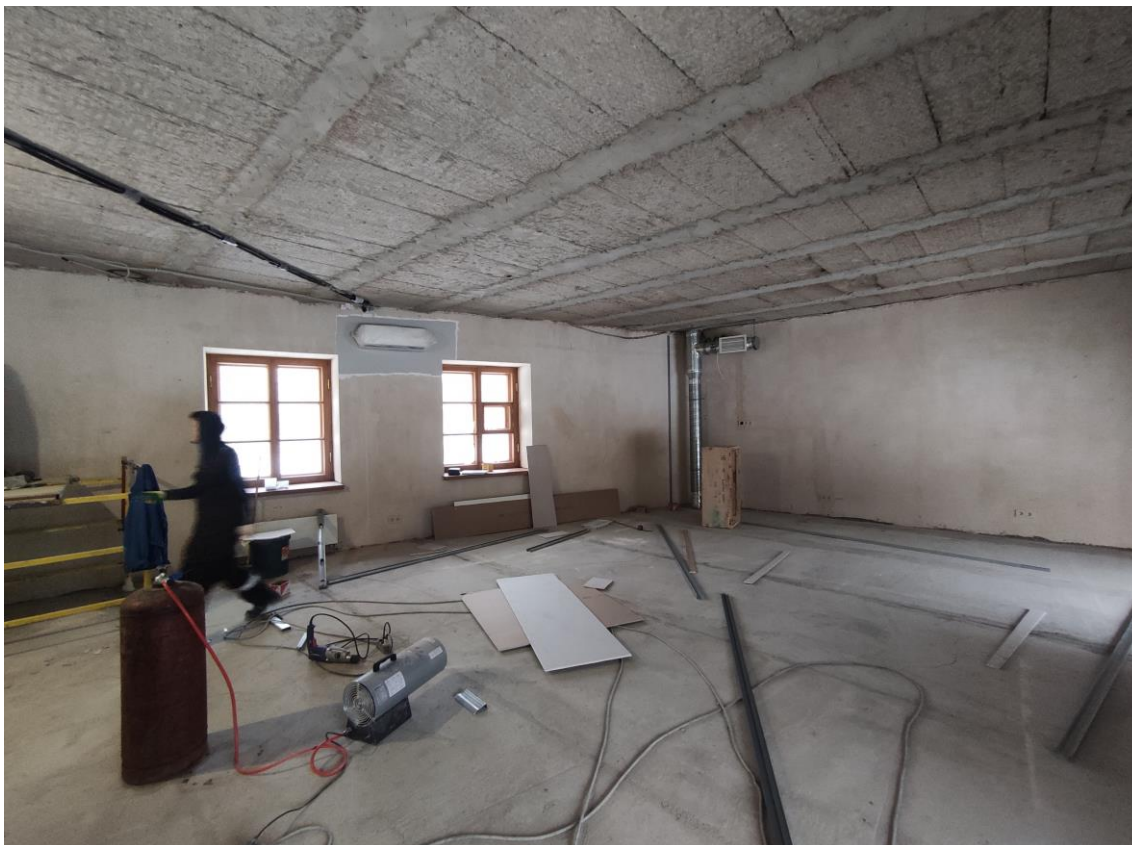
Фото 43. Объект культурного наследия федерального значения «Корпус служебный», расположенный по адресу: Санкт-Петербург, Уткин проспект, дом 2, литера Б. Общий вид пом. № 2.08 в отметке второго этажа.
