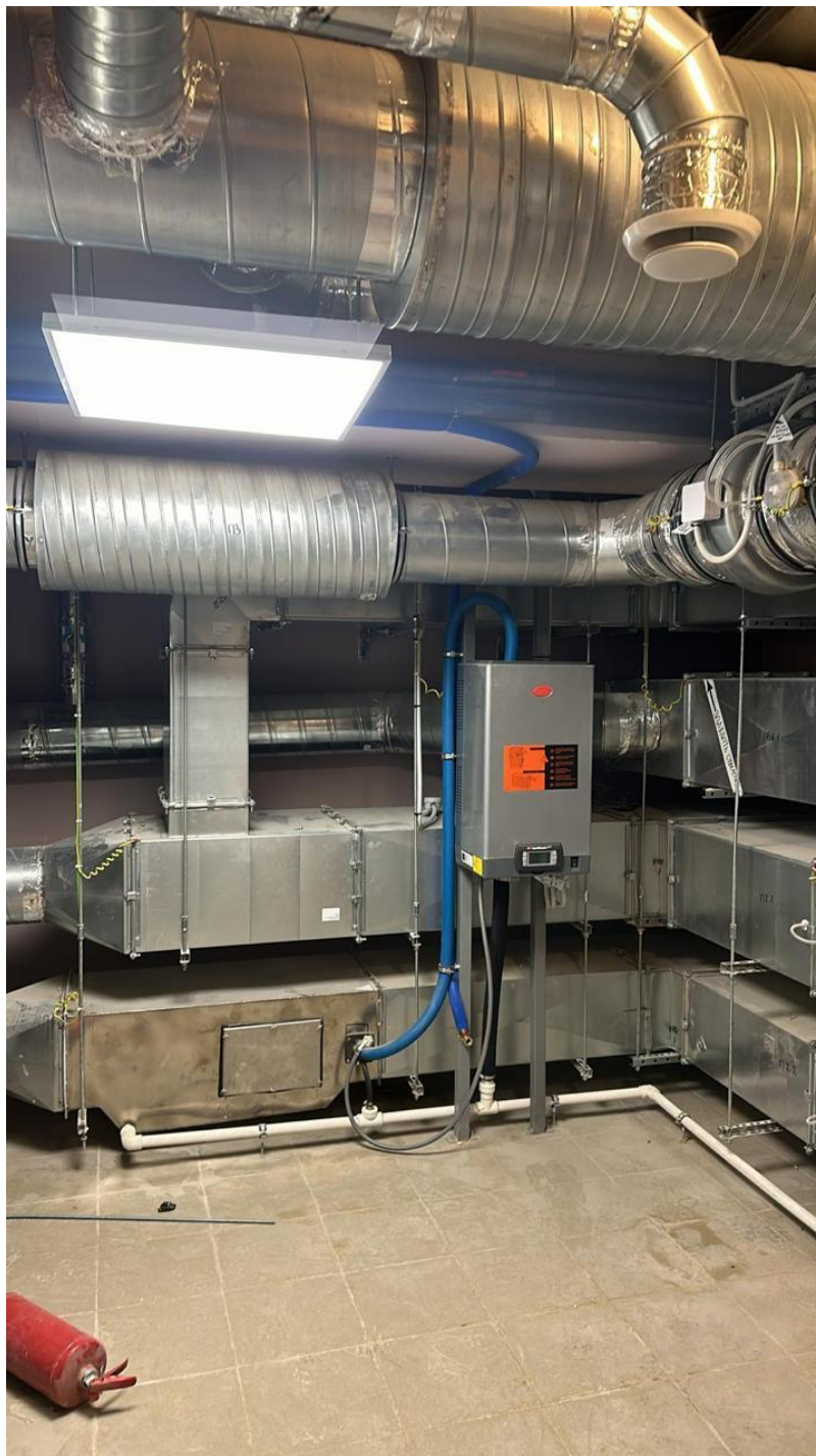
Фото 45. Объект культурного наследия федерального значения «Корпус служебный», расположенный по адресу: Санкт-Петербург, Уткин проспект, дом 2, литера Б. Общий вид пом. № 2.14 в отметке второго этажа (венткамера).
