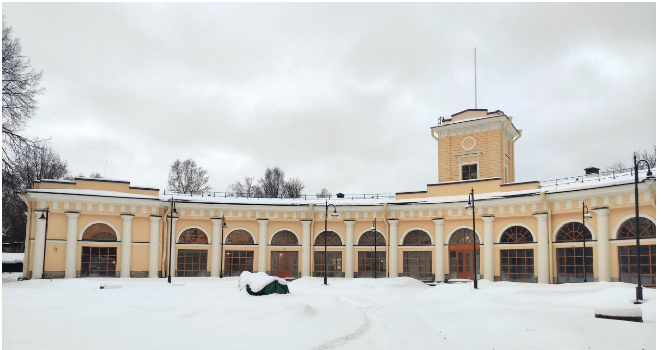
Фото 7. Объект культурного наследия федерального значения «Корпус служебный», расположенный по адресу: Санкт-Петербург, Уткин проспект, дом 2, литера Б. Фрагмент западного фасада, северная часть.
