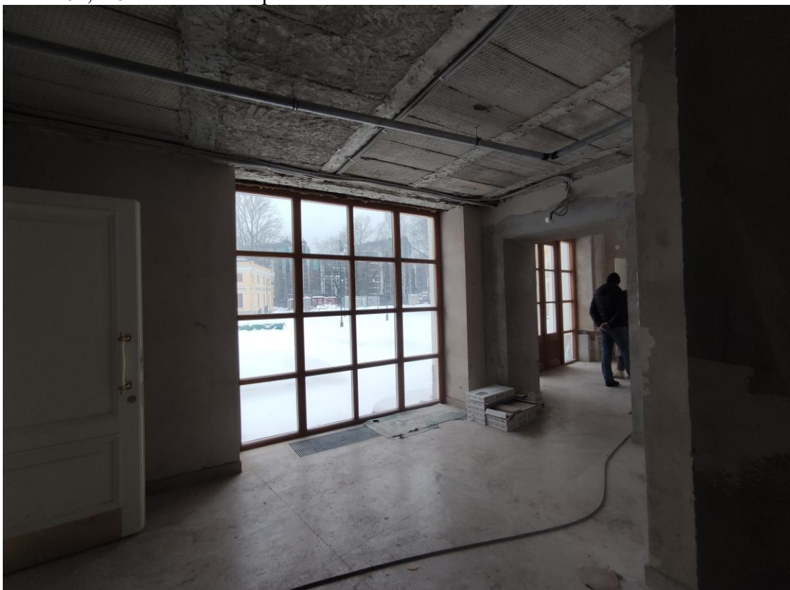
Фото 20. Объект культурного наследия федерального значения «Корпус служебный», расположенный по адресу: Санкт-Петербург, Уткин проспект, дом 2, литера Б. Общий вид пом. № 1.02 в отметке первого этажа.
