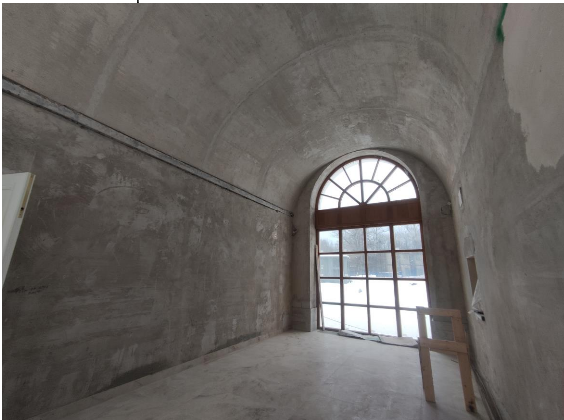
Фото 22. Объект культурного наследия федерального значения «Корпус служебный», расположенный по адресу: Санкт-Петербург, Уткин проспект, дом 2, литера Б. Общий вид пом. № 1.01 в отметке первого этажа.
