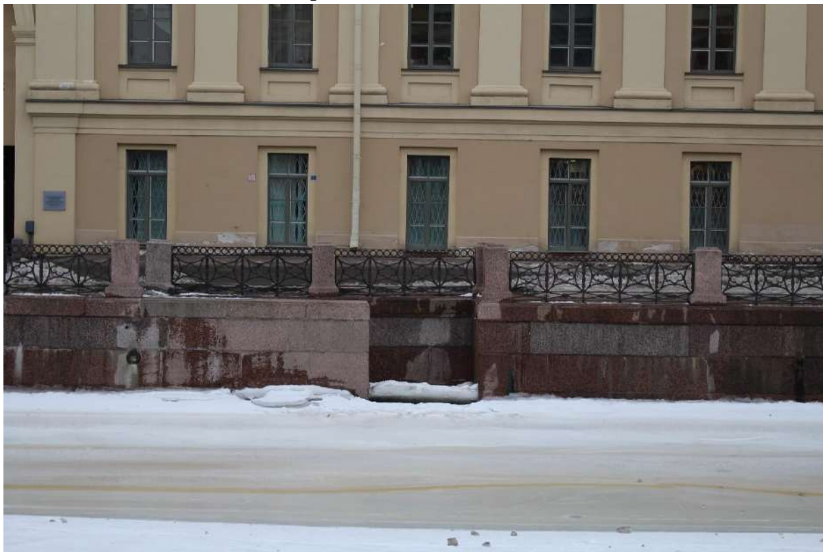
Фото 1. Вид на спуск № 18 объекта культурного наследия федерального значения «Набережные со спусками» на уч. наб. р. Мойки «Почтамтский мост - Поцелуев мост», литера Б с северо-запада.
