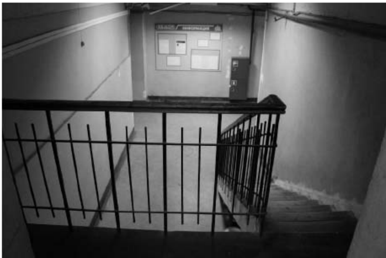
Фото 249. Выявленный объект культурного наследия «Манеж с конюшнями». Центральный и западный Т-образный объемы конюшен. Интерьер северной лестничной клетки в уровне 3-го этажа. Фото 11.12.2023 г.
