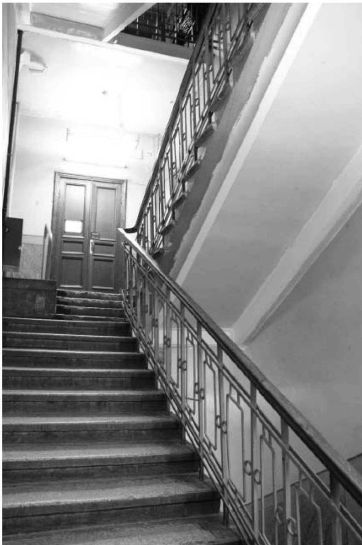
Фото 240. Выявленный объект культурного наследия «Манеж с конюшнями». Центральный и западный Т-образный объемы конюшен. Интерьер восточной лестничной клетки в уровне 3-го этажа. Фото 11.12.2023 г.
