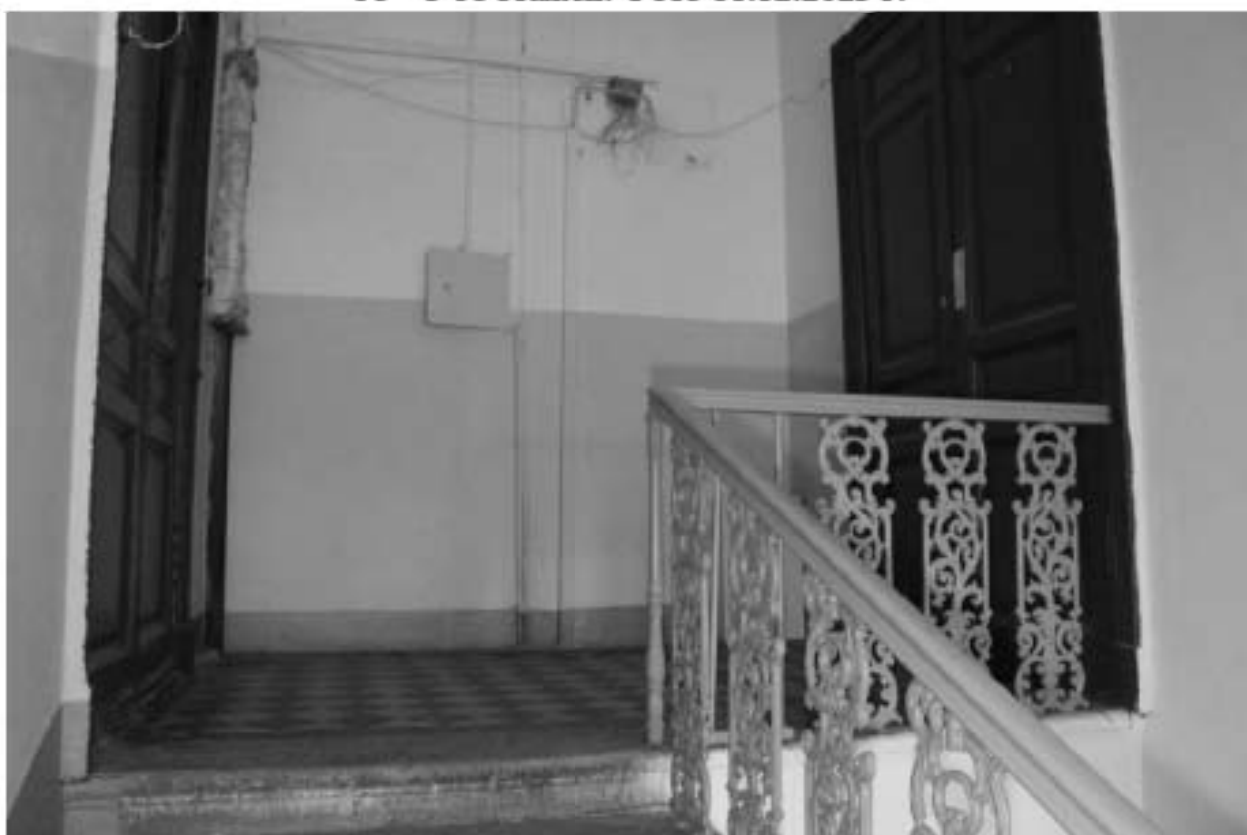
Фото 61. Выявленный объект культурного наследия «Жилой офицерский дом со службой и оградой». Жилой офицерский дом. Вид на интерьер 4ЛК в уровне 3-го этажа. Фото 11.12.2023 г.
