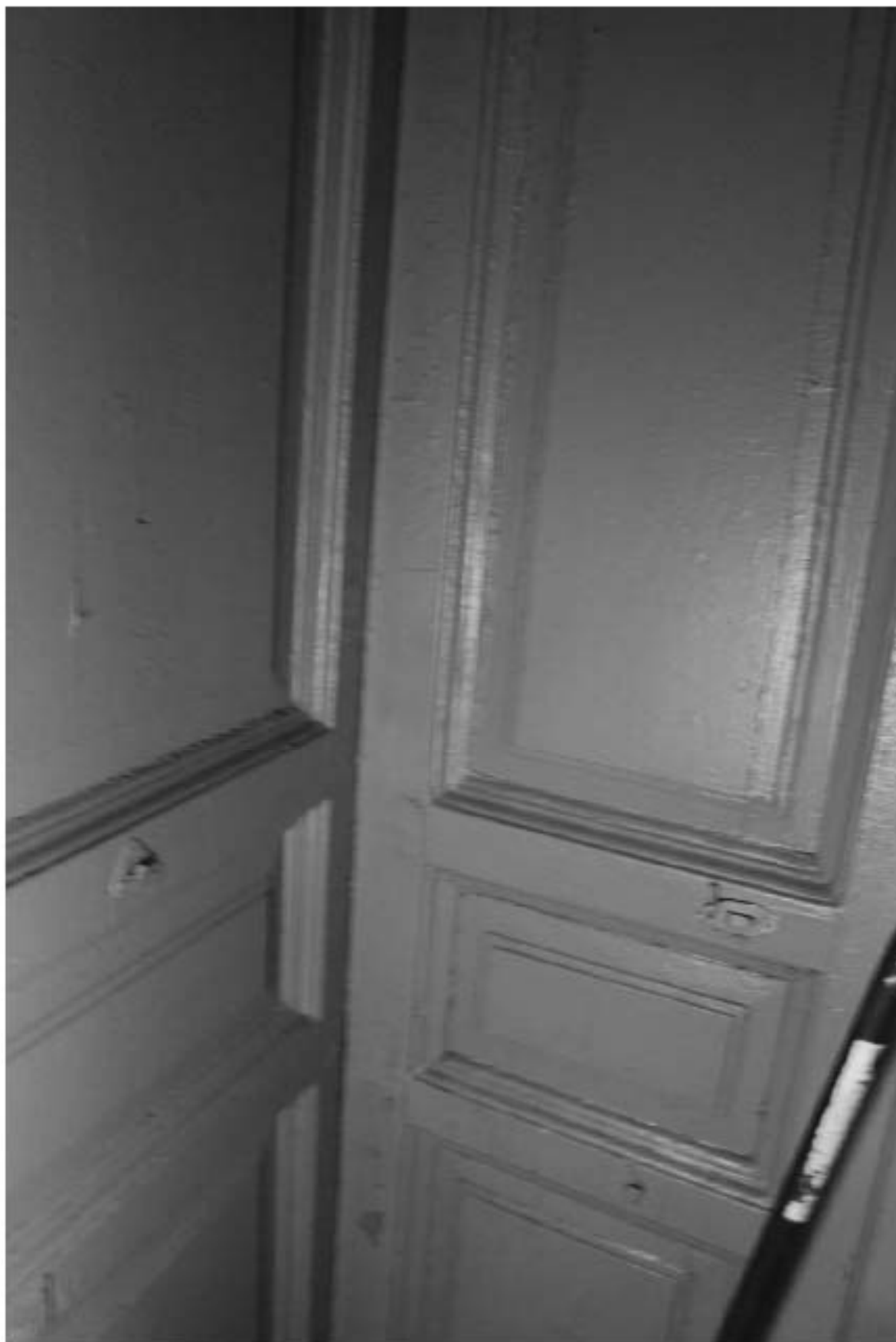
Фото 26. Выявленный объект культурного наследия «Жилой офицерский дом со службой и оградой». Жилой офицерский дом. Вид на интерьер 1ЛК в уровне 1-го этажа. Фото 11.12.2023 г.
