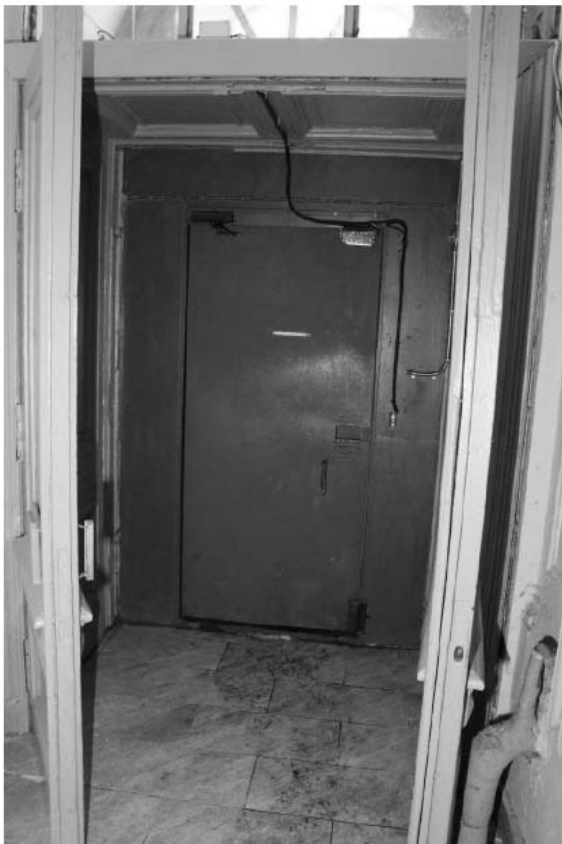
Фото 38. Выявленный объект культурного наследия «Жилой офицерский дом со службой и оградой». Жилой офицерский дом. Вид на интерьер 2ЛК в уровне 1-го этажа. Фото 11.12.2023 г.
