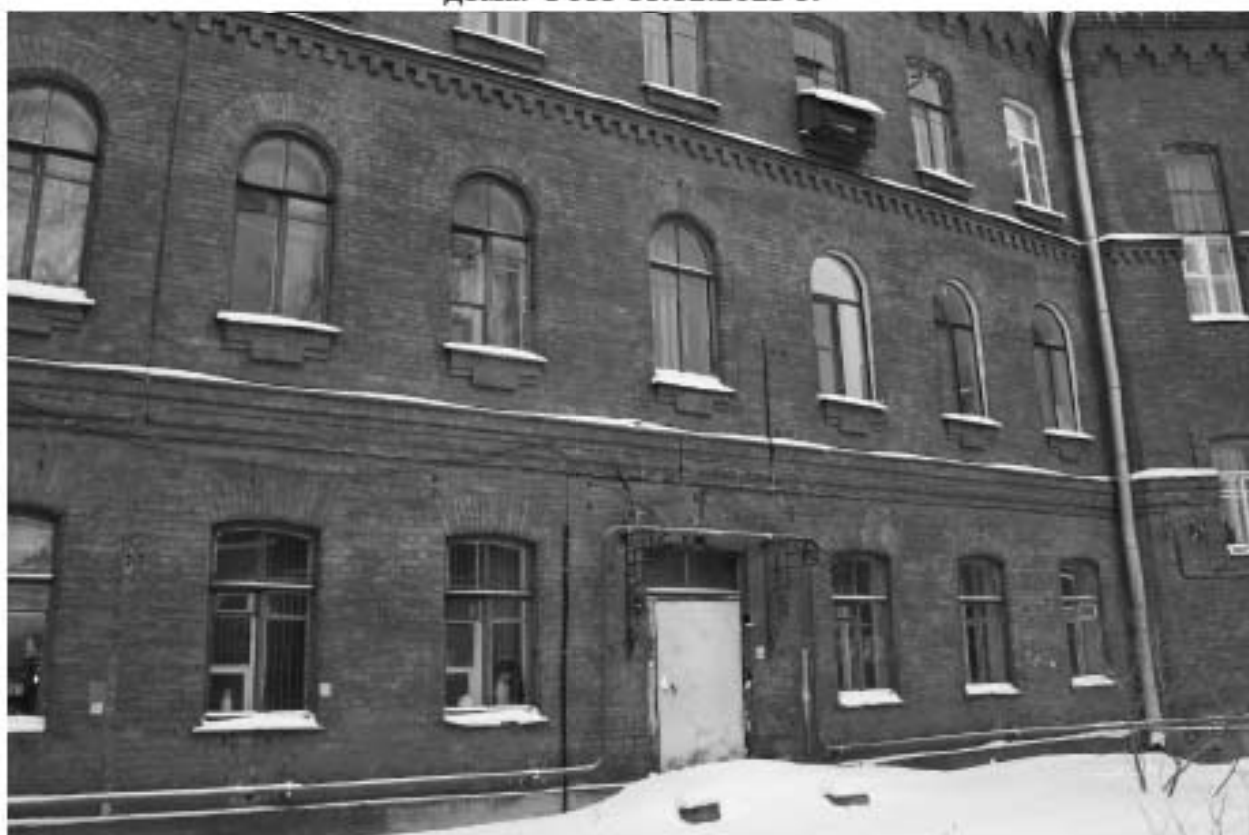
Фото 14. Выявленный объект культурного наследия «Жилой офицерский дом со службой и оградой». Вид на северный дворовый фасад жилого офицерского дома. Фото 11.12.2023 г.
