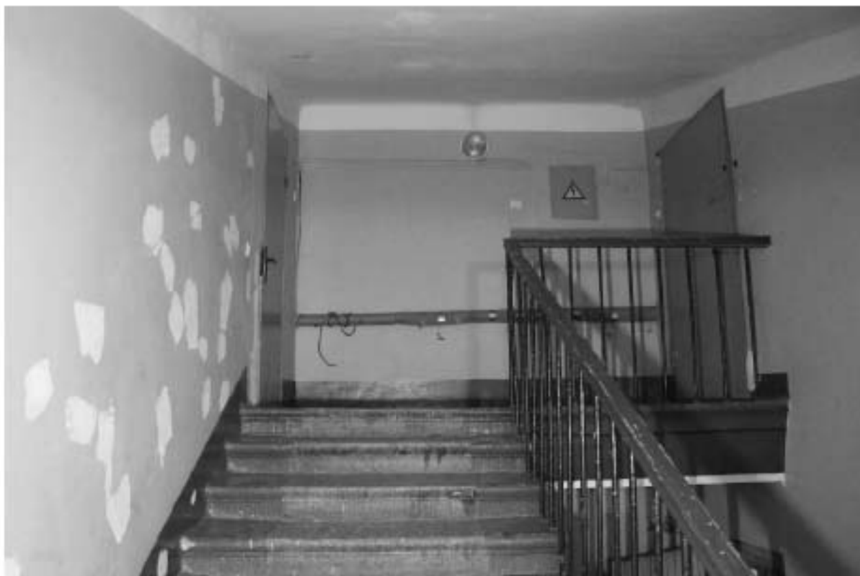
Фото 362. Выявленный объект культурного наследия «Саран для артиллерии». Восточная лестничная клетка в уровне чердачного этажа. Фото 25.01.2024 г.
