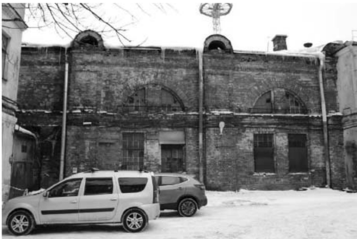
Фото 174. Выявленный объект культурного наследия «Манеж с конюшнями». Вид на северный фасад манежа. Фото 11.12.2023 г.
