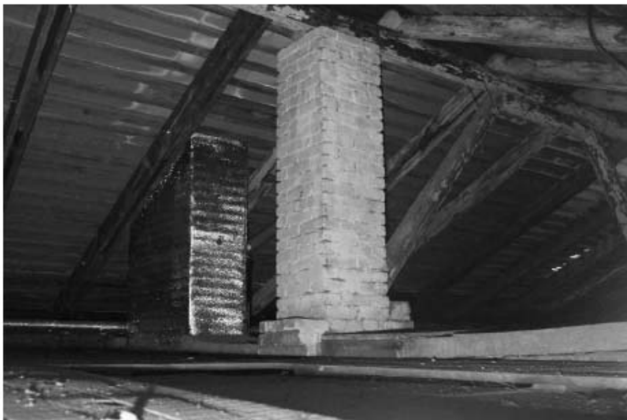
Фото 147. Выявленный объект культурного наследия «Казармы со службой». Служба. Интерьер чердачного помещения. Фото 11.12.2023 г.
