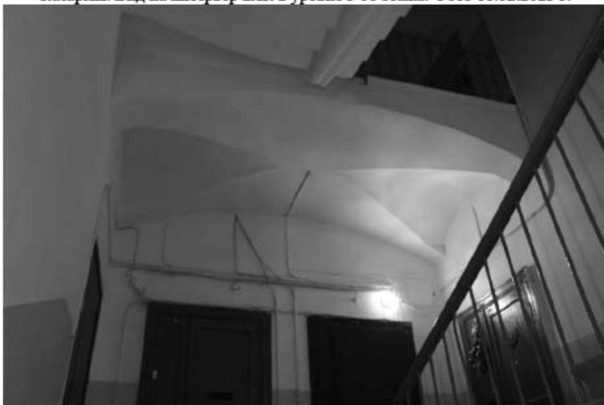
Фото 115. Выявленный объект культурного наследия «Казармы со службой». Казармы. Вид на интерьер 2ЛК в уровне 3-го этажа. Фото 11.12.2023 г.
