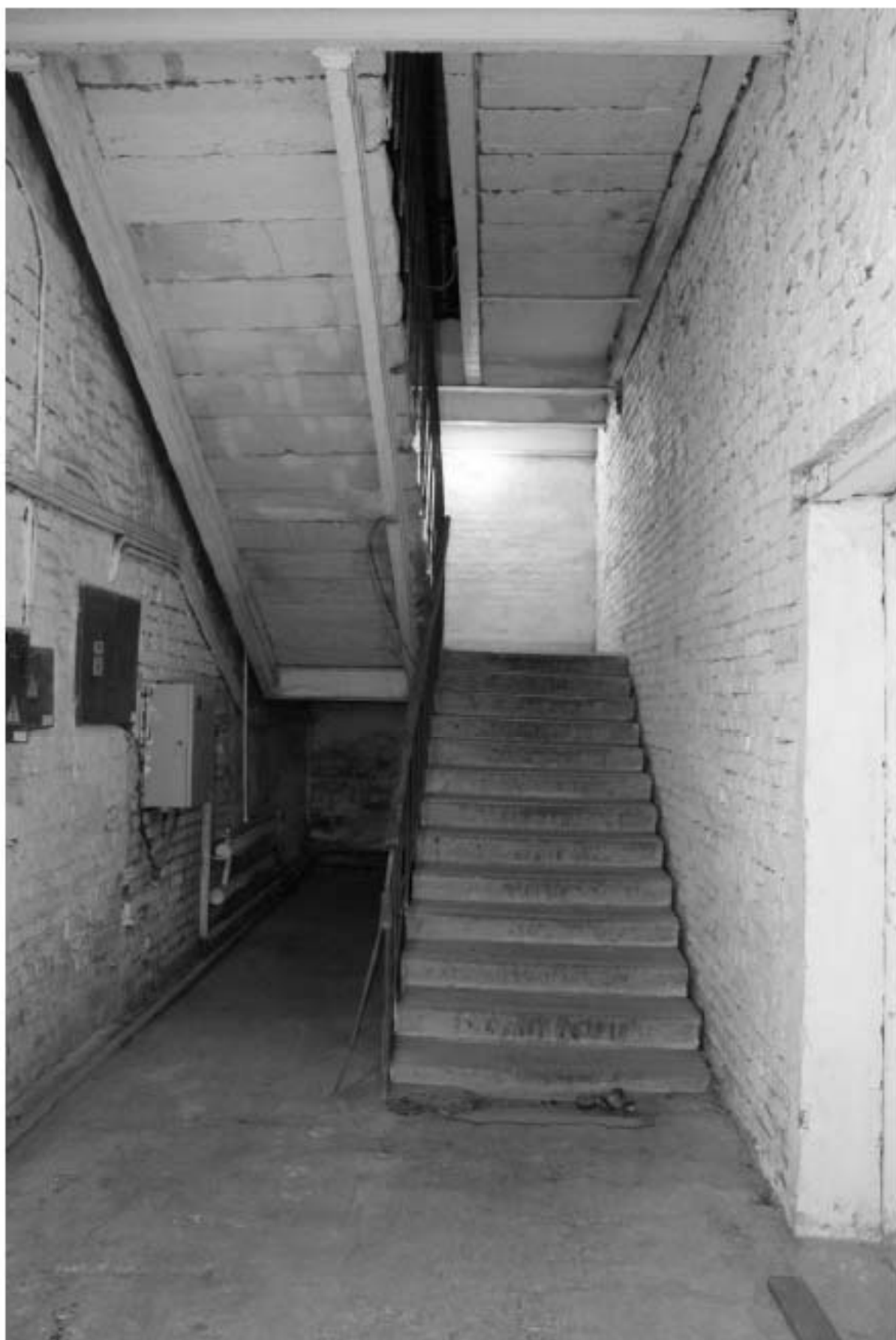
Фото 206. Выявленный объект культурного наследия «Манеж с конюшнями». Восточный Т-образный объем конюшен. Интерьер внутренних помещений 1-го этажа. Фото 11.12.2023 г.
