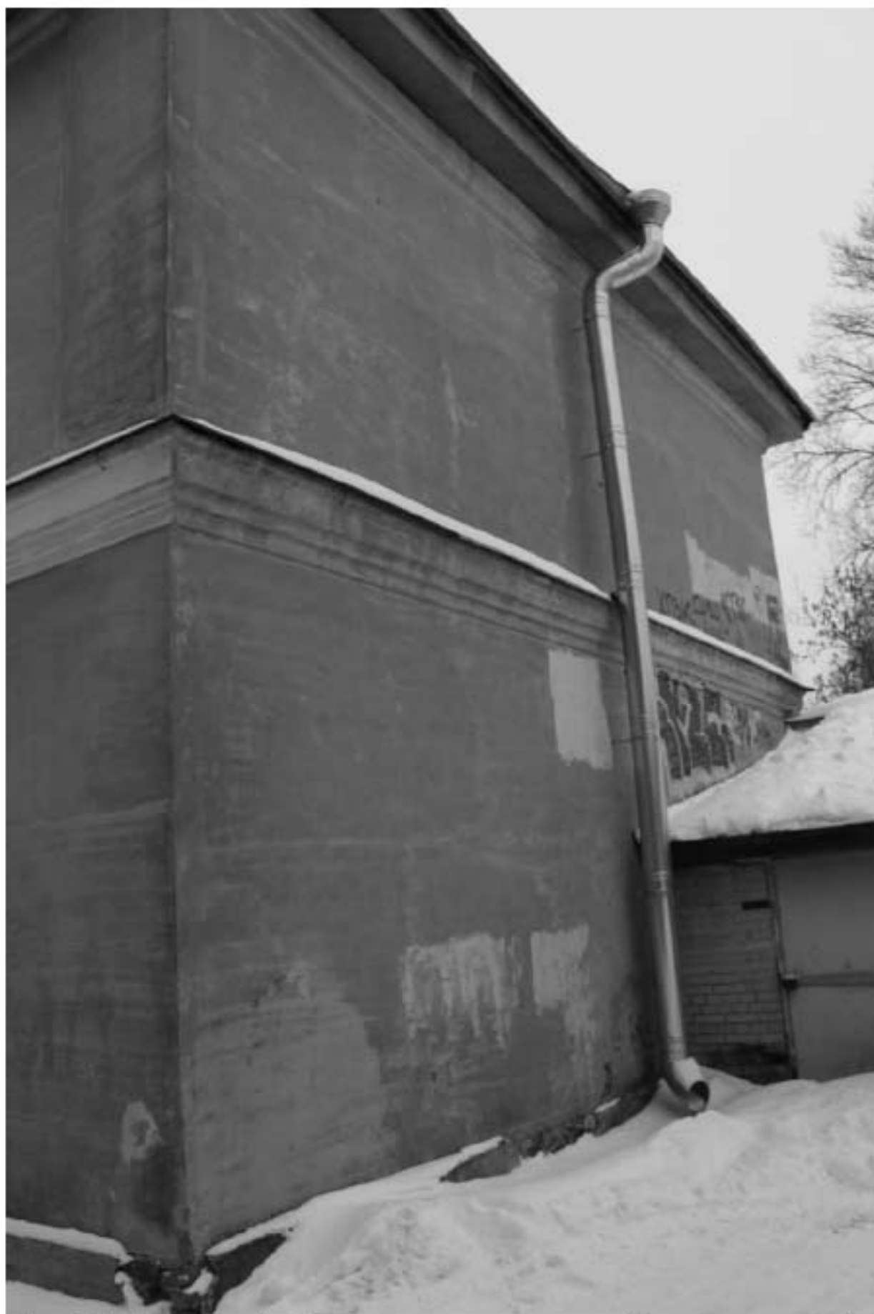
Фото 128. Выявленный объект культурного наследия «Казармы со службой». Вид на восточный фасад службы. Фото 11.12.2023 г.
