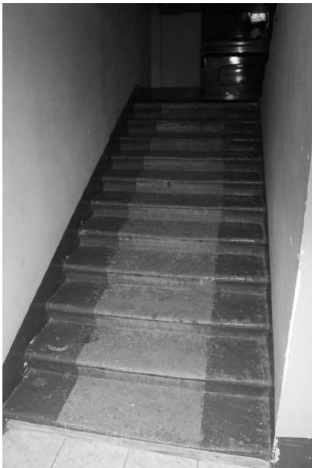
Фото 358. Выявленный объект культурного наследия «Саран для артиллерии». Восточная лестничная клетка в уровне 1-го – 2-го этажей. Фото 25.01.2024 г.
