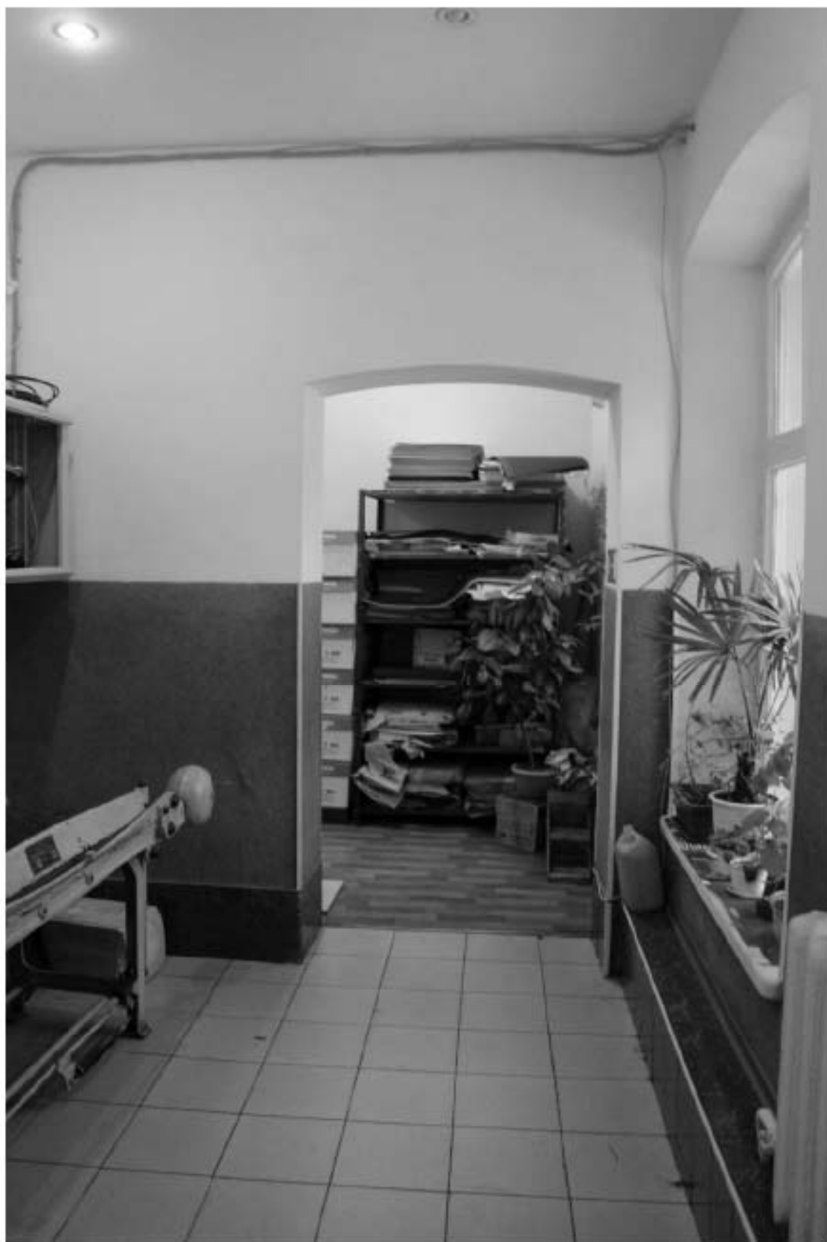
Фото 368. Выявленный объект культурного наследия «Сарай для артиллерии». Интерьер внутренних помещений 1-го этажа. Фото 25.01.2024 г.
