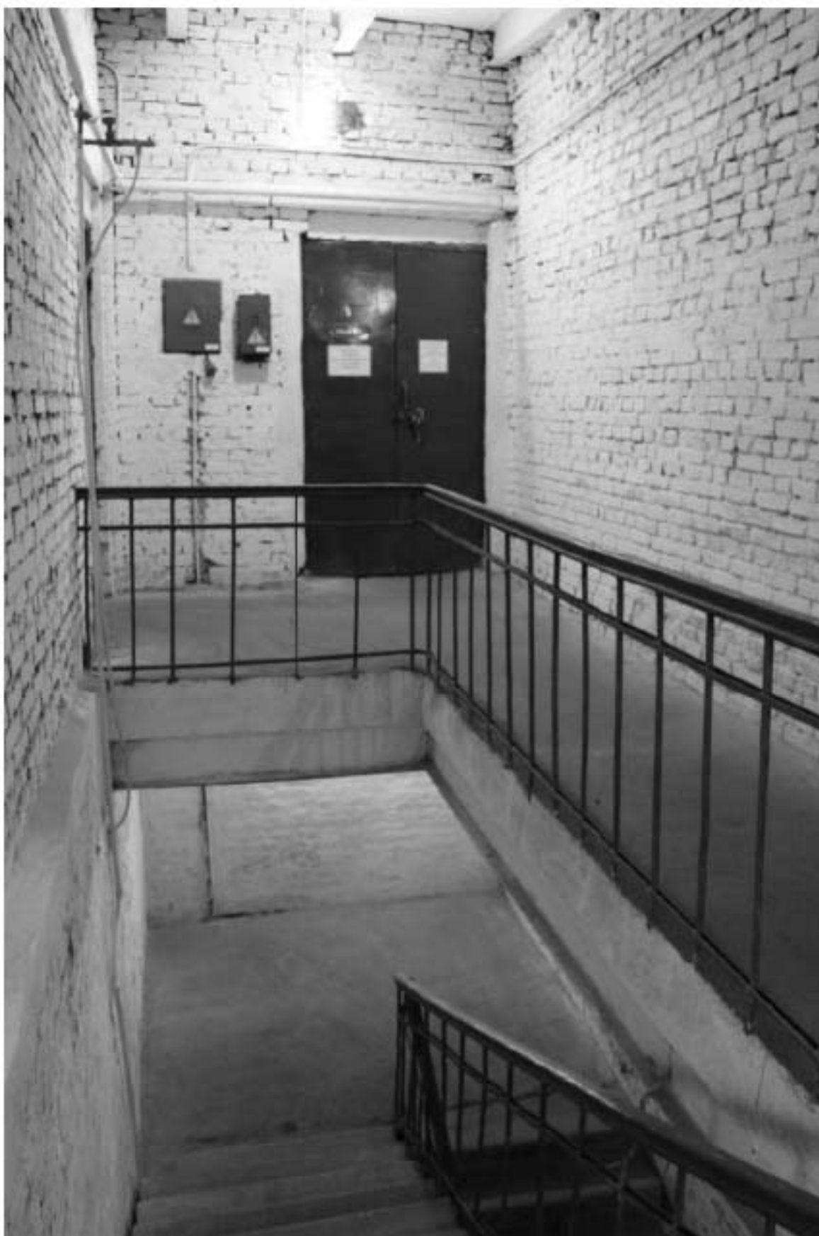
Фото 209. Выявленный объект культурного наследия «Манеж с конюшнями». Восточный Т-образный объем конюшен. Интерьер внутренних помещений 2-го этажа. Фото 11.12.2023 г.
