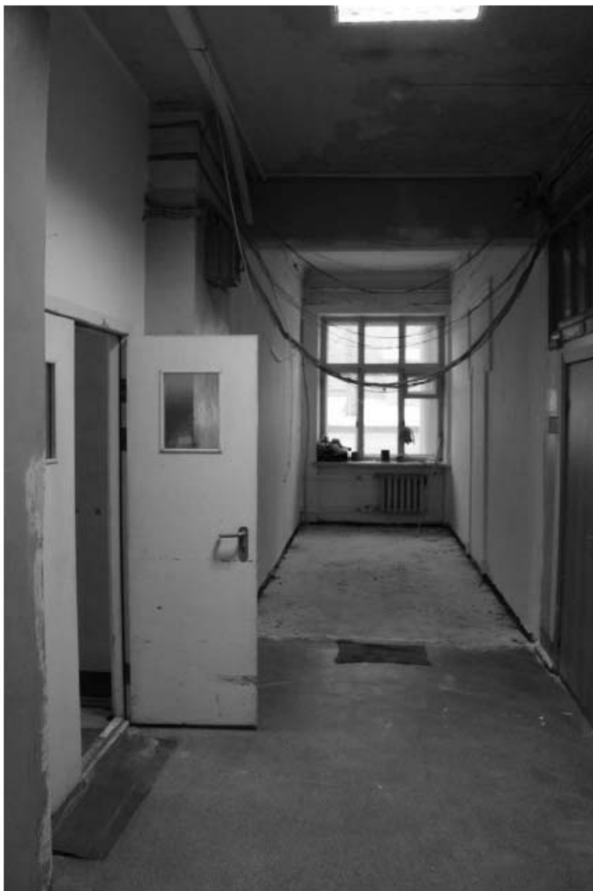
Фото 273. Выявленный объект культурного наследия «Манеж с конюшнями». Центральный и западный Т-образный объемы конюшен. Интерьер внутренних помещений 2-го этажа. Фото 11.12.2023 г.
