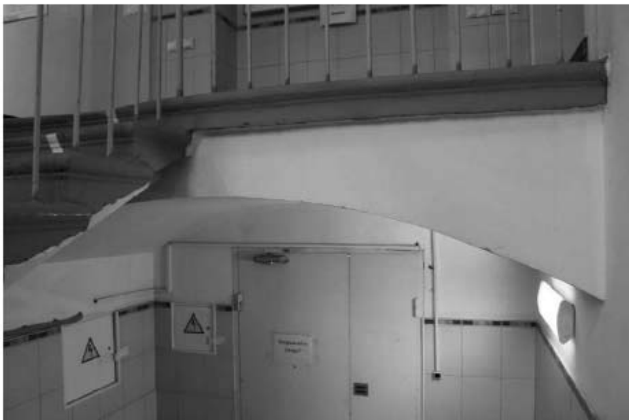
Фото 354. Выявленный объект культурного наследия «Саран для артиллерии». Западная лестничная клетка в уровне 1-го – 2-го этажей. Фото 25.01.2024 г.
