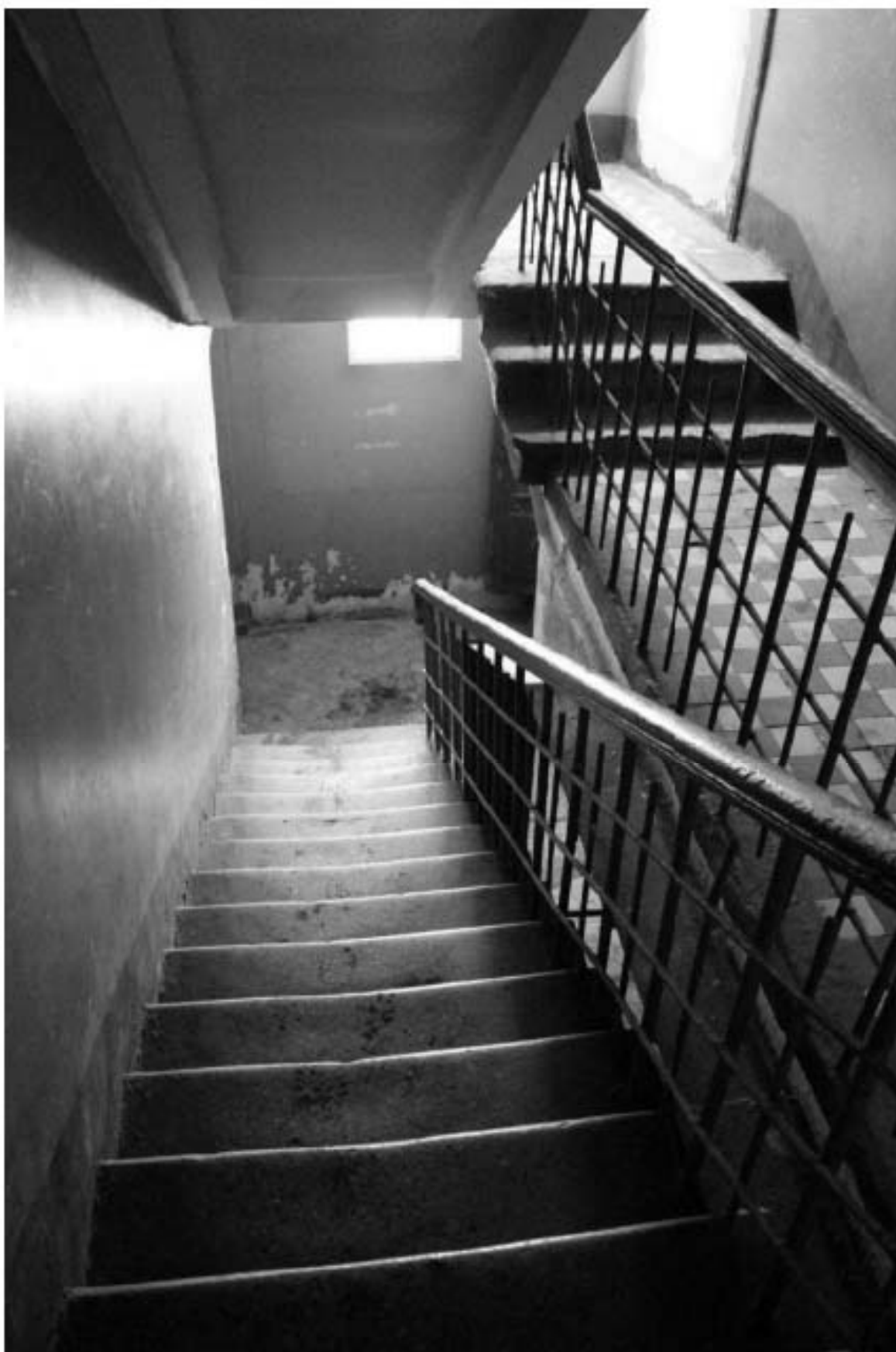
Фото 254. Выявленный объект культурного наследия «Манеж с конюшнями». Центральный и западный Т-образный объемы конюшен. Интерьер западной лестничной клетки в уровне 1-го – 2-го этажей. Фото 11.12.2023 г.
