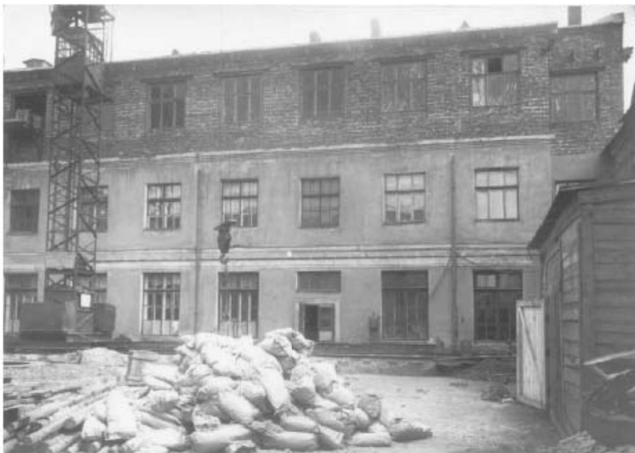
Илл. 116. Надстройка 3-го этажа в ходе 1-й очереди реконструкции корпуса № 1. 1958 г. (источник: предоставлено заказчиком).
