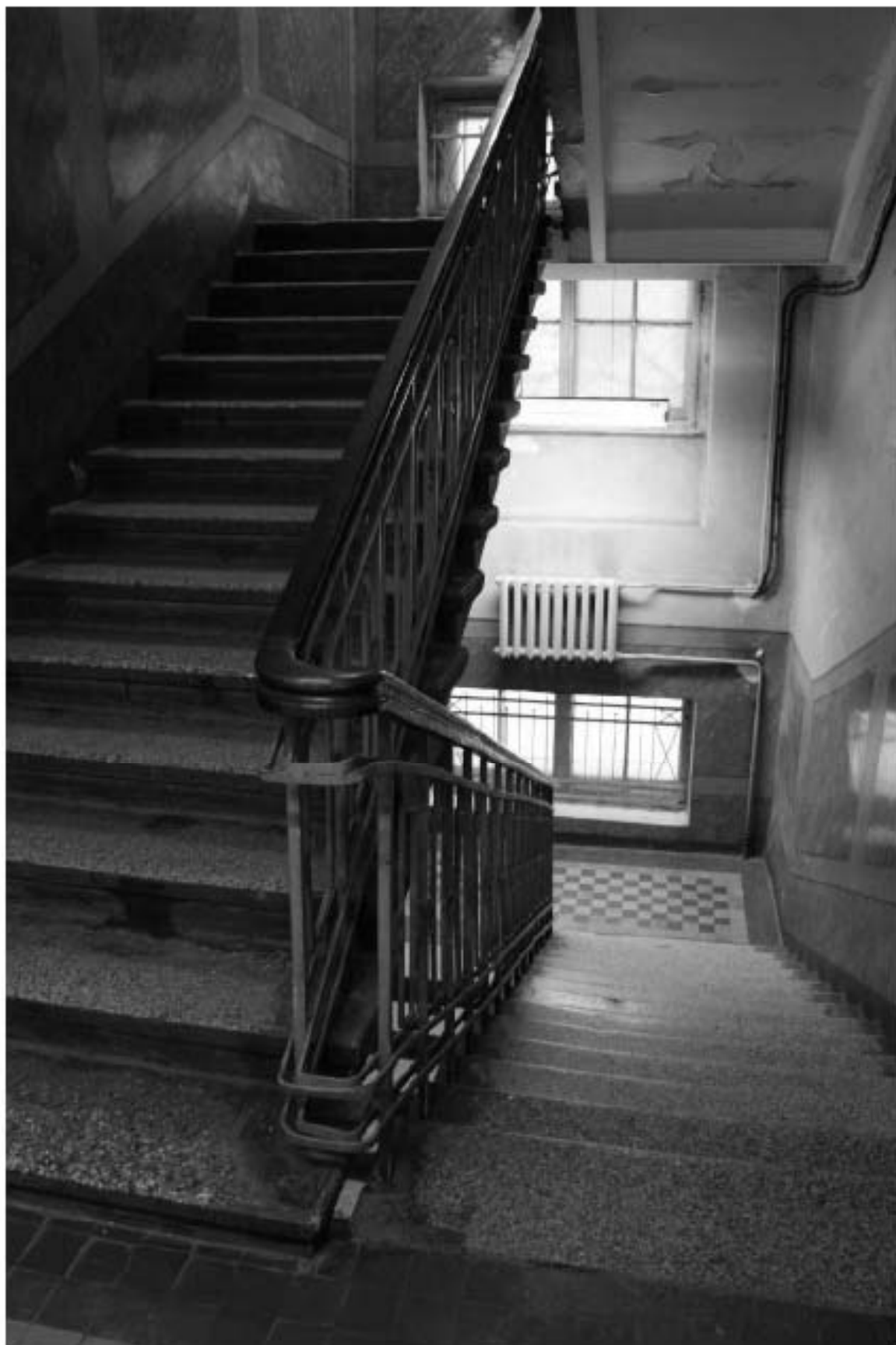
Фото 238. Выявленный объект культурного наследия «Манеж с конюшнями». Центральный и западный Т-образный объемы конюшен. Интерьер восточной лестничной клетки в уровне 2-го этажа. Фото 11.12.2023 г.
