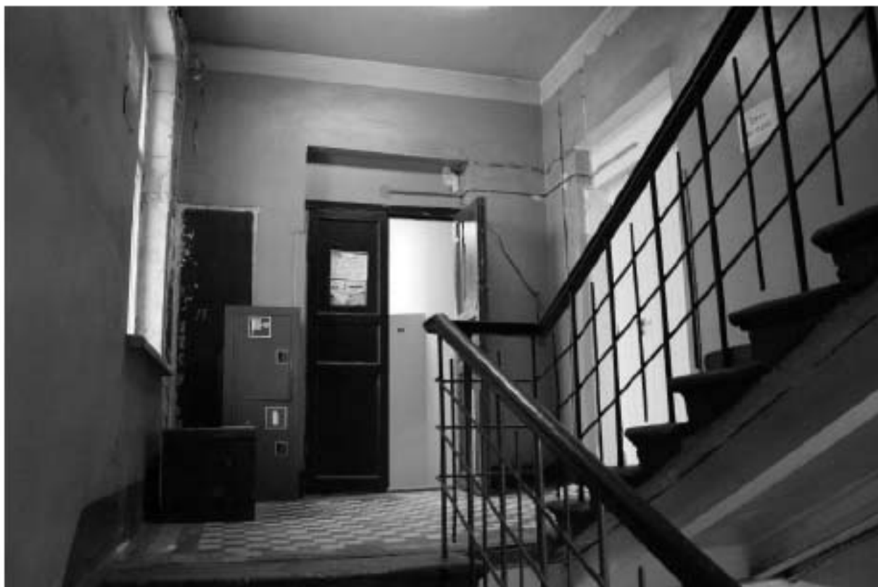
Фото 251. Выявленный объект культурного наследия «Манеж с конюшнями». Центральный и западный Т-образный объемы конюшен. Интерьер северной лестничной клетки в уровне 4-го этажа. Фото 11.12.2023 г.
