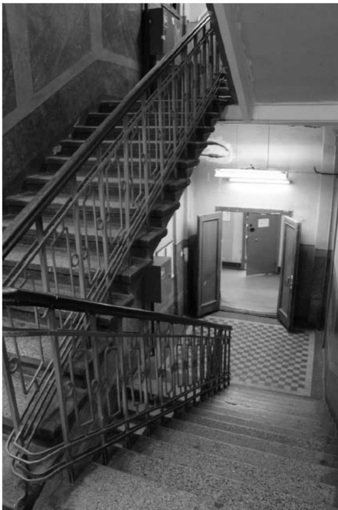
Фото 239. Выявленный объект культурного наследия «Манеж с конюшнями». Центральный и западный Т-образный объемы конюшен. Интерьер восточной лестничной клетки в уровне 2-го – 3-го этажей. Фото 11.12.2023 г.
