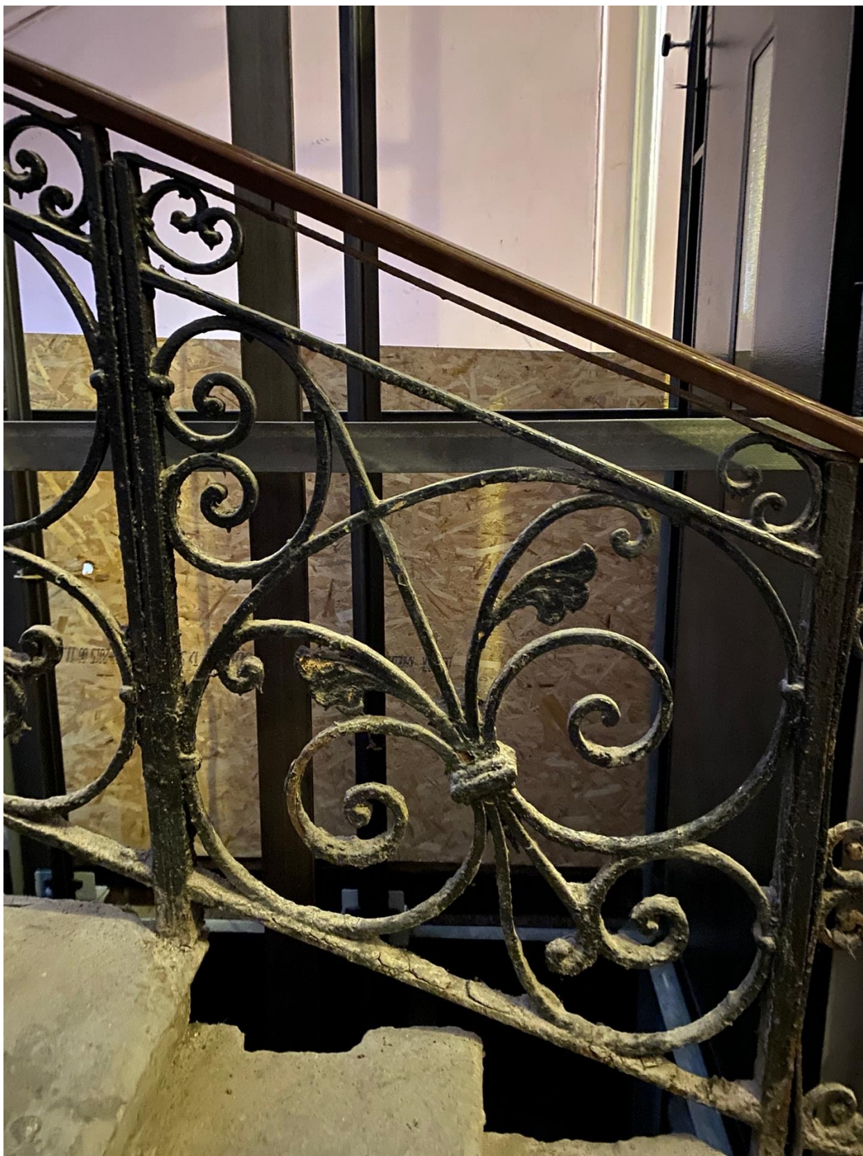
Фото 17. Вид на ограждение лестницы, ведущей в квартиру № 45, объекта культурного наследия.
