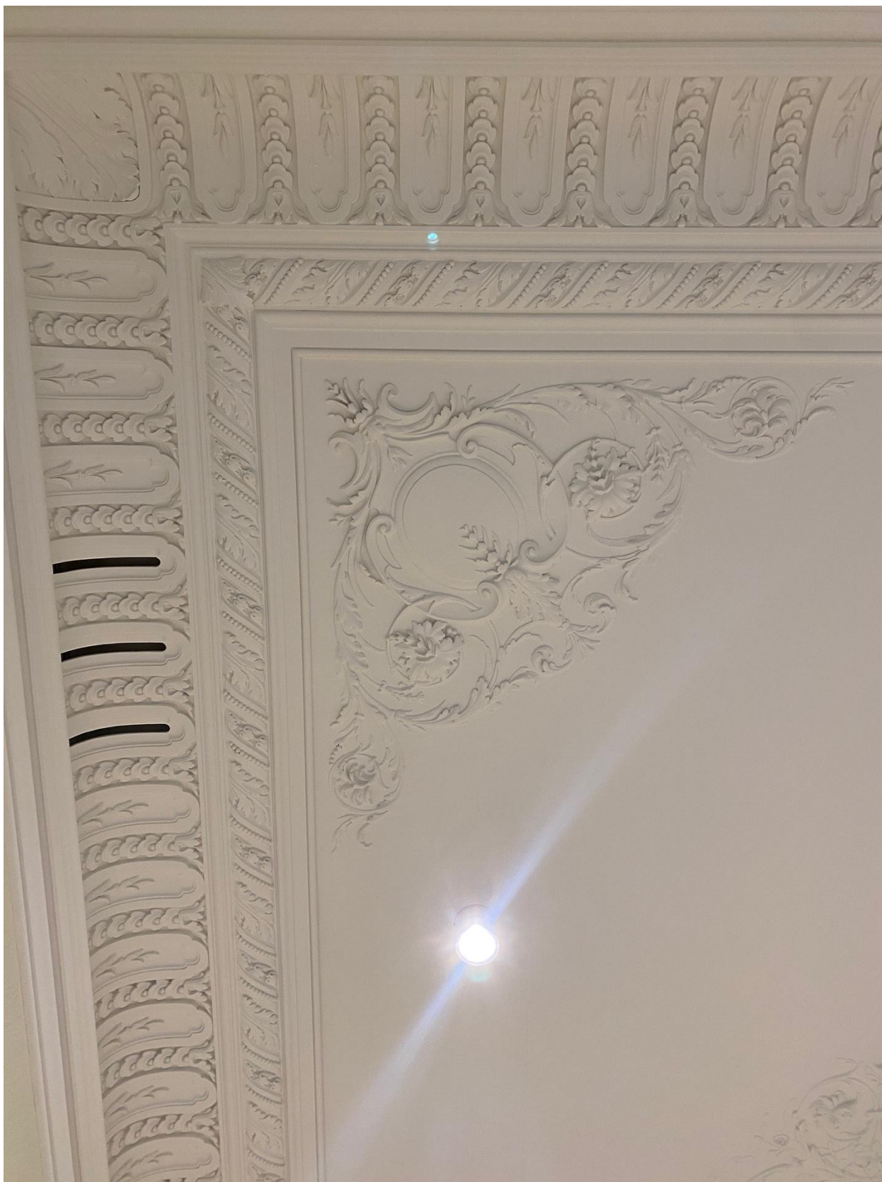
Фото 33. Фрагмент потолка помещения квартиры № 45 объекта культурного наследия.
