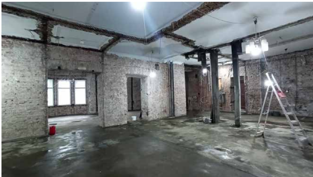
Фото 9. Интерьер квартиры № 24 объекта культурного наследия регионального значения «Дом инженера А.Ф. Циммермана (лицевой дом с палисадником, ограждением палисадника и 2 флигелями)»
