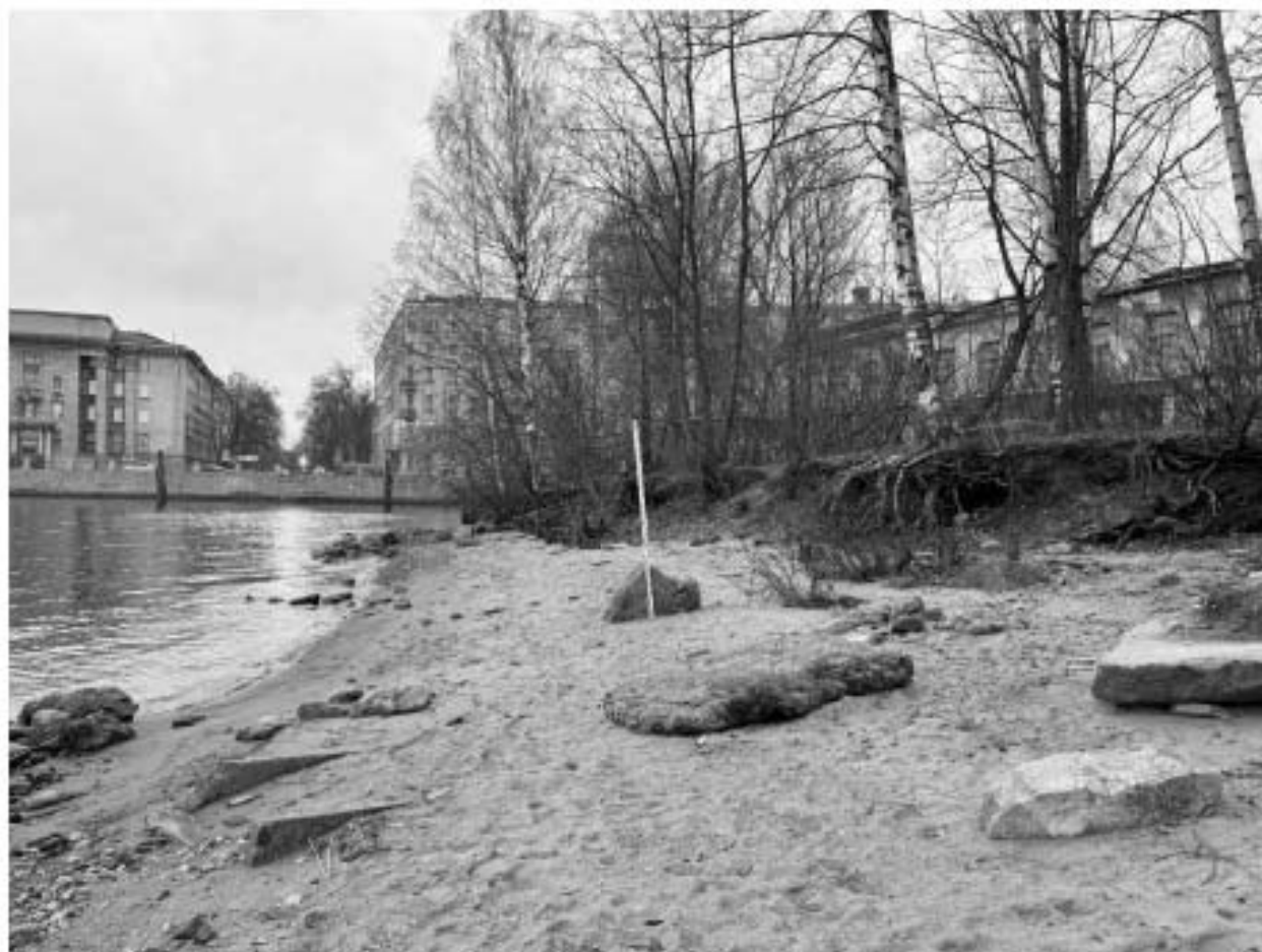
Ил. 30. Точка фотофиксации 11. Осыпи берега, состоящего из насыпного привозного грунта. Вид с С. На дальнем плане - набережная р. Смоленка.
