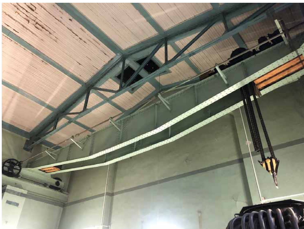
Фото 11. Оборудование в машинном зале.
