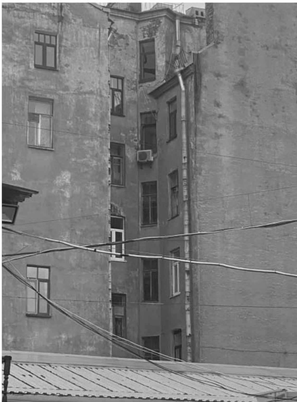
2. Вид на дворовой фасад выявленного объекта культурного наследия «Дом Р.Я.Шмерко», расположенного по адресу: г. Санкт-Петербург, Мичуринская улица, дом 21/11, литера А (Мичуринская ул., 21; Посадская Малая ул., 11); вид на окна квартиры №8;
